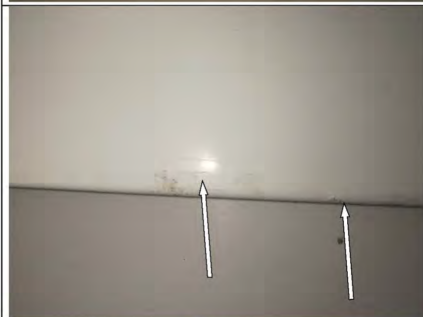
Фото №62. Потертости на профиле оконного блока ПВХ в гостиной.
