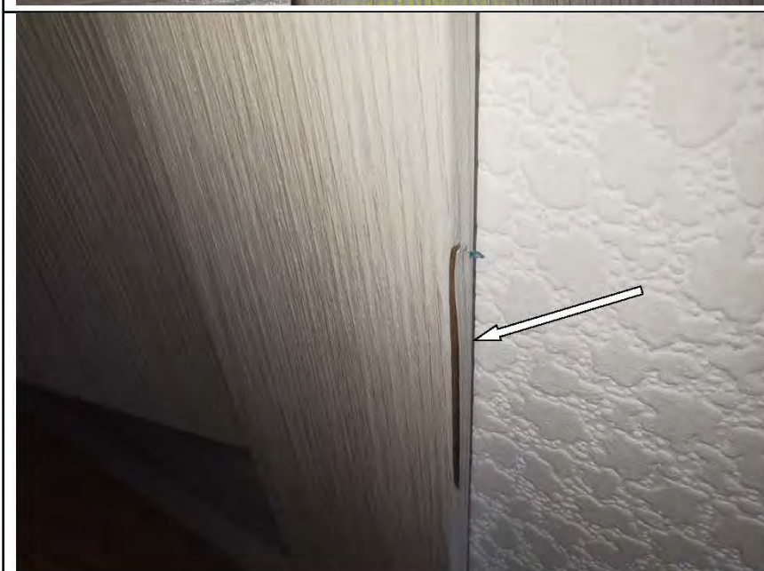
Фото №90. Отслоение ламинации наличников деревянного дверного блока в санузле.
