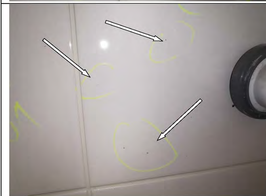
Фото №30. Окалины на настенной керамической плитке в санузле.
