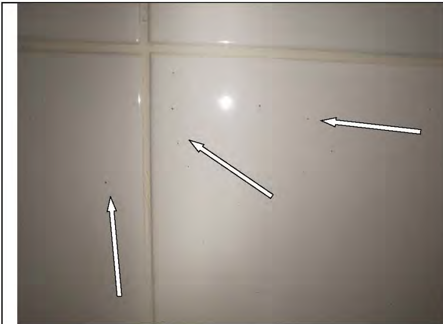
Фото №31. Окалины на настенной керамической плитке в санузле.
