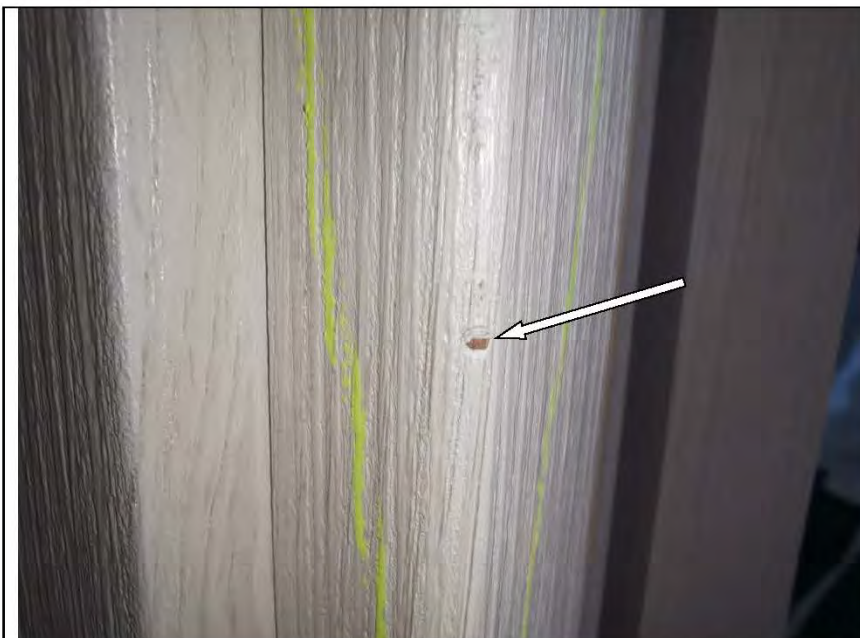
Фото №91. Скол на коробе деревянного дверного блока в ванной комнате.
