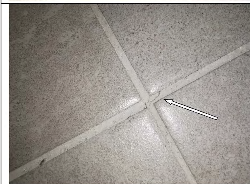
Фото №42. Затирка напольной плитки выполнена с нарушениями в санузле.
