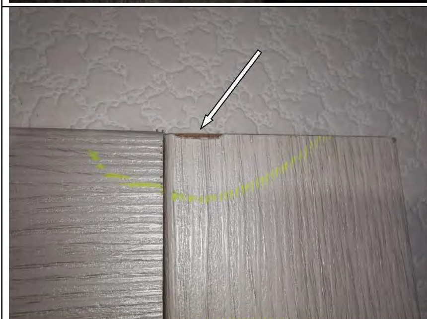
Фото №89. Повреждение ламинации наличников деревянного дверного блока в санузле.
