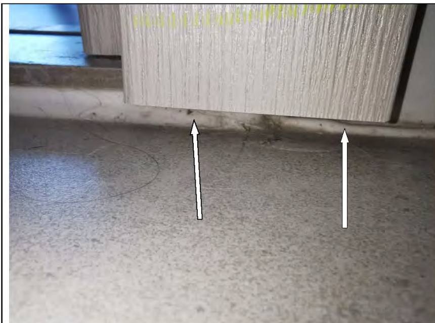
Фото №97. Коротко подрезаны наличники деревянного дверного блока в ванной комнате.
