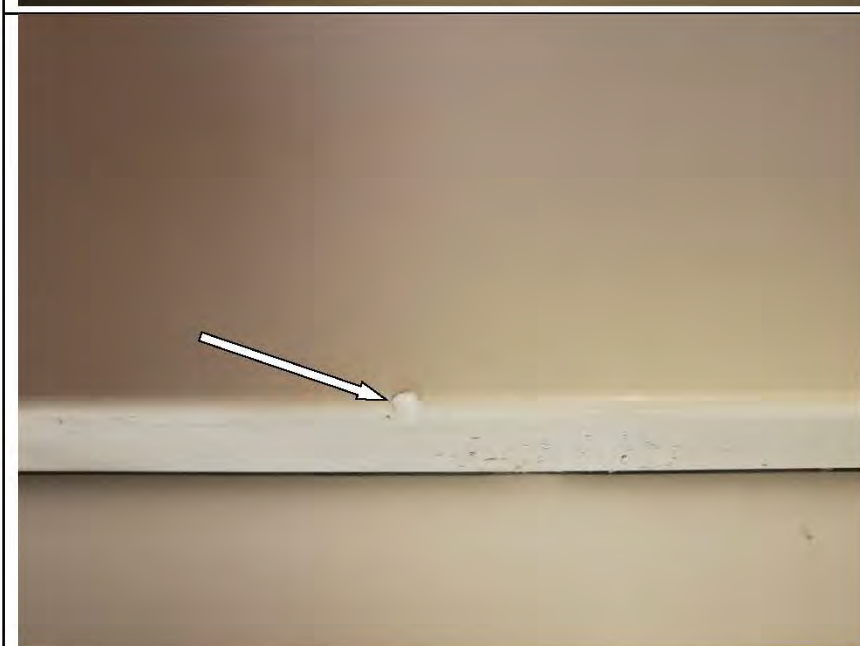
Фото №57. Скол на профиле оконного блока ПВХ в спальне.
