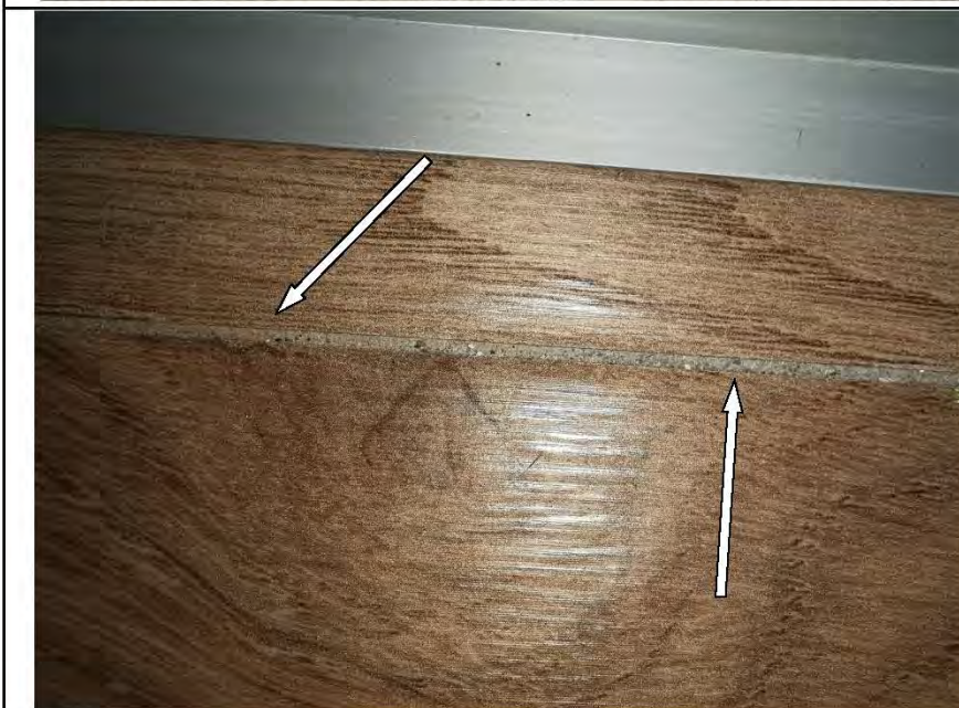
Фото №44. Зазор между соседними досками ламината в коридоре.
