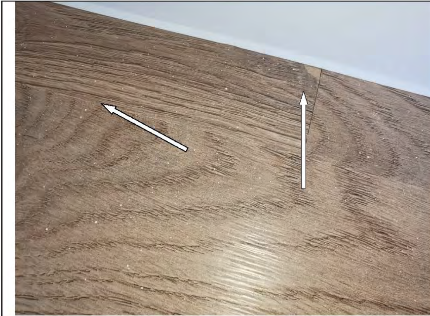
Фото №46. Загрязнение ламината в кухне.
