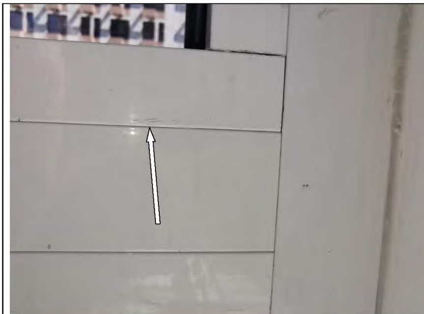
Фото №70. Потертости на профиле металлического оконного блока в гостиной.
