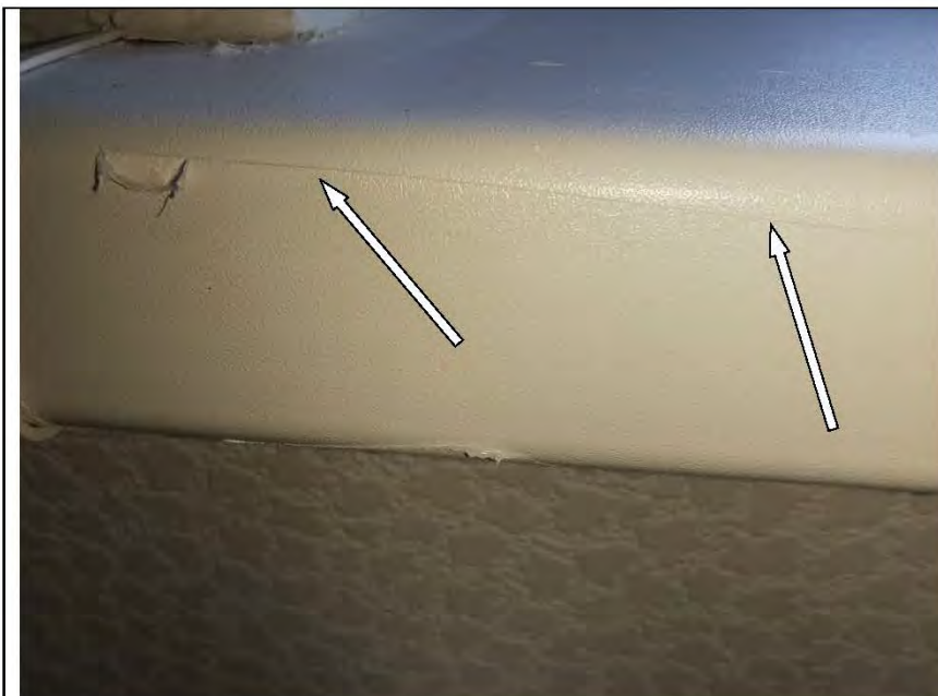
Фото №76. Царапины на лицевой стороне подоконной доски в кухне.
