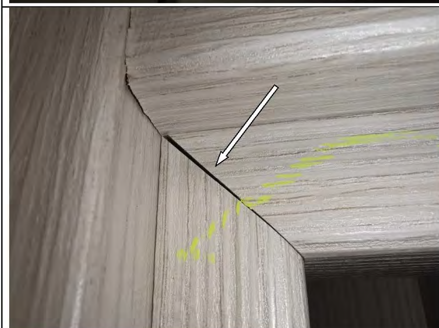
Фото №84. Элементы дверного блока соединены (коробка) не надежно в санузле.
