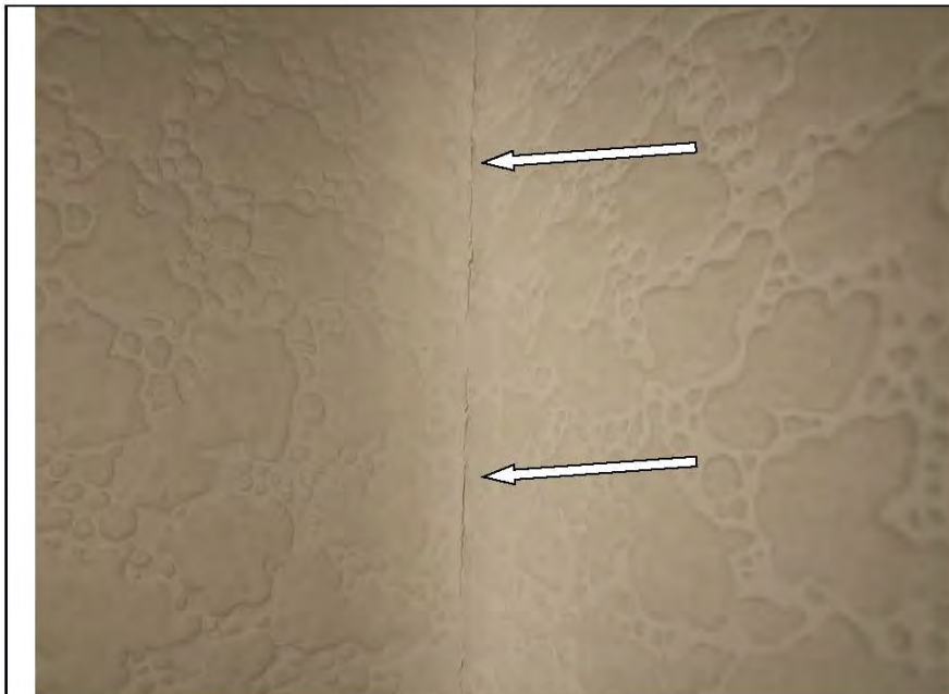
Фото №25. Читаемые обойные стыки в спальне.
