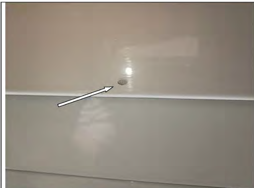
Фото №67. Повреждение профиля металлического оконного блока в гостиной.
