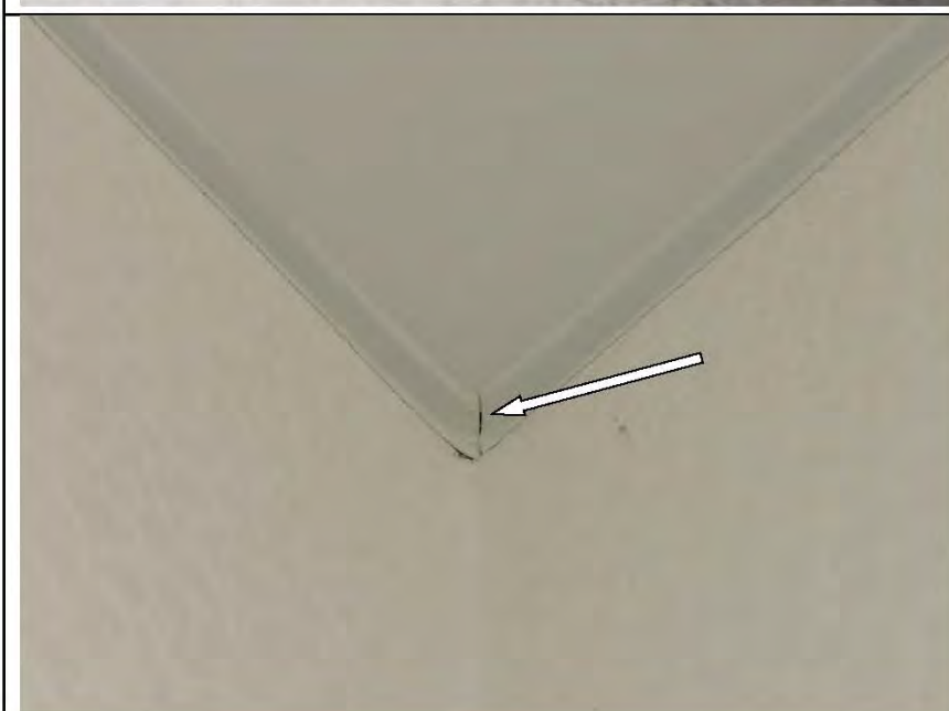
Фото №98. Дефект монтажа декоративного молдинга крепления натяжного потолка в коридоре.
