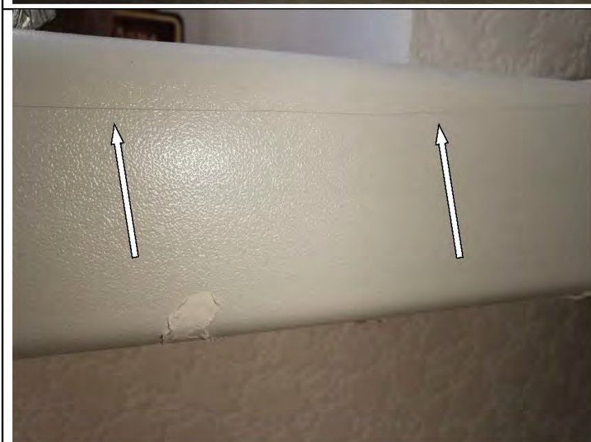
Фото №77. Царапины на лицевой стороне подоконной доски в спальне.
