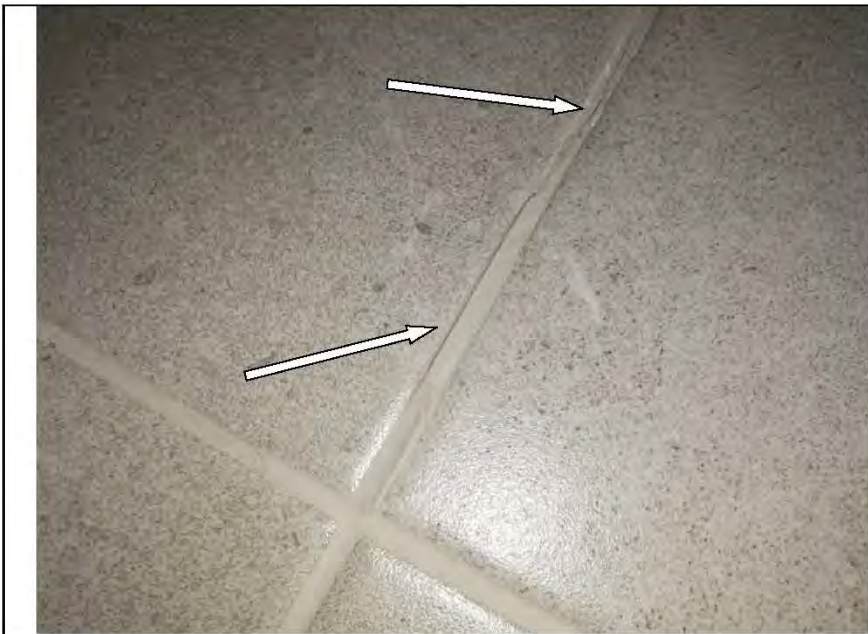
Фото №43. Затирка напольной плитки выполнена с нарушениями в ванной комнате.
