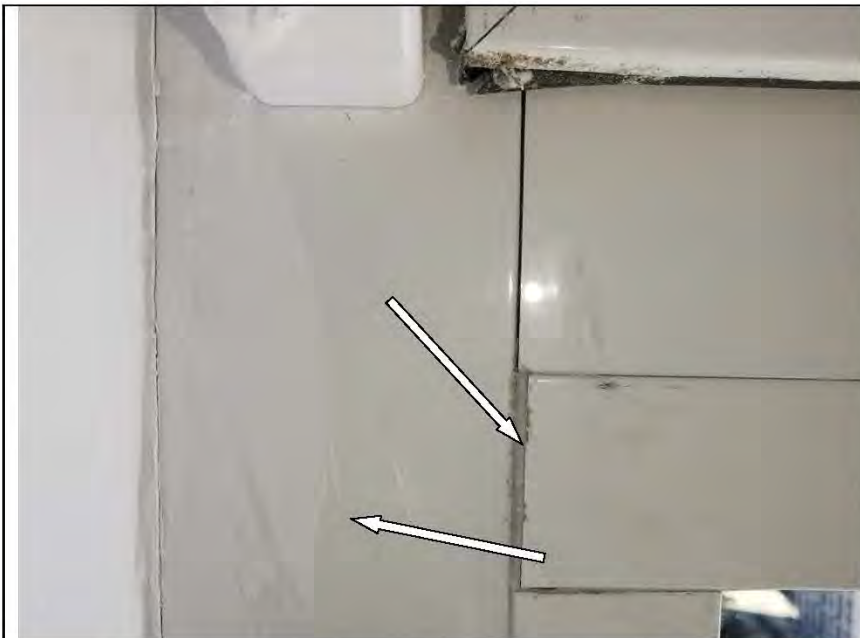
Фото №64. Загрязнение профиля металлического оконного блока, зазор в месте стыка профилей металлического оконного блока в гостиной.
