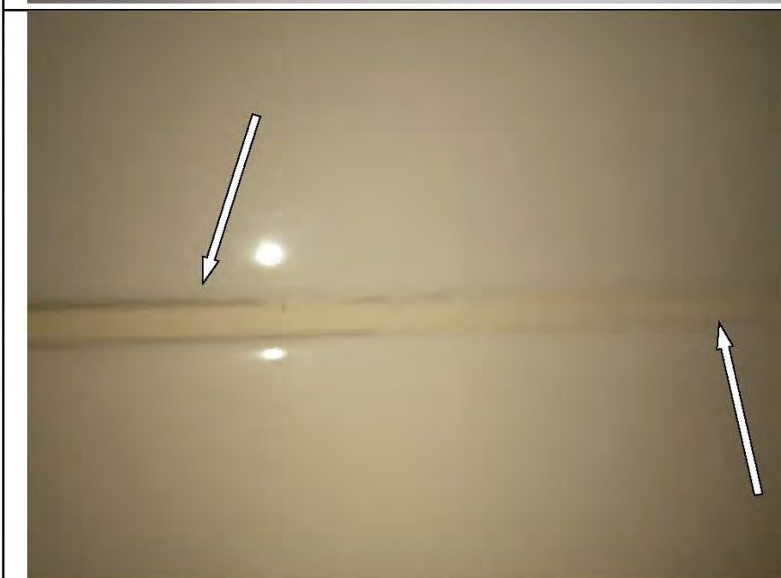
Фото №35. Затирка настенной плитки в ванной комнате выполнена с нарушениями.
