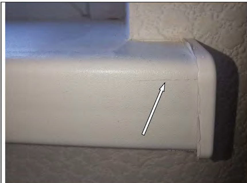
Фото №79. Царапины на лицевой стороне подоконной доски в гостиной.
