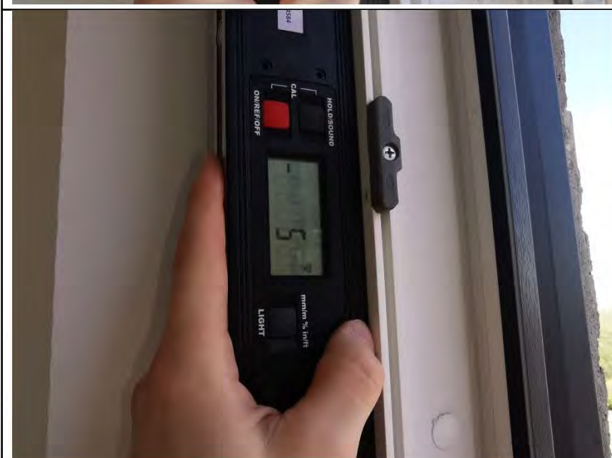
Фото №75. Отклонение оконного блока ПВХ по вертикали в гостиной.
