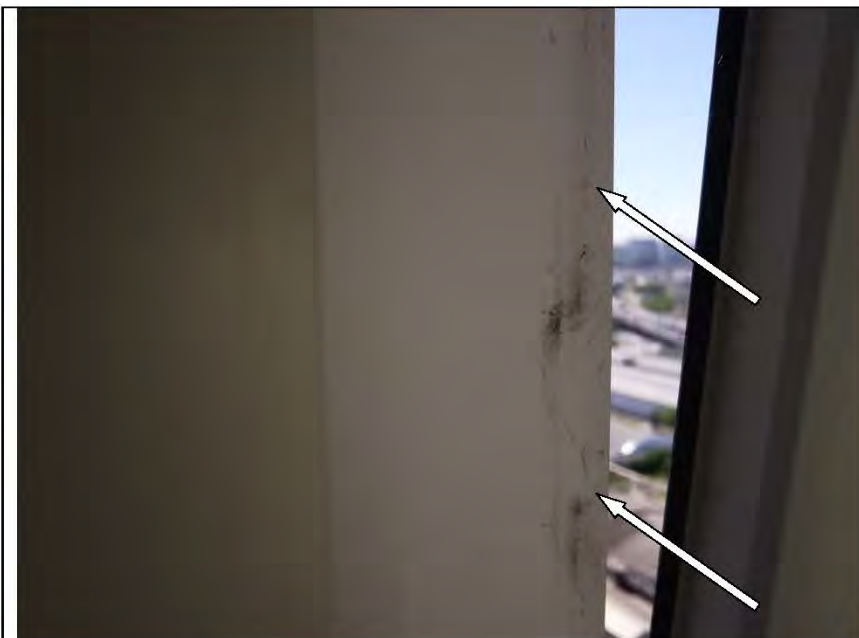
Фото №58. Потертости на профиле оконного блока ПВХ в спальне.
