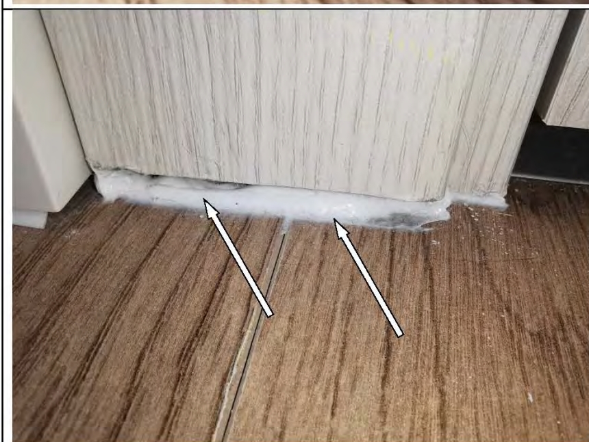
Фото №96. Коротко подрезаны наличники деревянного дверного блока в спальне.
