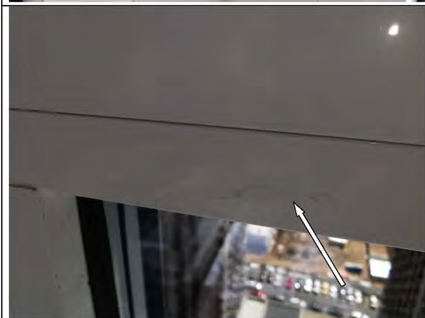
Фото №66. Загрязнение профиля металлического оконного блока в гостиной.
