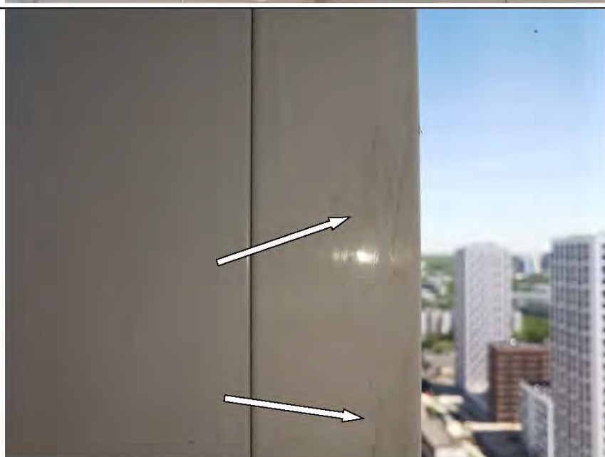
Фото №69. Потертости на профиле металлического оконного блока в гостиной.
