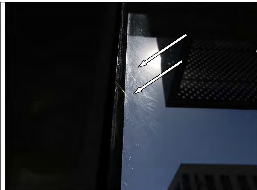
Фото №73. Царапины на стеклопакете оконного блока ПВХ в спальне.
