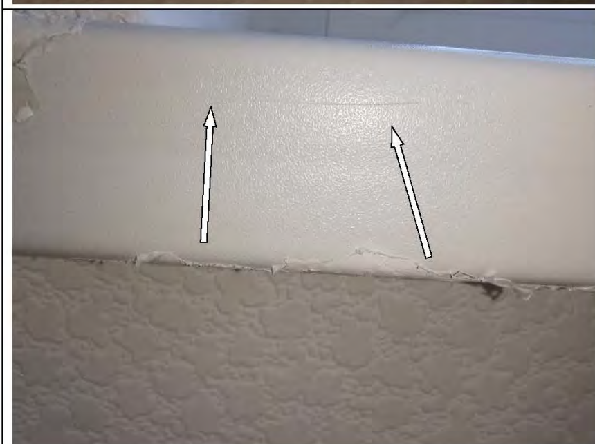
Фото №78. Царапины на лицевой стороне подоконной доски в гостиной.
