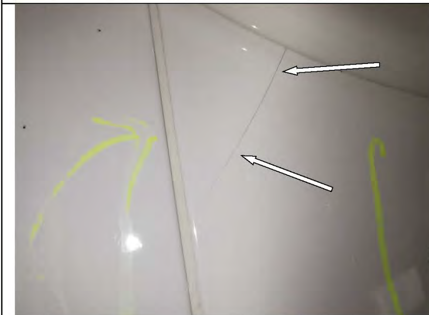
Фото №29. Трещины на настенной керамической плитке в санузле.
