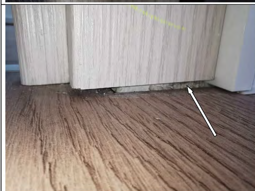
Фото №95. Коротко подрезаны наличники деревянного дверного блока в гостиной.
