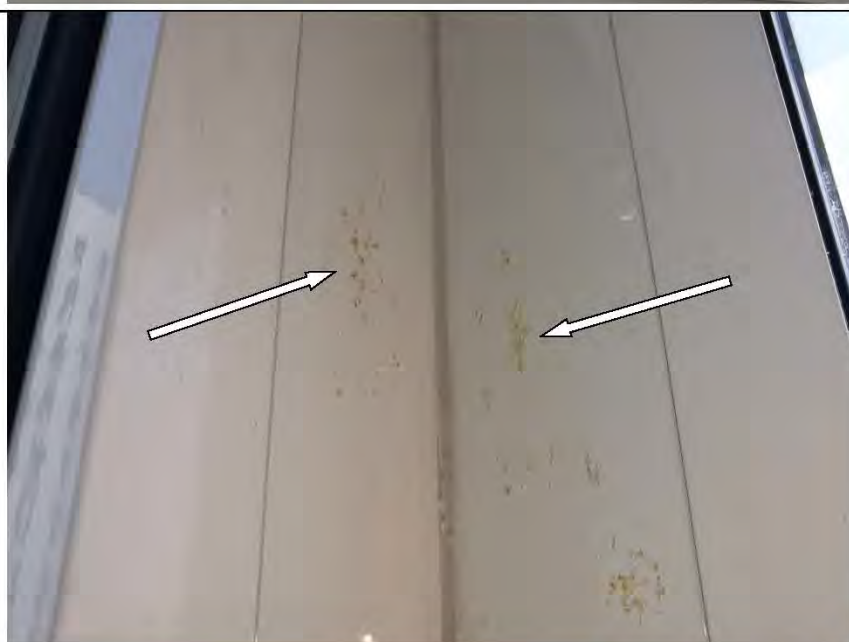
Фото №68. Загрязнение профиля металлического оконного блока в гостиной.
