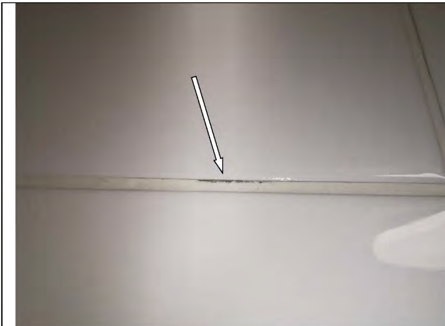
Фото №34. Затирка настенной плитки в санузле выполнена с нарушениями.
