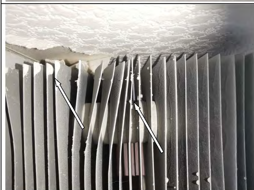
Фото №101. Радиатор в кухне имеет дефекты (замятия).
