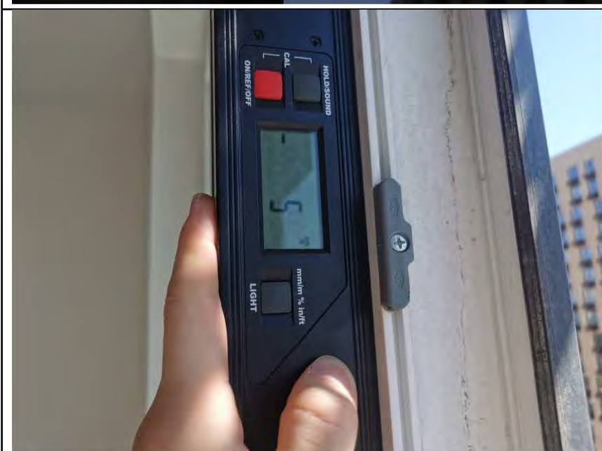
Фото №74. Отклонение оконного блока ПВХ по вертикали в спальне.
