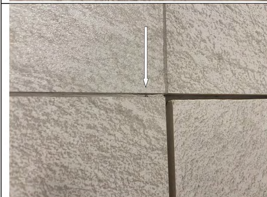
Фото №14. Неровные швы на настенной керамической плитке в ванной комнате.
