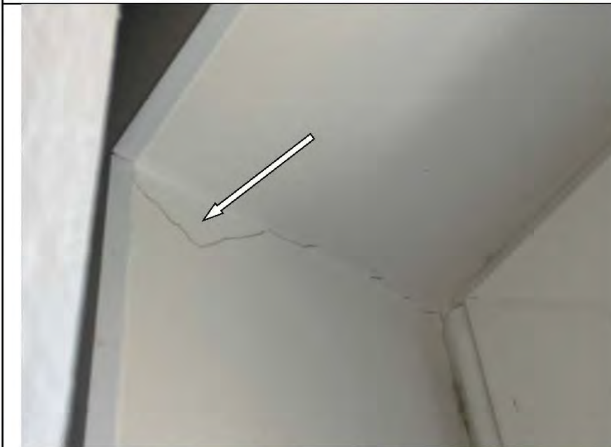
Фото №44. Неровности, выбоины, раковины на окрашенных откосах оконного блока в кухне.
