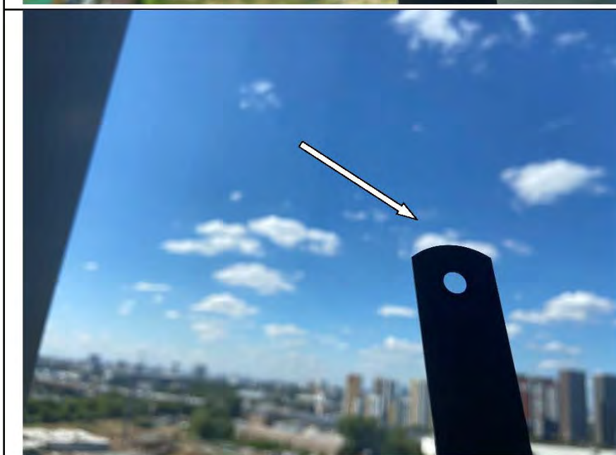
Фото №42. Царапина на стеклопакете оконного блока ПВХ в кухне.
