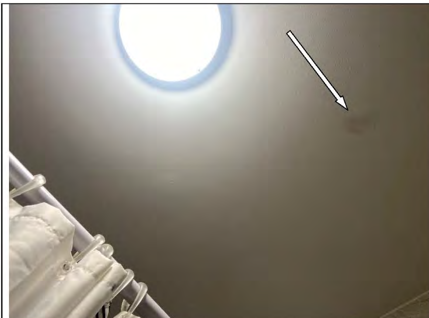
Фото №67. Неровности, подтеки на поверхности окрашенного потолка в ванной комнате.
