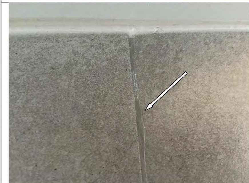
Фото №26. Неровные швы напольной керамической плитки кухне.
