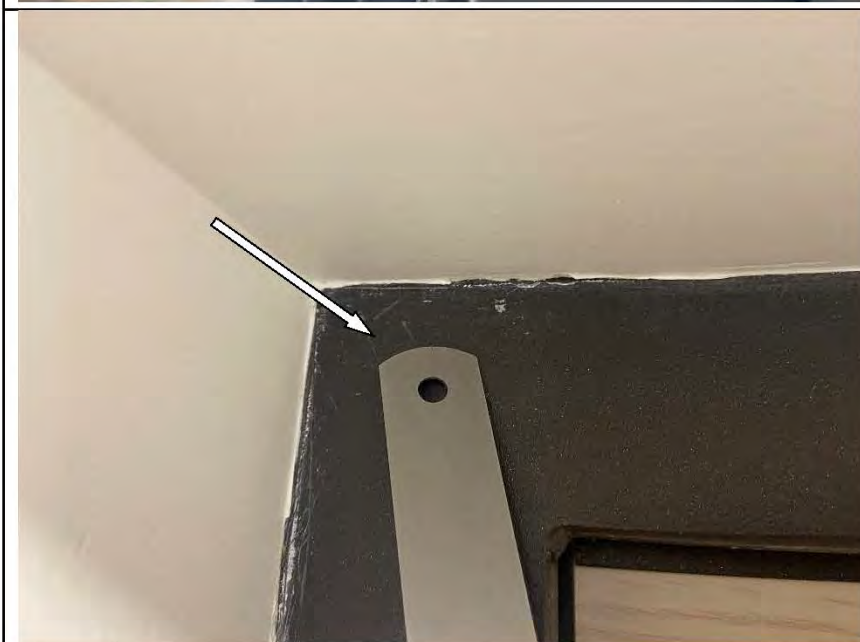
Фото №51. Дефект на коробке входного дверного блока в коридоре.
