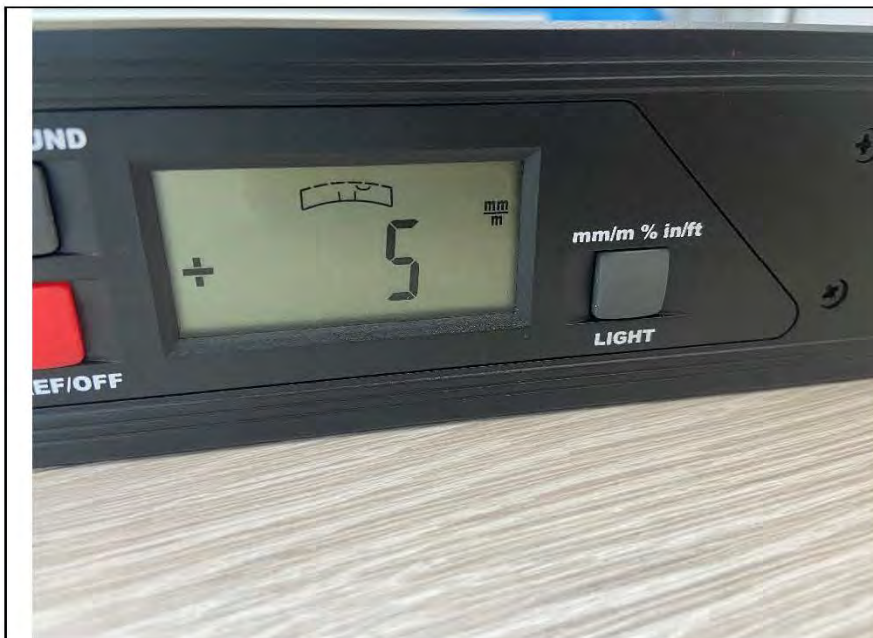
Фото №16. Отклонения поверхности напольного покрытия из ламината в зимнем саду.
