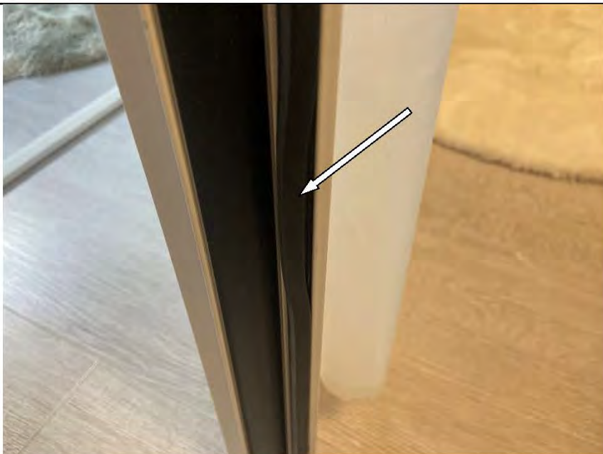
Фото №47. Дефект на уплотнительной ленте оконного блока в спальне.
