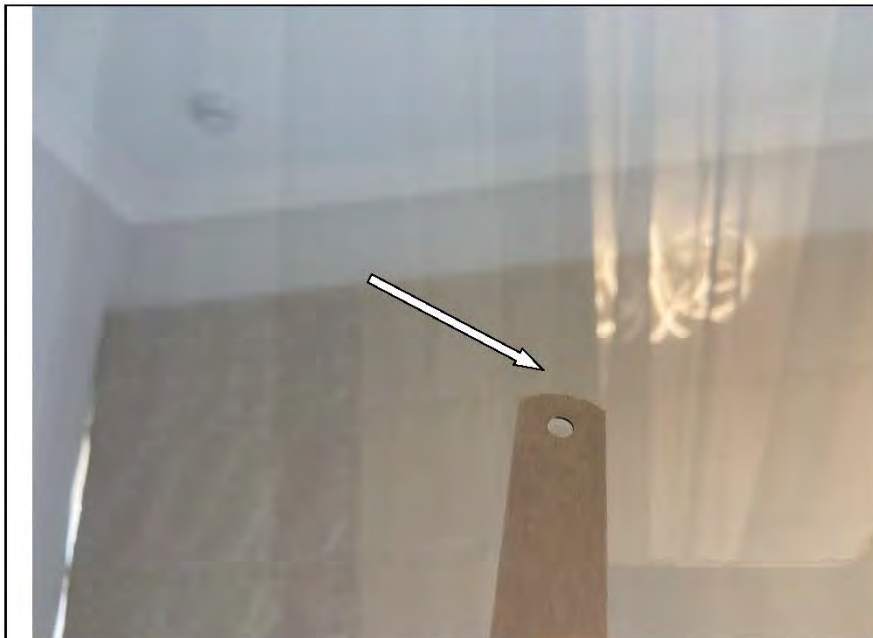
Фото №40. Царапина на стеклопакете оконного блока ПВХ в спальне.
