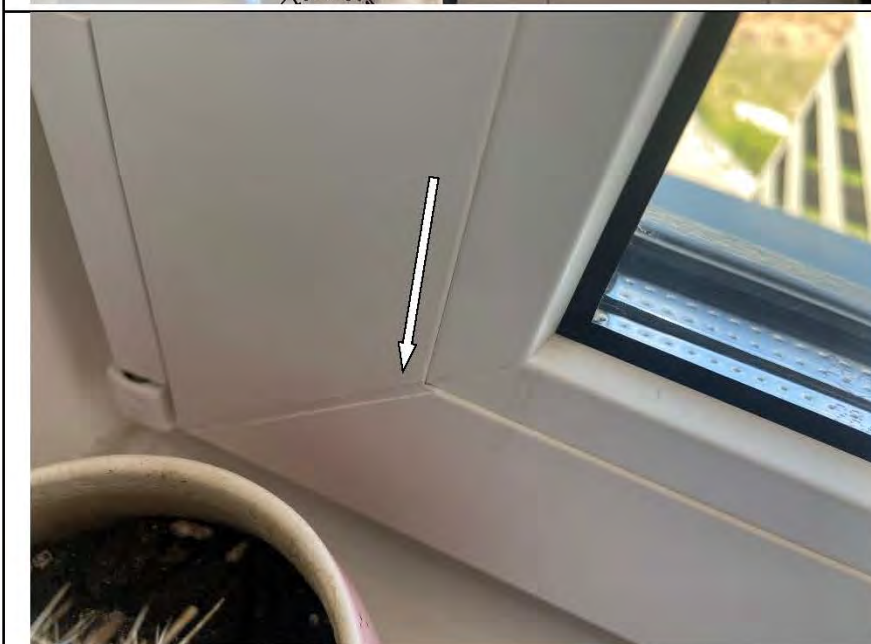
Фото №39. Загрязнения на профиле оконного блока ПВХ в кухне.
