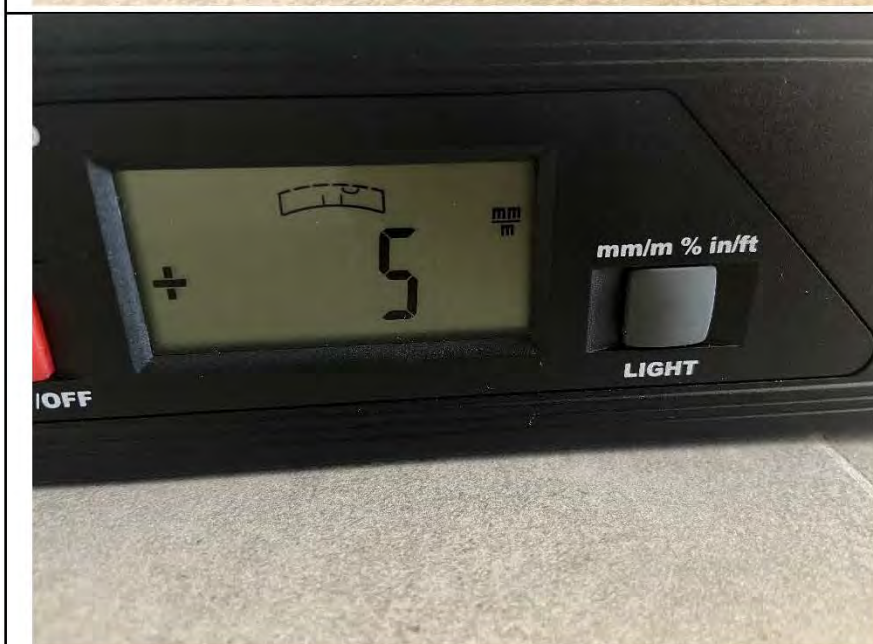
Фото №20. Отклонения поверхности напольного покрытия из керамической плитки в кухне.
