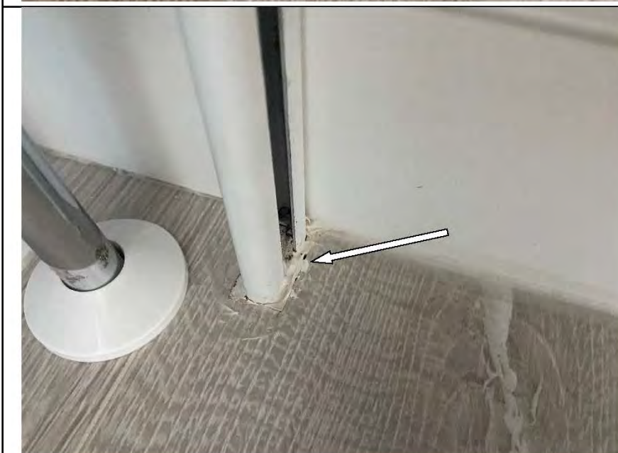
Фото №33. Дефект на поверхности напольного покрытия из ламината в зимнем саду.
