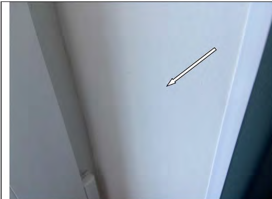
Фото №43. Неровности, выбоины, раковины на окрашенных откосах оконного блока в зимнем саду.
