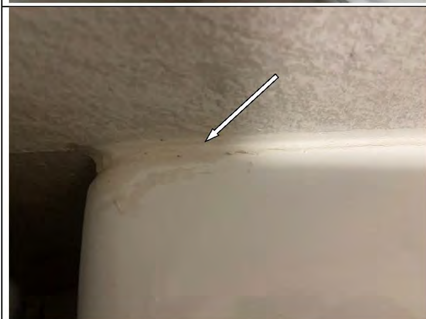
Фото №71. Дефект на ванне в ванной комнате.
