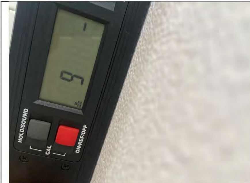
Фото №10. Отклонения поверхности стен от вертикали в зимнем саду.
