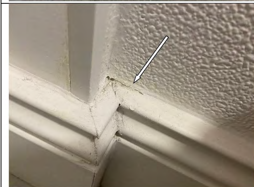
Фото №27. Дефект на напольном деревянном плинтусе в коридоре.
