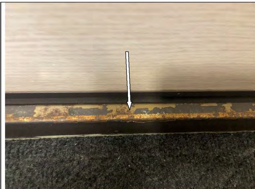
Фото №52. Дефект на коробке входного дверного блока в коридоре.
