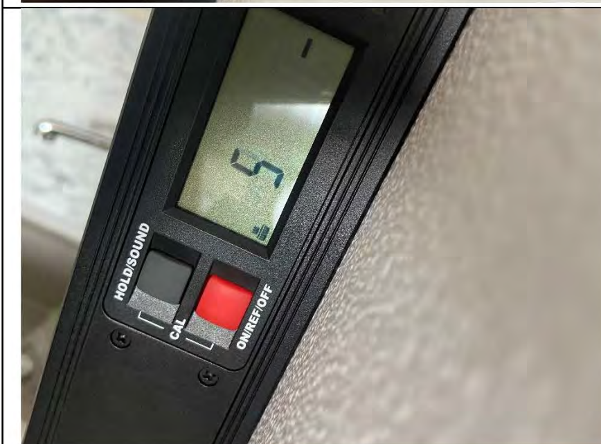
Фото №11. Отклонения поверхности стен от вертикали в кухне.
