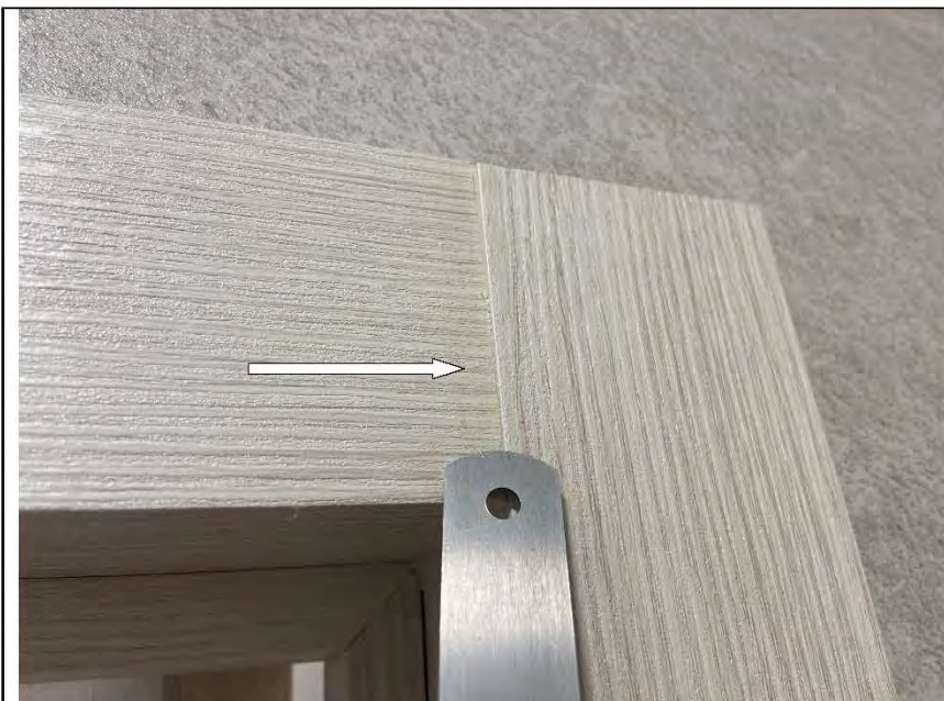
Фото №58. Дефект на наличниках входного дверного блока в ванной комнате.
