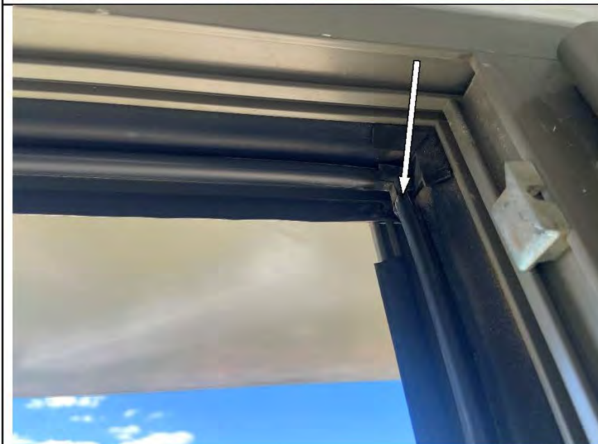
Фото №48. Дефект на уплотнительной ленте оконного блока в зимнем саду.
