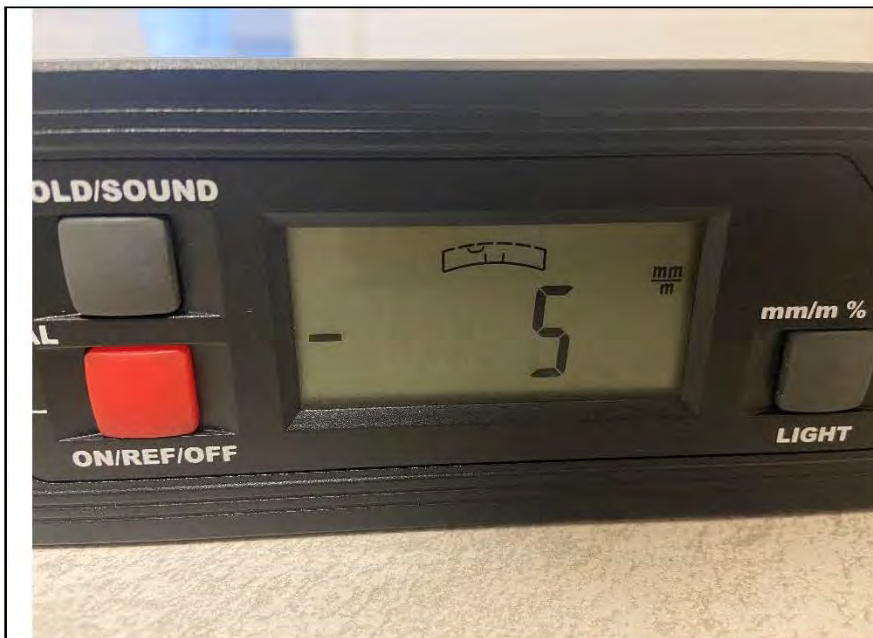
Фото №19. Отклонения поверхности напольного покрытия из керамической плитки в ванной комнате.
