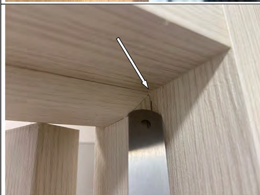
Фото №60. Дефект на коробке деревянного дверного блока в ванной комнате.
