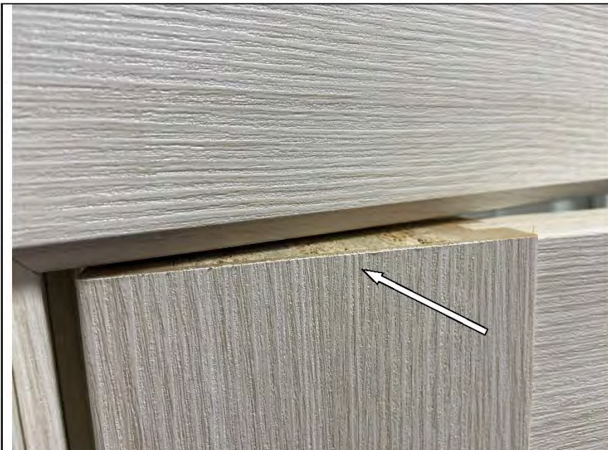
Фото №55. Дефект на полотне деревянного дверного блока в ванной комнате.
