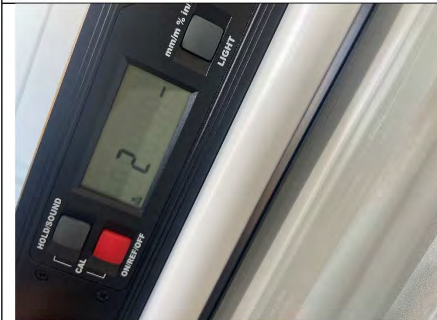
Фото №45. Отклонения по вертикали оконного блока ПВХ в спальне.
