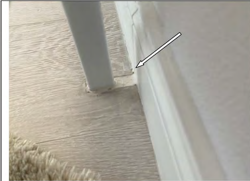
Фото №34. Дефект на поверхности напольного покрытия из ламината в зимнем саду.
