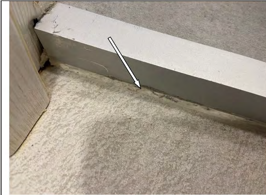
Фото №22. Загрязнения на напольной керамической плитке в ванной комнате.
