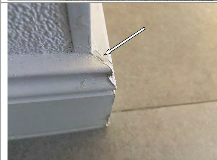
Фото №30. Дефект на напольном деревянном плинтусе в кухне.
