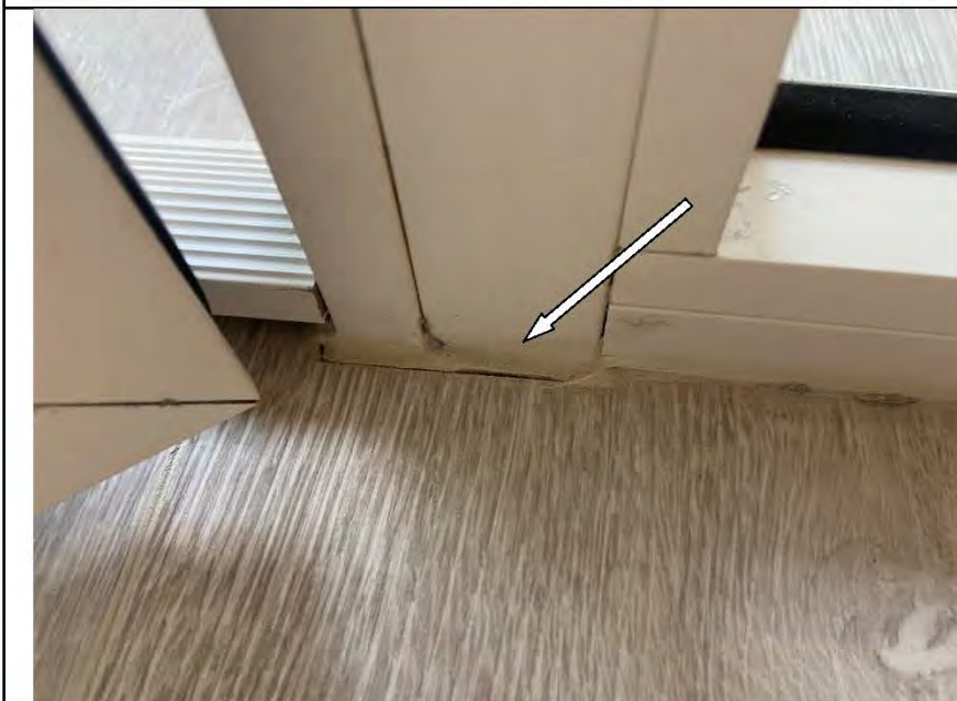
Фото №32. Дефект на поверхности напольного покрытия из ламината в спальне.
