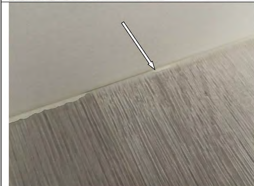
Фото №35. Дефект на поверхности напольного покрытия из ламината в кухне.
