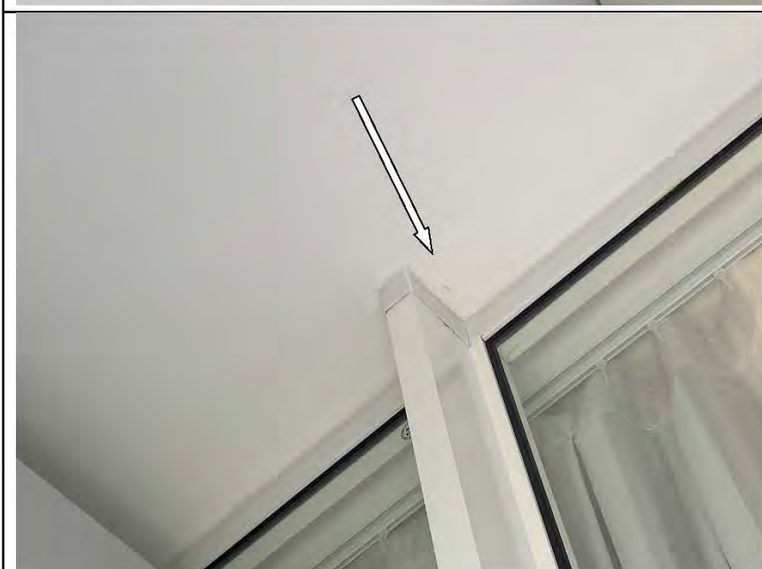
Фото №66. Неровности, подтеки на поверхности окрашенного потолка в зимнем саду.
