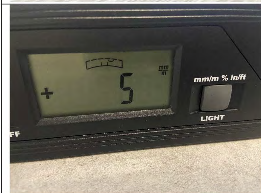
Фото №18. Отклонения поверхности напольного покрытия из керамической плитки в коридоре.
