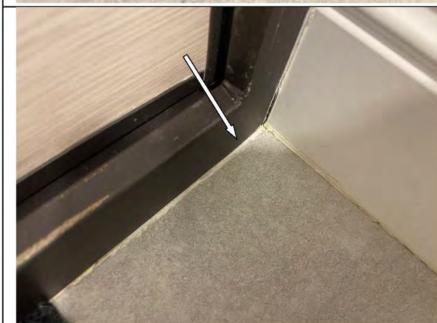
Фото №21. Загрязнения на напольной керамической плитке в коридоре.
