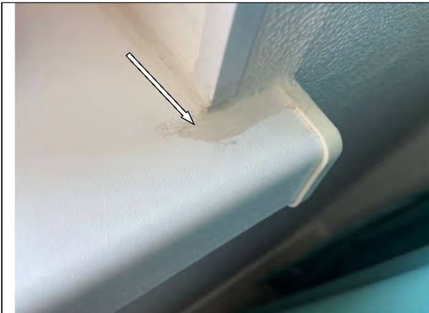
Фото №37. Дефект на лицевой стороне подоконной доски в кухне.
