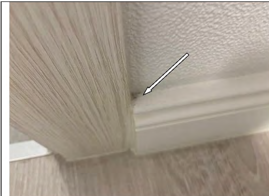
Фото №28. Дефект на напольном деревянном плинтусе в спальне.
