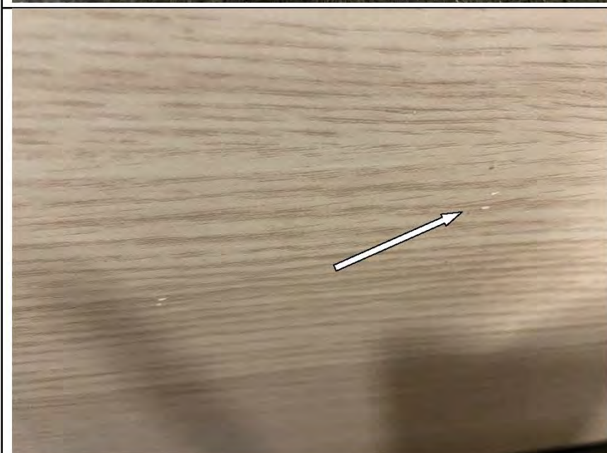
Фото №53. Дефект на полотне входного дверного блока в коридоре.
