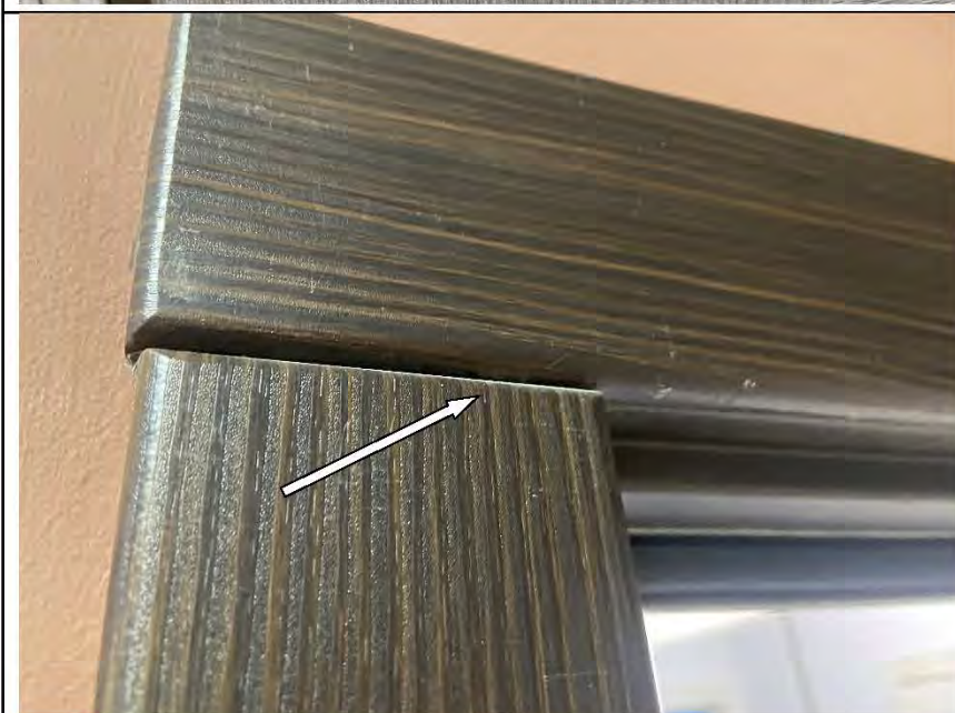
Фото №56. Дефект на наличниках входного дверного блока в коридоре.
