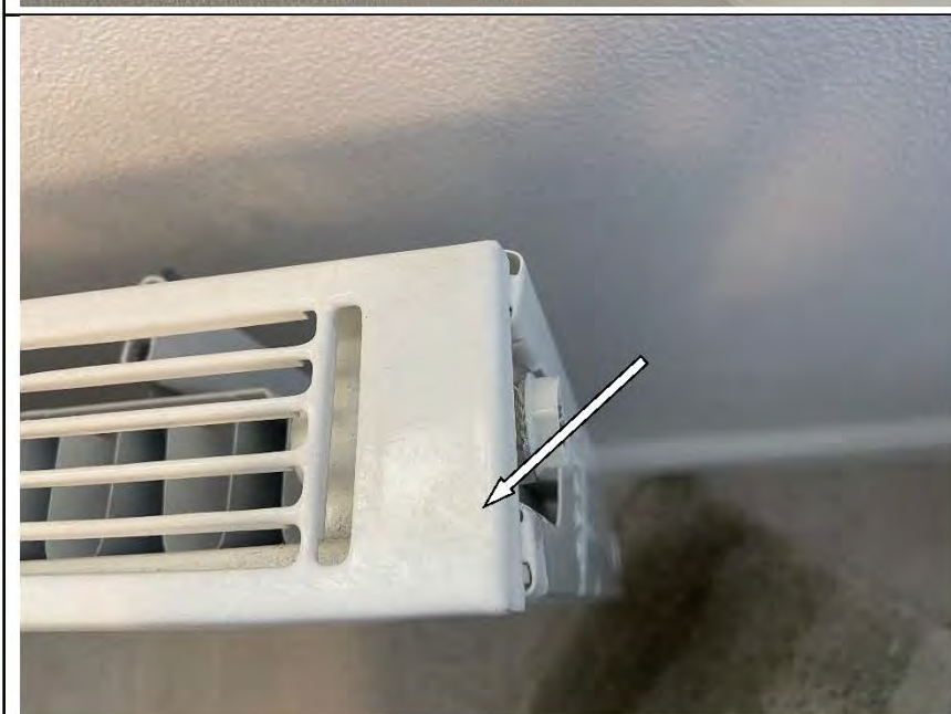
Фото №69. Дефект на металлическом кожухе отопительного прибора в зимнем саду.
