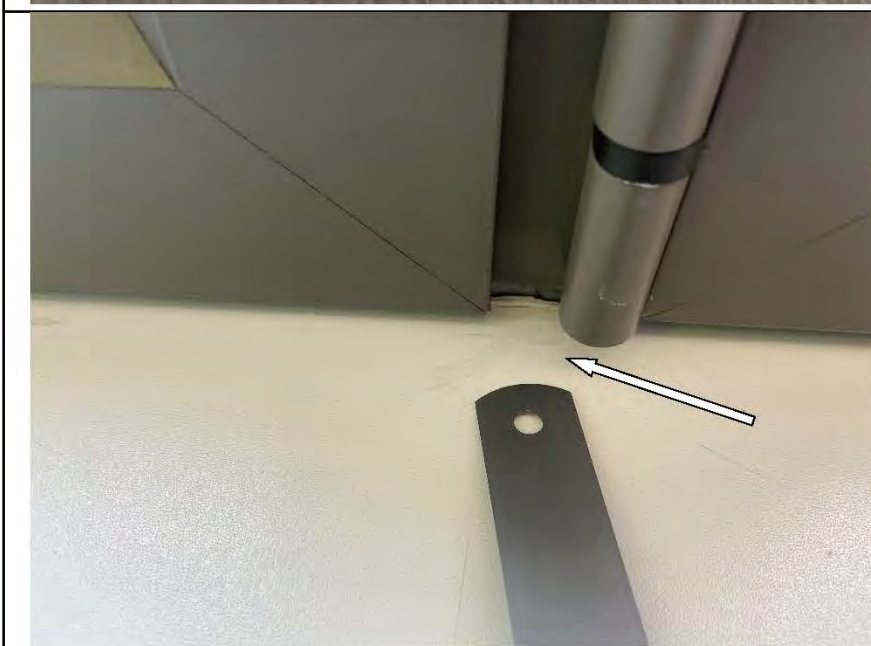
Фото №36. Дефект на лицевой стороне подоконной доски в зимнем саду.
