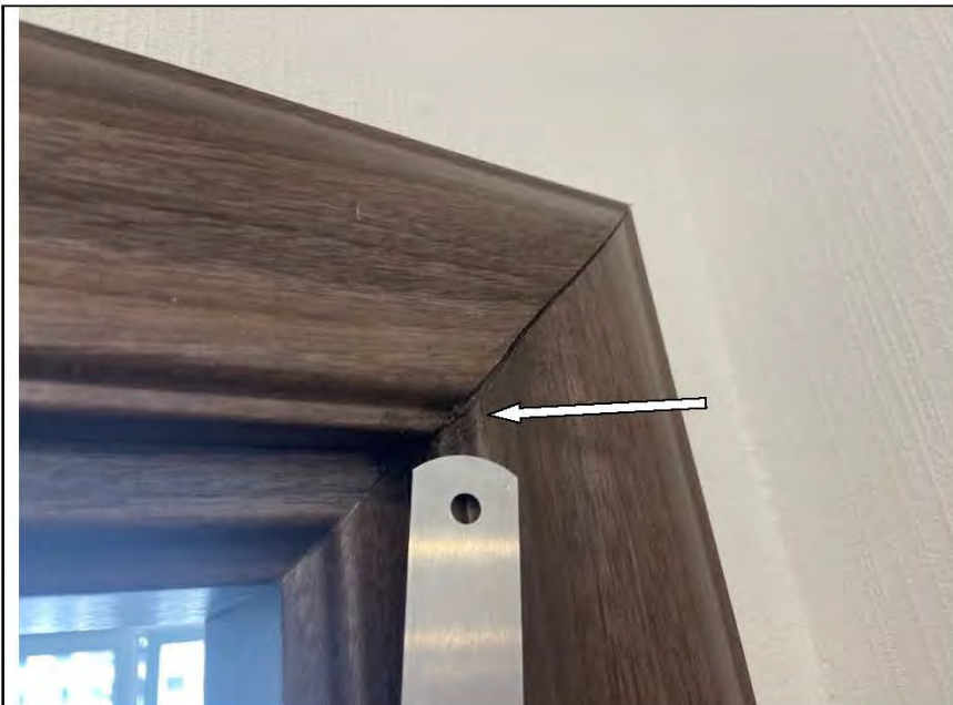
Фото №100. Дефекты на наличниках деревянного дверного блока в спальне.
