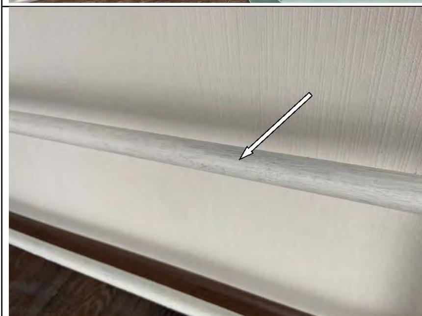
Фото №83. Неровности, подтеки на окрашенных трубах отопления в кабинете.
