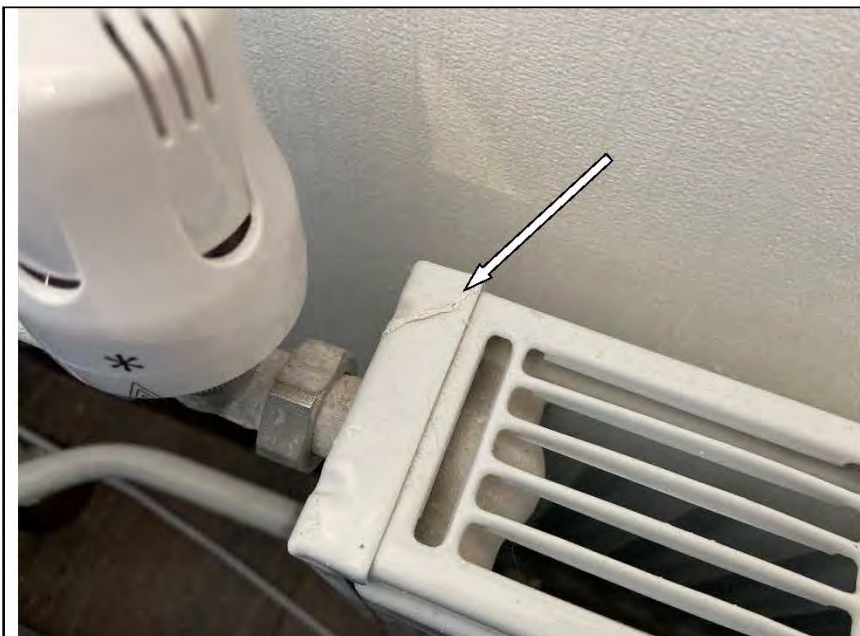
Фото №118. Загрязнения на металлическом кожухе отопительного прибора в кухне.
