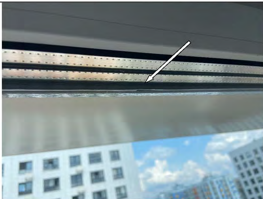
Фото №75. Дефект на уплотнительной ленте оконного блока ПВХ в детской.
