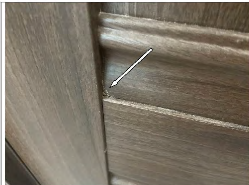
Фото №88. Дефекты на полотне деревянного дверного блока в ванной комнате.
