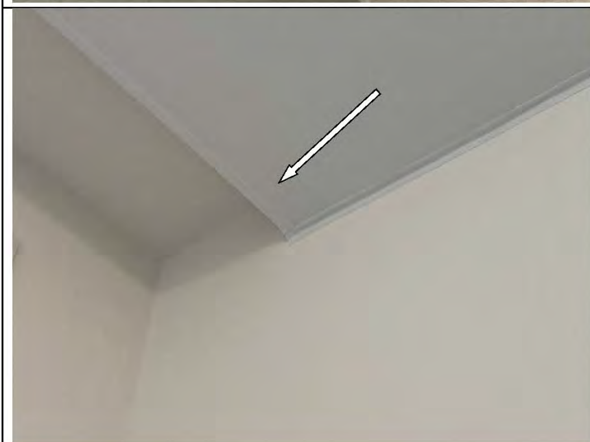
Фото №113. Дефекты на поверхности натяжного потолка в кухне.
