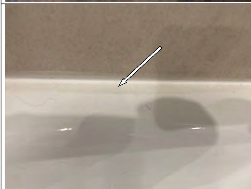
Фото №122. Загрязнения на ванне в ванной комнате.
