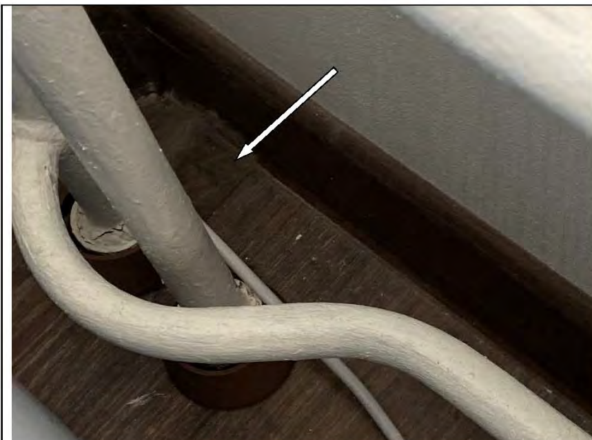
Фото №52. Дефект вставки труб отопления в напольное покрытие из ламината в кухне.
