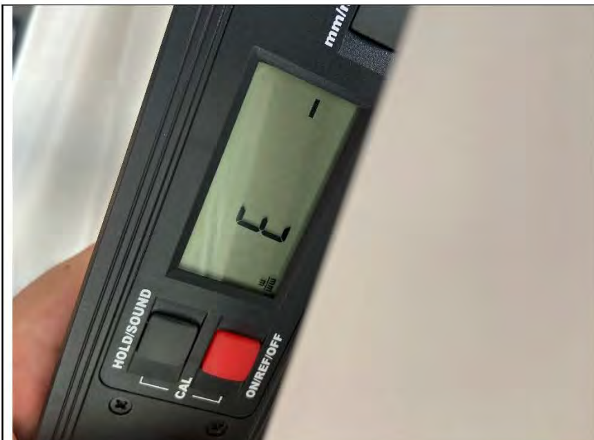
Фото №73. Отклонения от вертикали оконного блока ПВХ в спальне.
