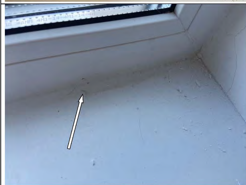
Фото №54. Дефект на лицевой стороне подоконной доски в детской.
