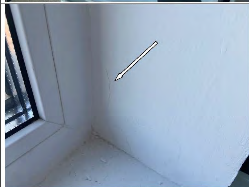
Фото №66. Неровности, выбоины, сколы на окрашенных откосах оконного блока ПВХ в детской.
