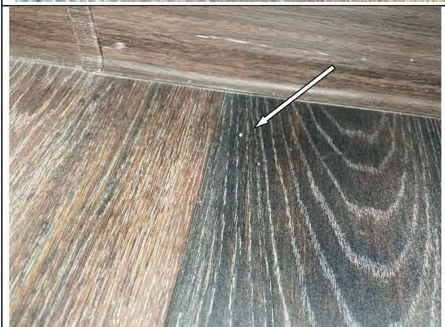
Фото №47. Дефект на напольном покрытии из ламината в кабинете.
