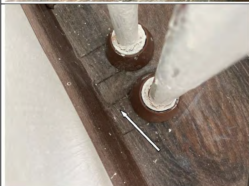
Фото №51. Дефект вставки труб отопления в напольное покрытие из ламината в детской.
