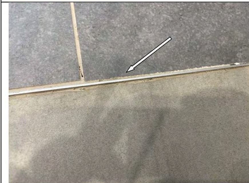
Фото №35. Загрязнения на напольной керамической плитке в санузле.
