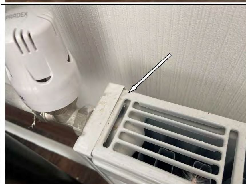
Фото №120. Загрязнения на металлическом кожухе отопительного прибора в кабинете.
