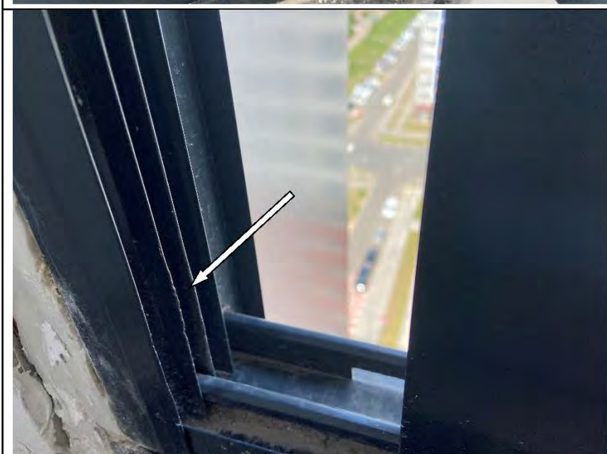
Фото №80. Дефект на металлическом профиле оконного блока на лоджии.
