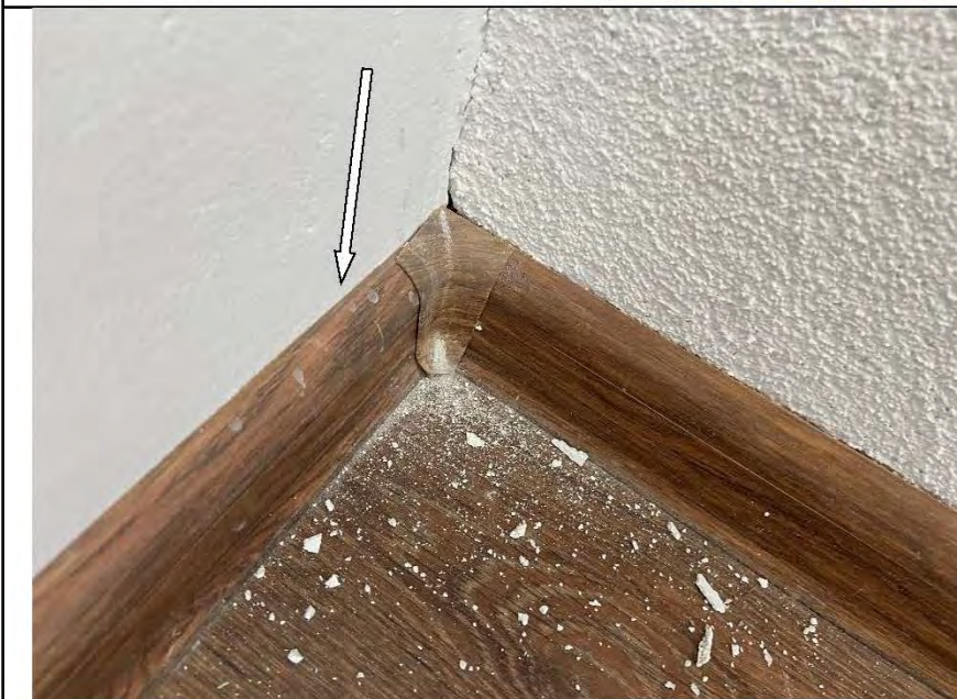
Фото №42. Дефект на напольном плинтусе ПВХ на лоджии.
