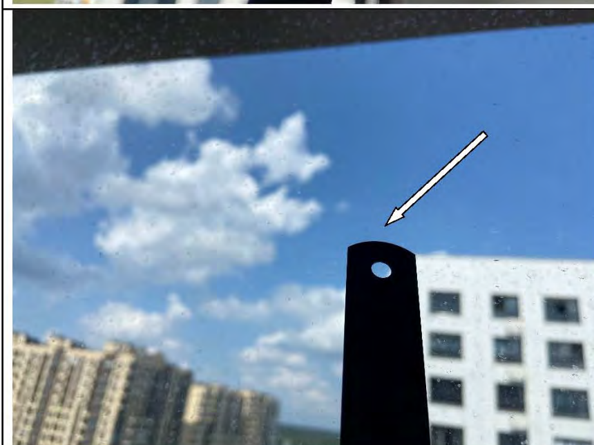
Фото №62. Царапина на стеклопакете оконного блока ПВХ на лоджии.
