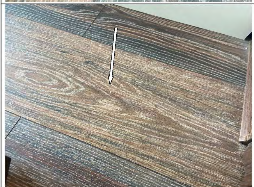
Фото №48. Дефект на напольном покрытии из ламината в спальне.
