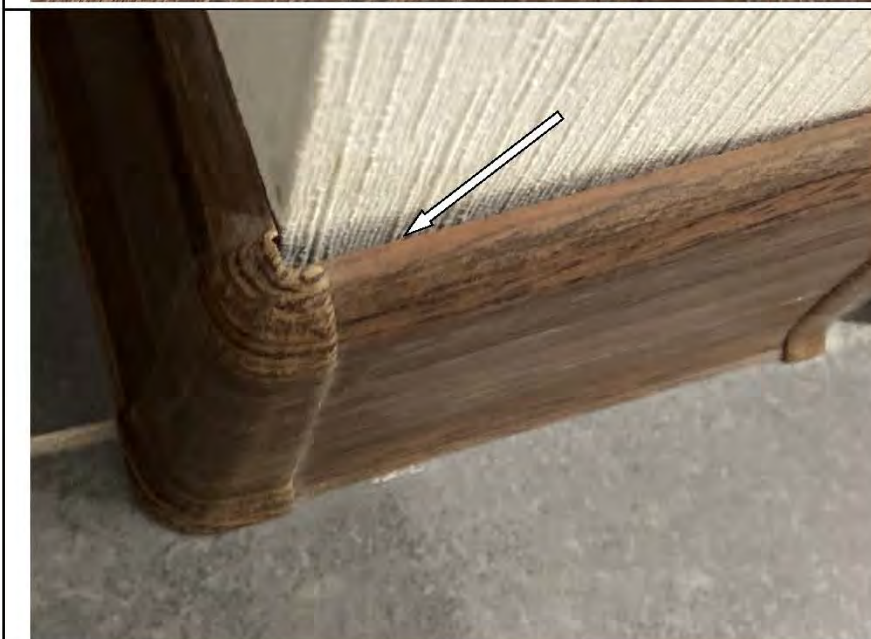
Фото №45. Дефект на напольном плинтусе ПВХ в гардеробной.
