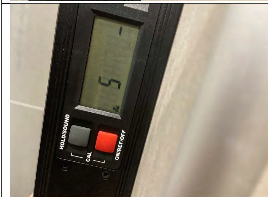
Фото №17. Отклонения поверхности стен от вертикали в ванной комнате.
