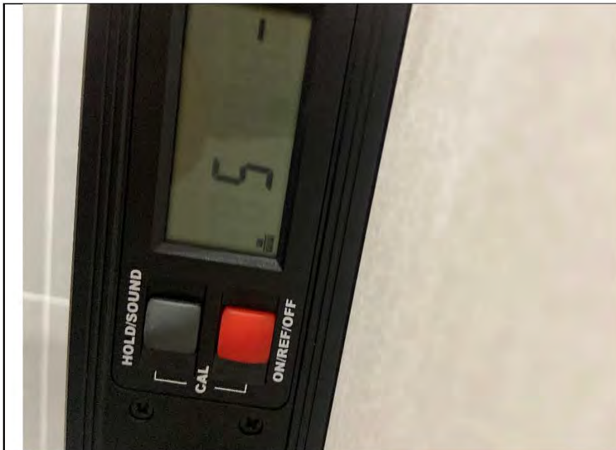
Фото №16. Отклонения поверхности стен от вертикали в санузле.
