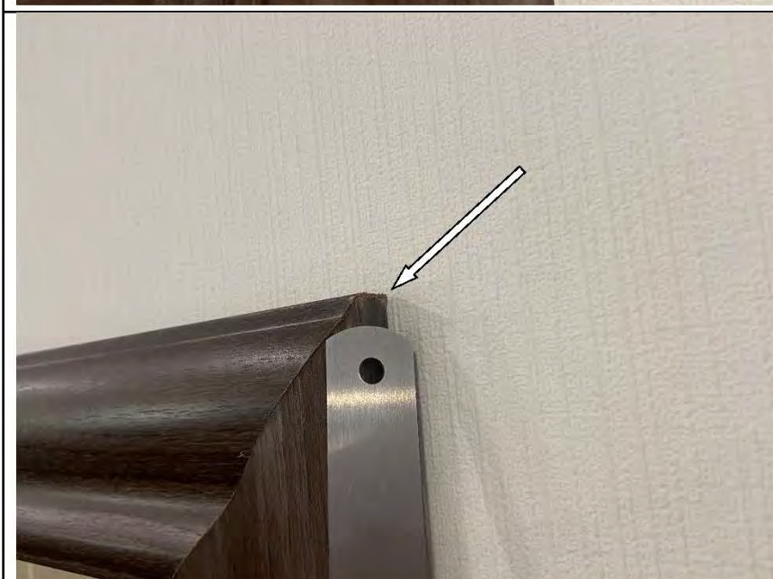
Фото №95. Дефекты на наличниках деревянного дверного блока в ванной комнате.
