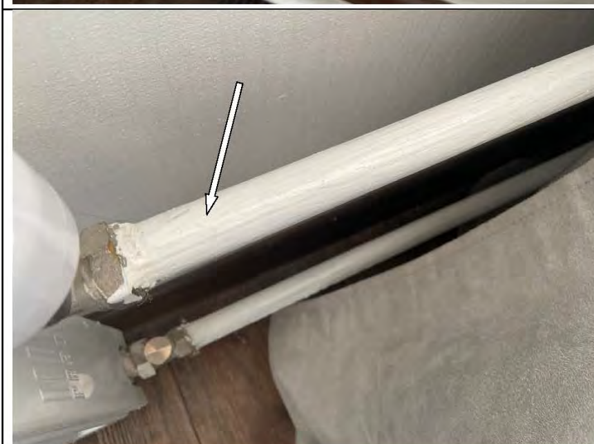
Фото №84. Неровности, подтеки на окрашенных трубах отопления в спальне.
