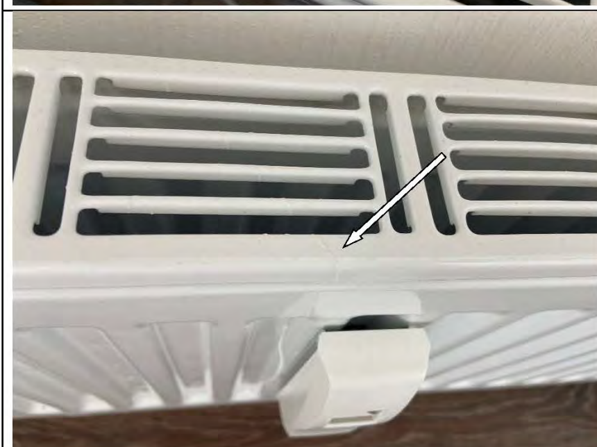
Фото №119. Загрязнения на металлическом кожухе отопительного прибора в детской.
