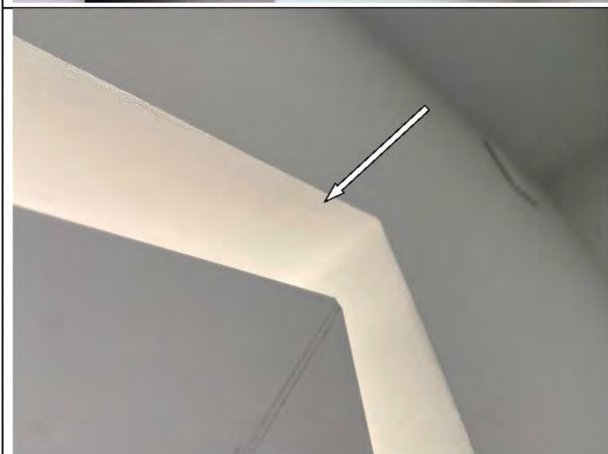
Фото №68. Неровности, выбоины, сколы на окрашенных откосах оконного блока ПВХ в кабинете.
