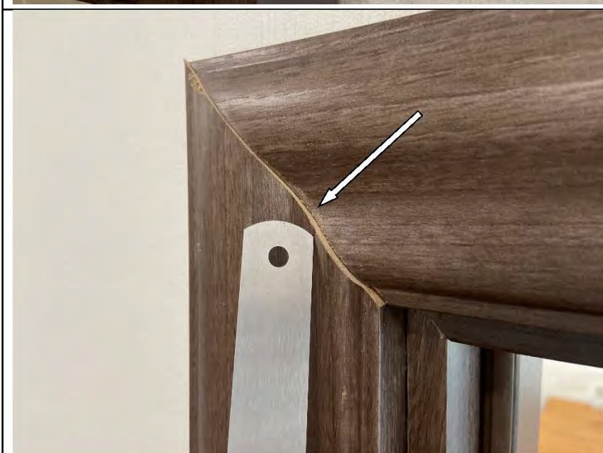
Фото №96. Дефекты на наличниках деревянного дверного блока в кухне.
