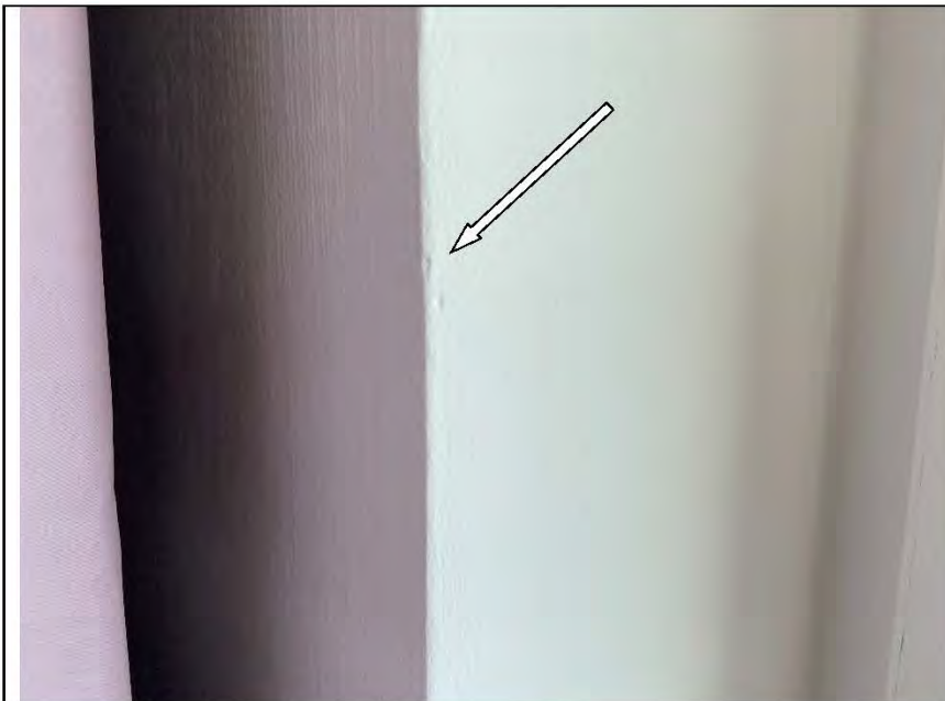
Фото №67. Неровности, выбоины, сколы на окрашенных откосах оконного блока ПВХ в кухне.
