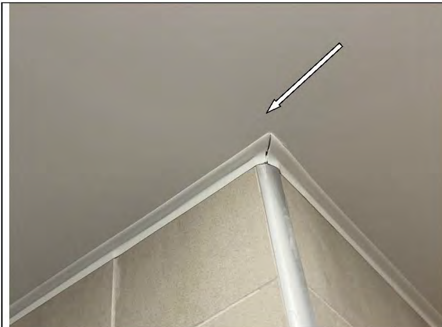
Фото №115. Дефекты на поверхности натяжного потолка в санузле.
