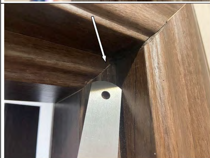
Фото №102. Дефекты на коробке деревянного дверного блока в ванной комнате.
