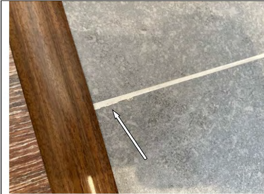
Фото №34. Загрязнения на напольной керамической плитке в кухне.
