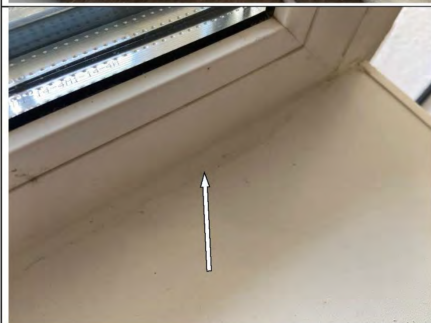
Фото №53. Дефект на лицевой стороне подоконной доски в кухне.
