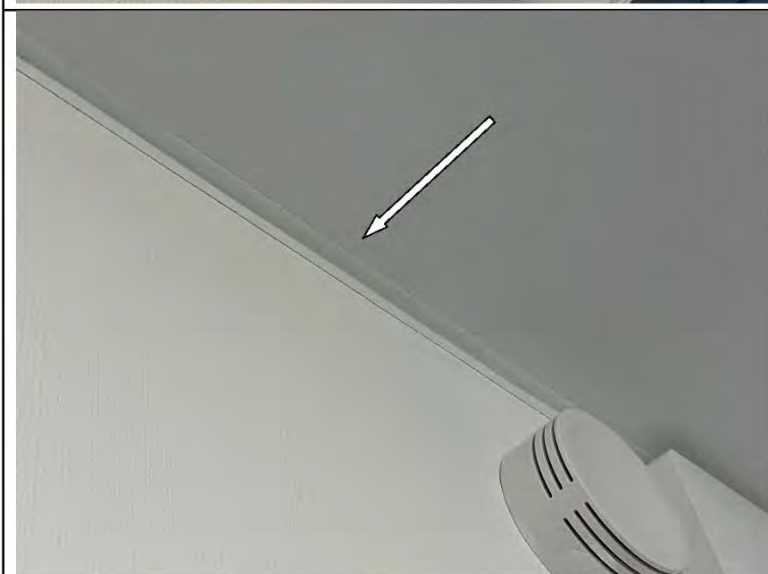
Фото №110. Дефекты на поверхности натяжного потолка в коридоре.
