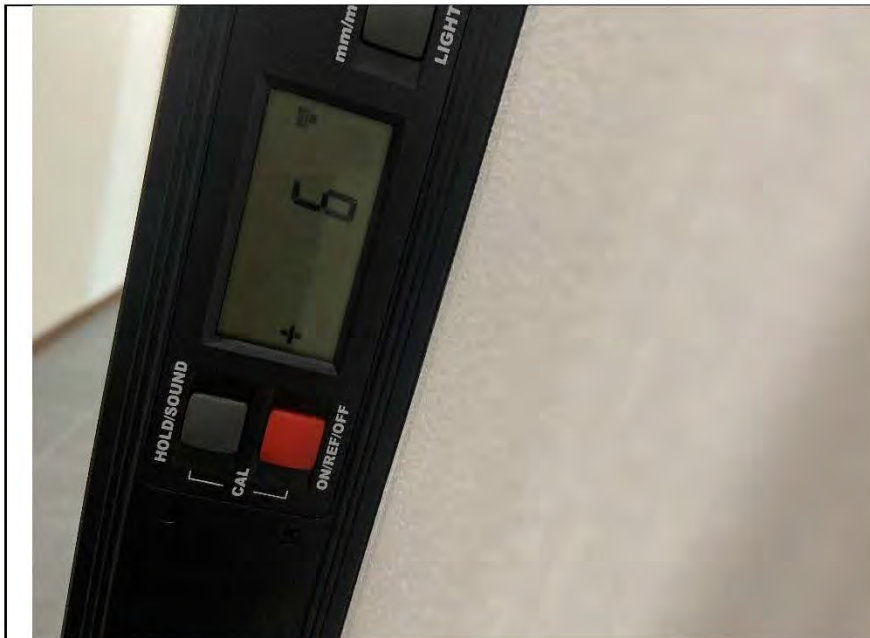
Фото №10. Отклонения поверхности стен от вертикали в коридоре.
