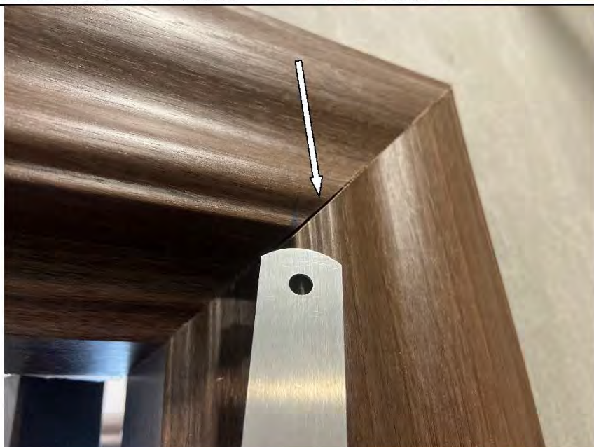
Фото №98. Дефекты на наличниках деревянного дверного блока в санузле.
