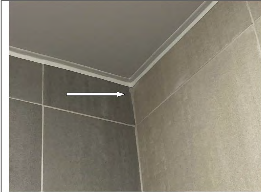
Фото №19. Загрязнения на настенной керамической плитке в ванной комнате.
