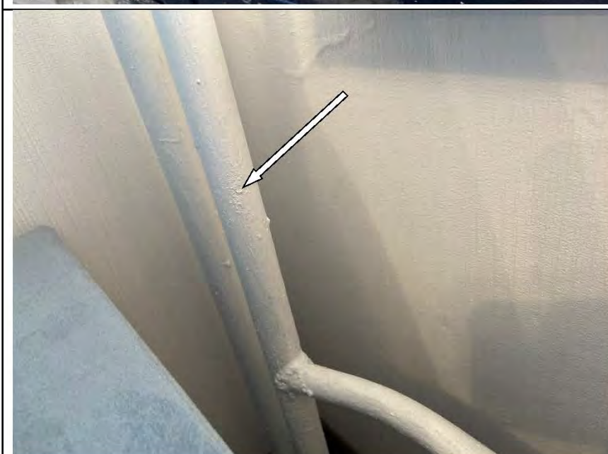
Фото №81. Неровности, подтеки на окрашенных трубах отопления в кухне.
