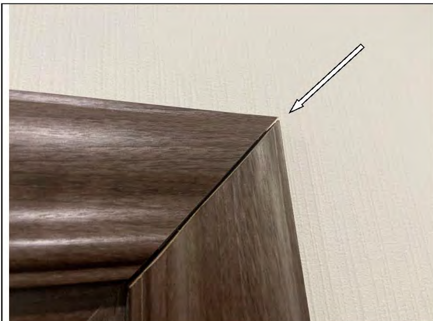
Фото №94. Дефекты на наличниках деревянного дверного блока в гардеробной.
