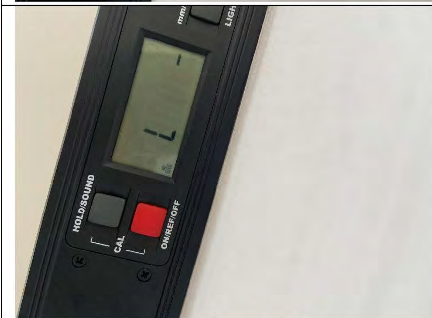
Фото №14. Отклонения поверхности стен от вертикали в кабинете.
