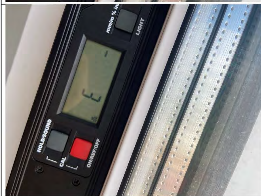
Фото №72. Отклонения от вертикали оконного блока ПВХ в кабинете.
