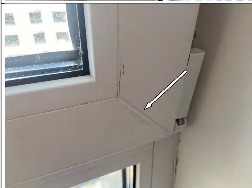
Фото №59. Загрязнения на профиле оконного блока ПВХ в кабинете.
