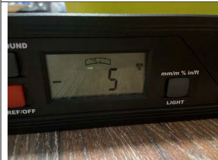
Фото №23. Отклонения поверхности напольного покрытия из ламината в гардеробной.
