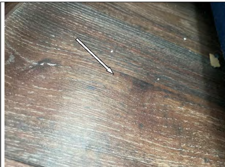
Фото №49. Дефект на напольном покрытии из ламината в кухне.
