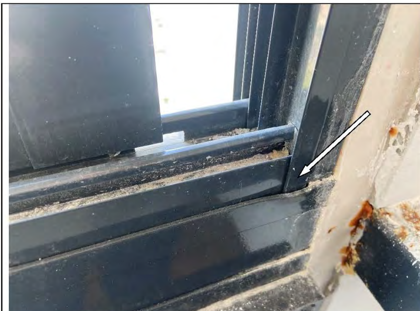
Фото №79. Дефект на металлическом профиле оконного блока на лоджии.
