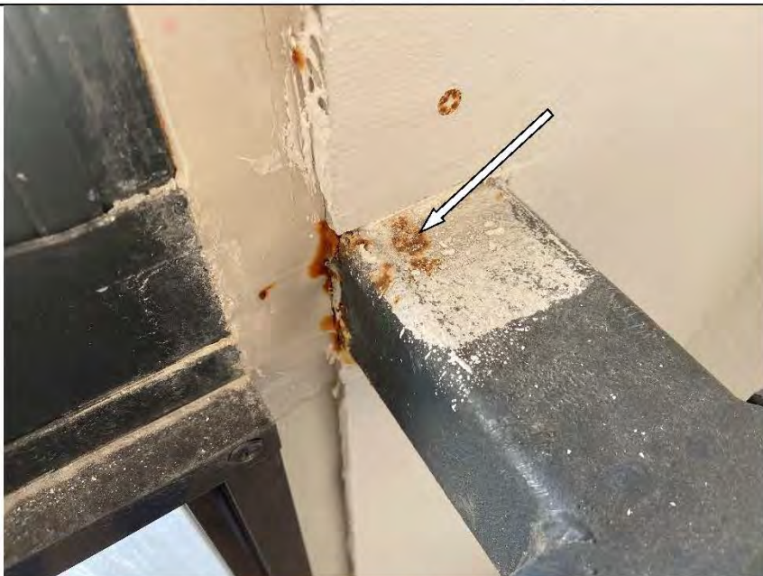
Фото №77. Коррозия на металлическом ограждении на лоджии.
