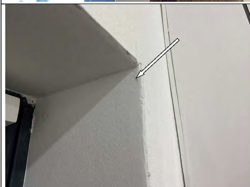
Фото №108. Неровности, выбоины, раковины на окрашенных откосах входного дверного блока в коридоре.
