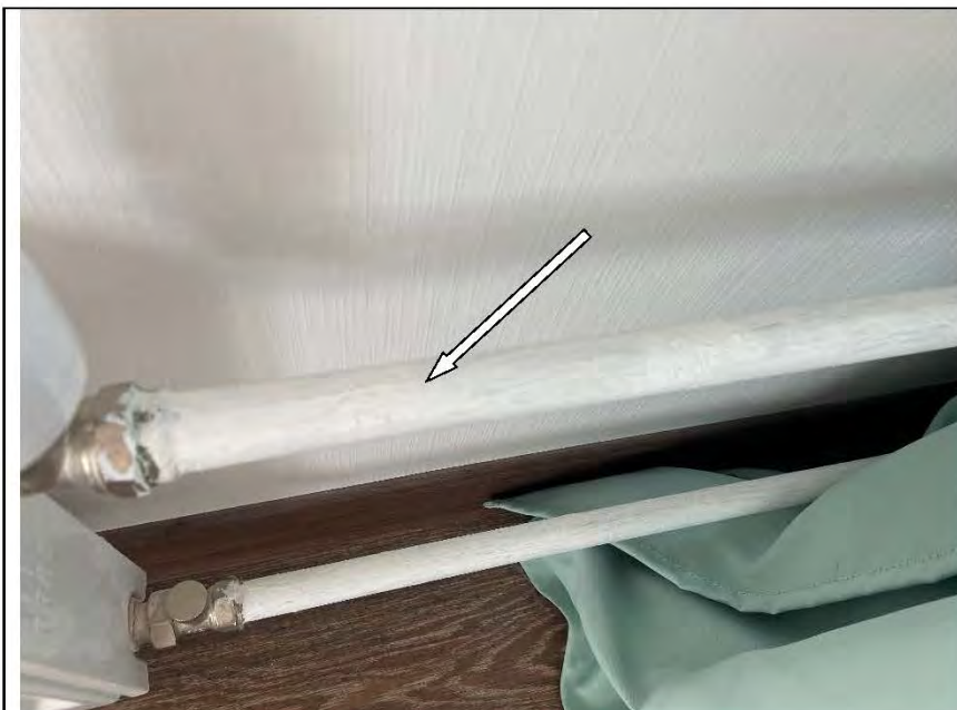
Фото №82. Неровности, подтеки на окрашенных трубах отопления в детской.
