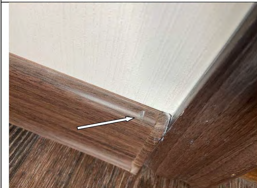
Фото №44. Дефект на напольном плинтусе ПВХ в спальне.
