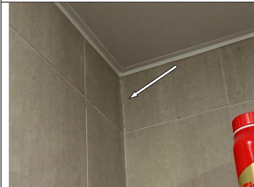
Фото №20. Загрязнения на настенной керамической плитке в санузле.
