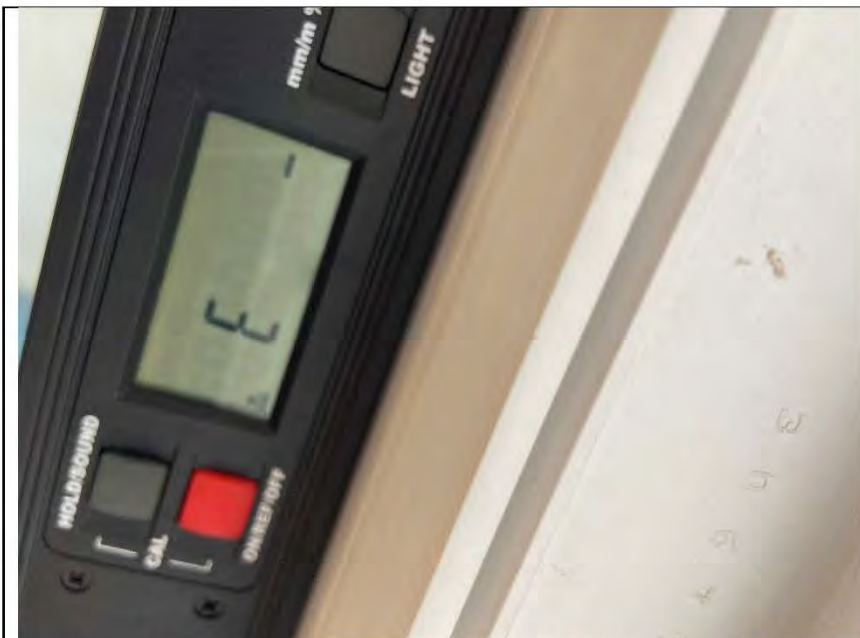
Фото №70. Отклонения от вертикали оконного блока ПВХ в кухне.
