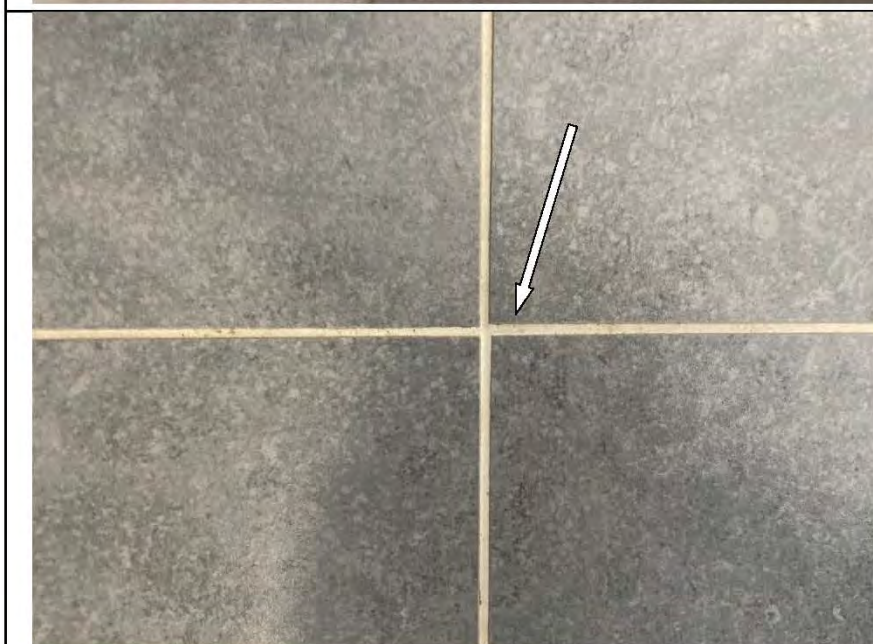
Фото №38. Неровные швы напольной керамической плитки в кухне.
