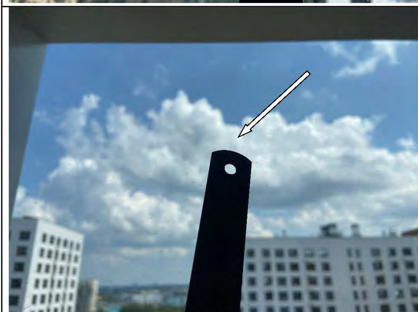
Фото №63. Царапина на стеклопакете оконного блока ПВХ в детской.
