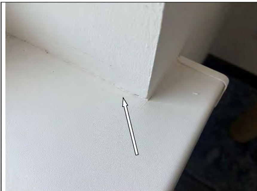
Фото №55. Дефект на лицевой стороне подоконной доски в кабинете.
