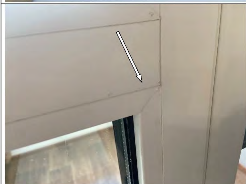
Фото №57. Загрязнения на профиле оконного блока ПВХ в кухне.
