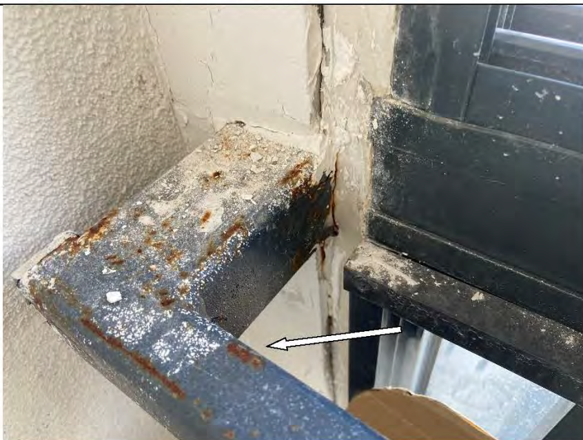
Фото №78. Коррозия на металлическом ограждении на лоджии.
