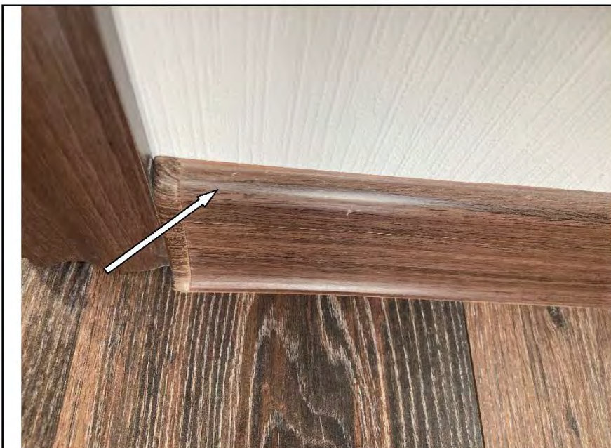
Фото №43. Дефект на напольном плинтусе ПВХ в кабинете.
