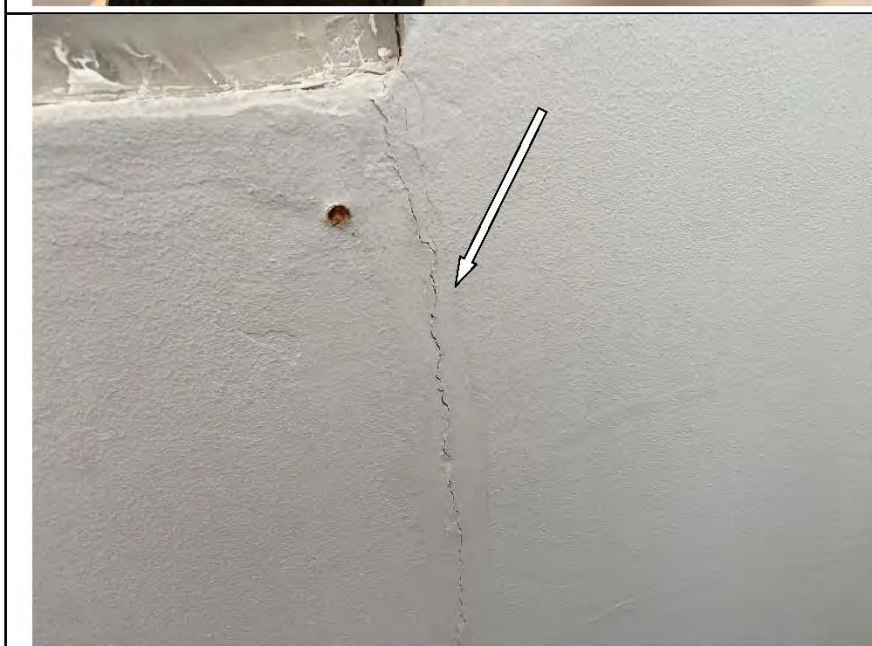
Фото №18. Трещина на окрашенных стенах на лоджии.
