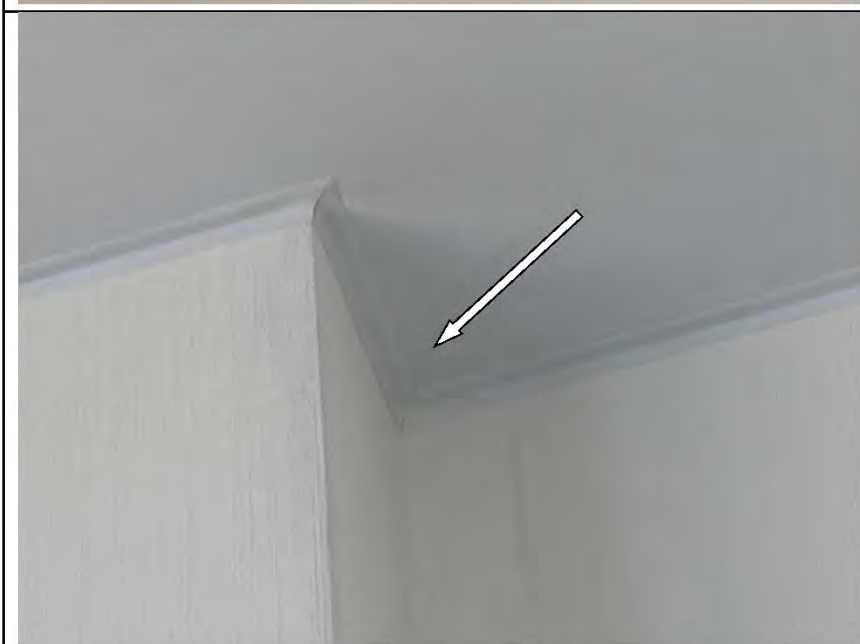
Фото №114. Дефекты на поверхности натяжного потолка в детской.
