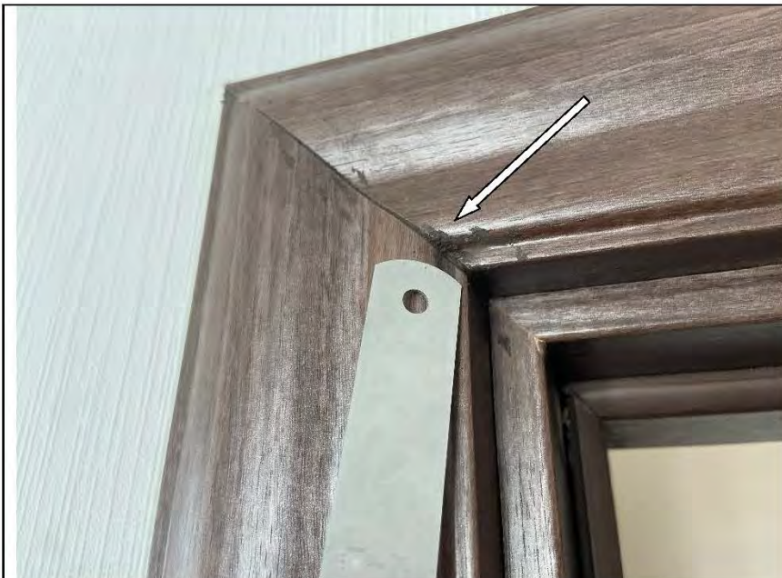
Фото №97. Дефекты на наличниках деревянного дверного блока в детской.
