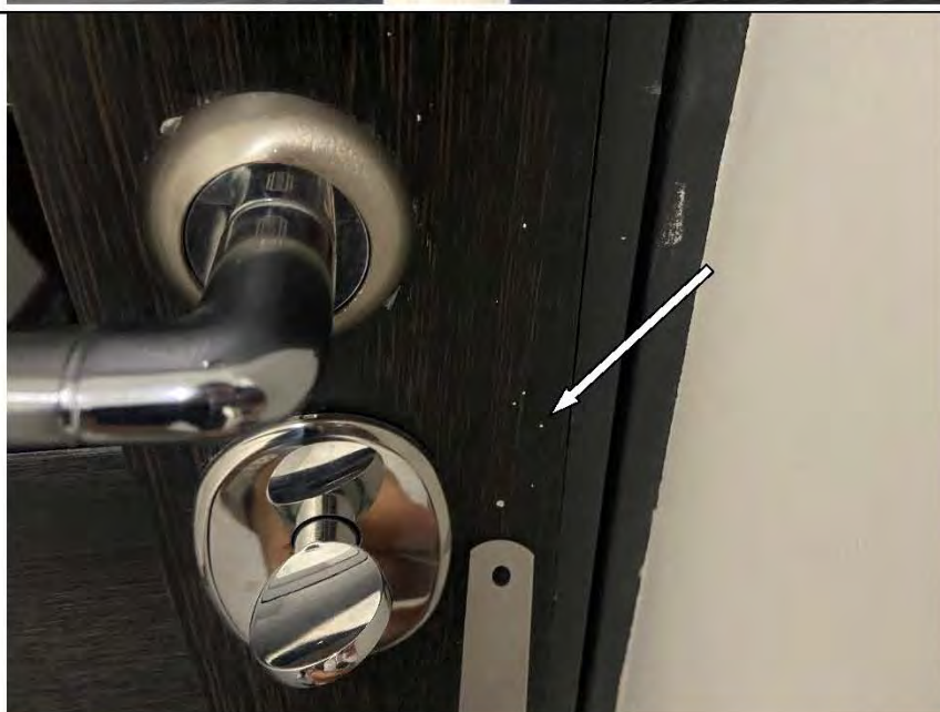
Фото №86. Дефекты на полотне входного дверного блока в коридоре.
