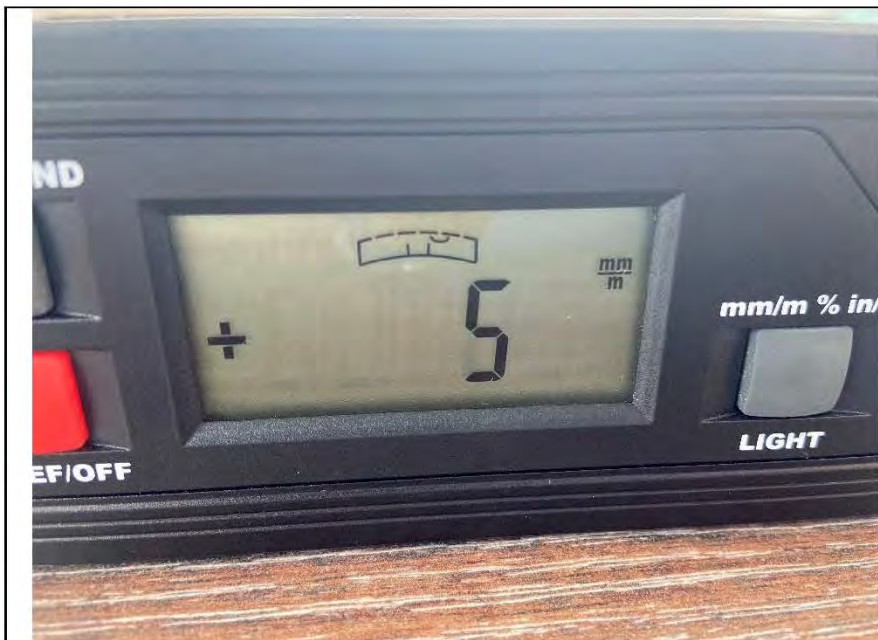
Фото №25. Отклонения поверхности напольного покрытия из ламината в детской.
