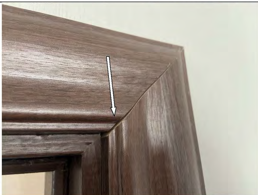
Фото №99. Дефекты на наличниках деревянного дверного блока в кабинете.
