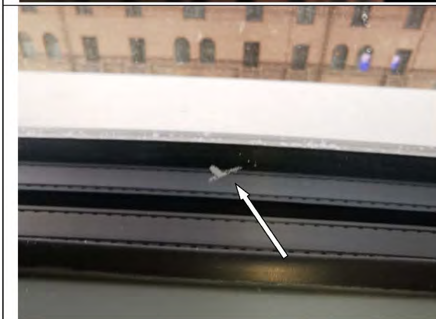
Фото №29. Загрязнения на стеклопакете металлического оконного блока в комнате.
