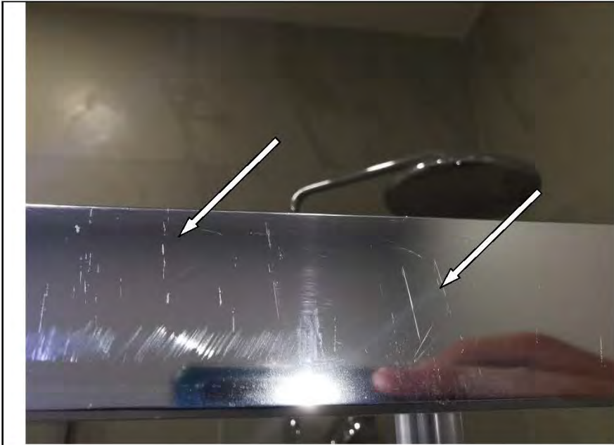
Фото №37. Царапины на профилях душевой кабины в санузле.
