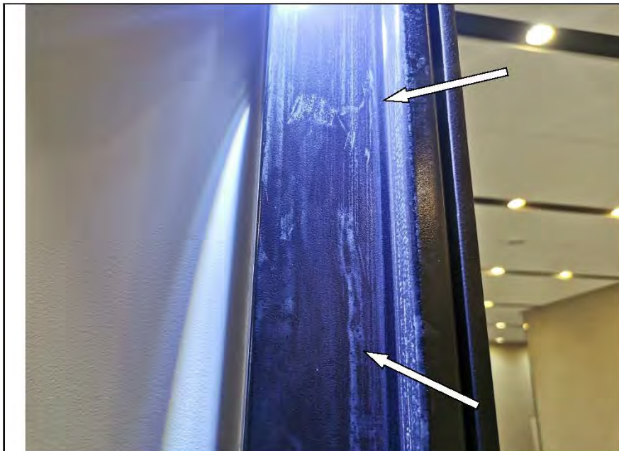
Фото №34. Загрязнение коробки входного дверного блока.
