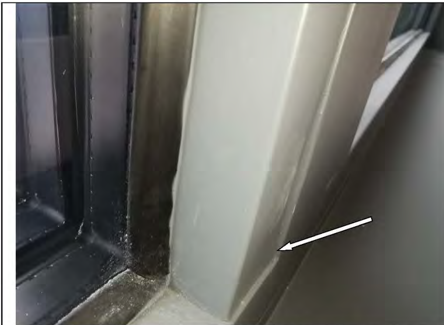
Фото №25. Смятие профиля металлического оконного блока в комнате.
