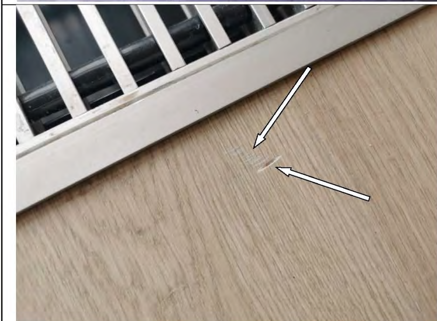
Фото №15. Царапины и выбоины на напольном покрытии из ламината в комнате.
