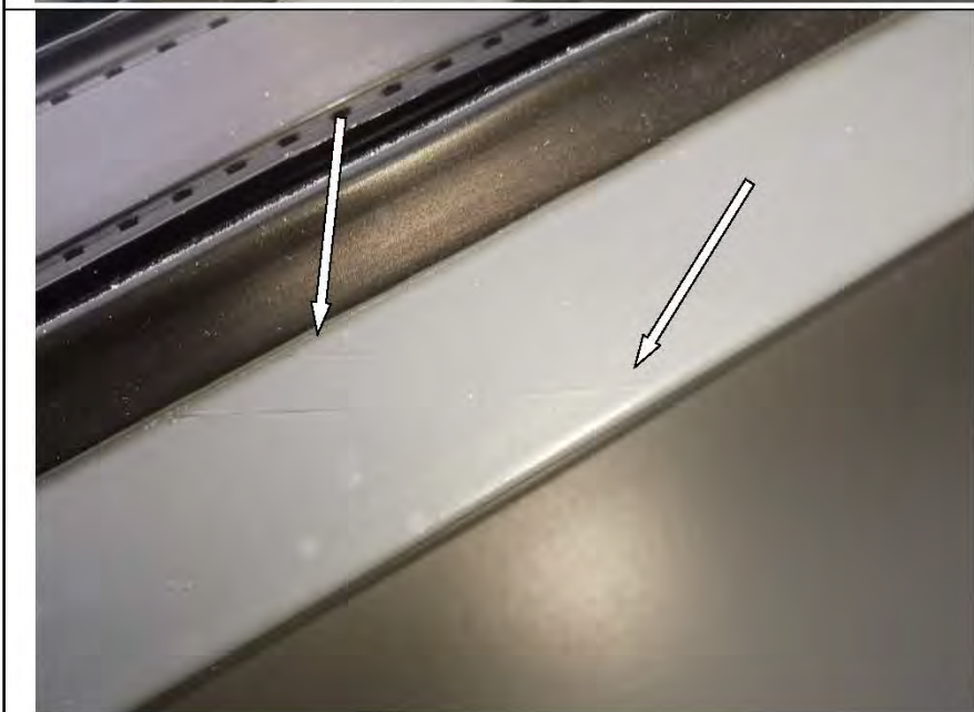
Фото №26. Царапины на профиле металлического оконного блока в комнате.
