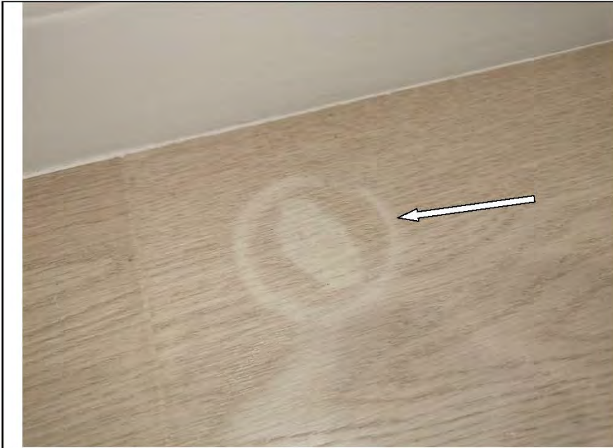
Фото №13. Повреждение напольного покрытия из ламината в коридоре.
