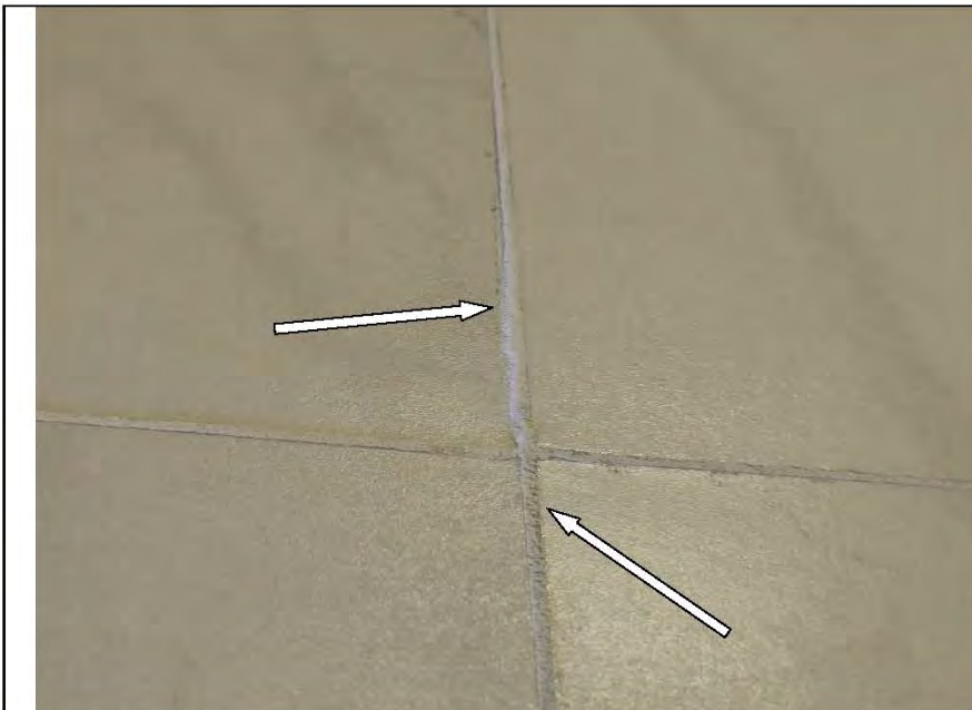
Фото №10. Некачественно выполнена затирка настенной керамической плитки в санузле.
