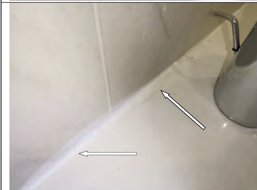
Фото №39. Загрязнения на раковине в санузле.
