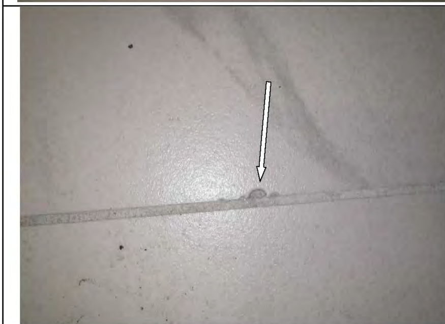
Фото №21. Отбитости на напольной керамической плитке в санузле.
