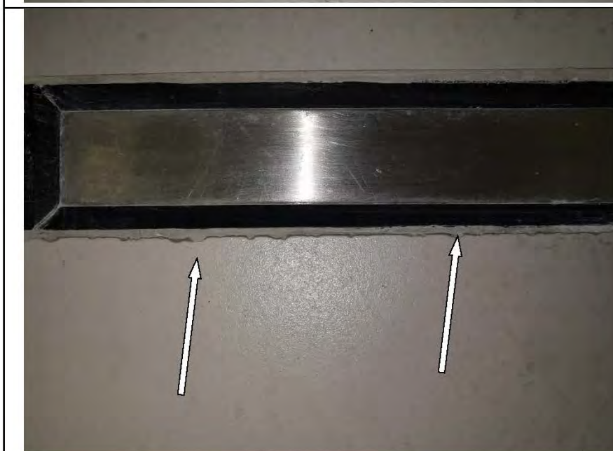
Фото №20. Отбитости на напольной керамической плитке в санузле.
