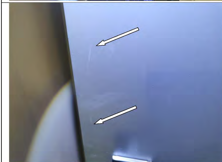
Фото №35. Загрязнение полотна входного дверного блока.
