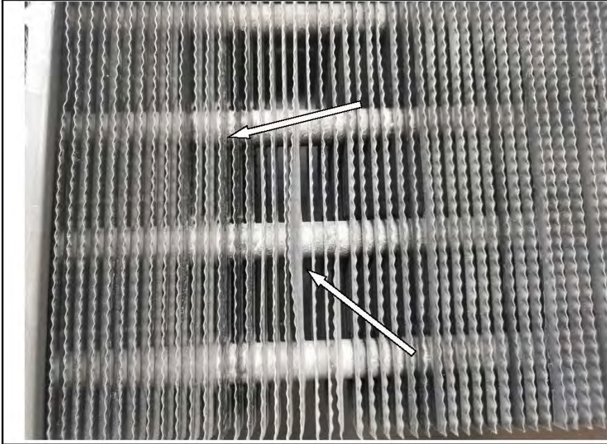
Фото №40. Замятие сот радиатора в комнате.
