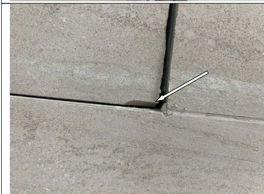
Фото №23. Отбитости настенной керамической плитки в ванной комнате.
