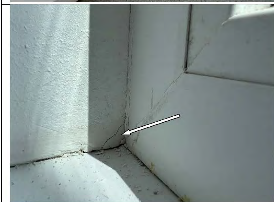
Фото №60. Трещина на откосе оконного блока ПВХ в кухне.
