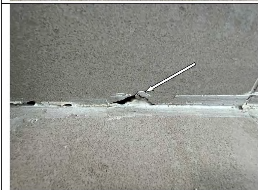
Фото №24. Отбитости настенной керамической плитки в ванной комнате.
