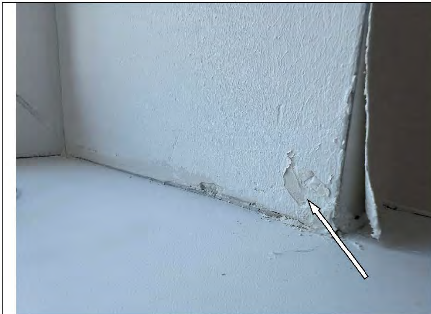
Фото №58. Скол на откосе оконного блока ПВХ в спальне.
