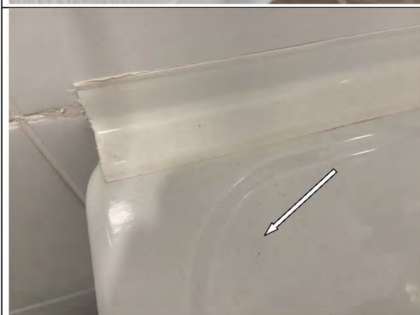
Фото №90. Загрязнения на ванне в ванной комнате.
