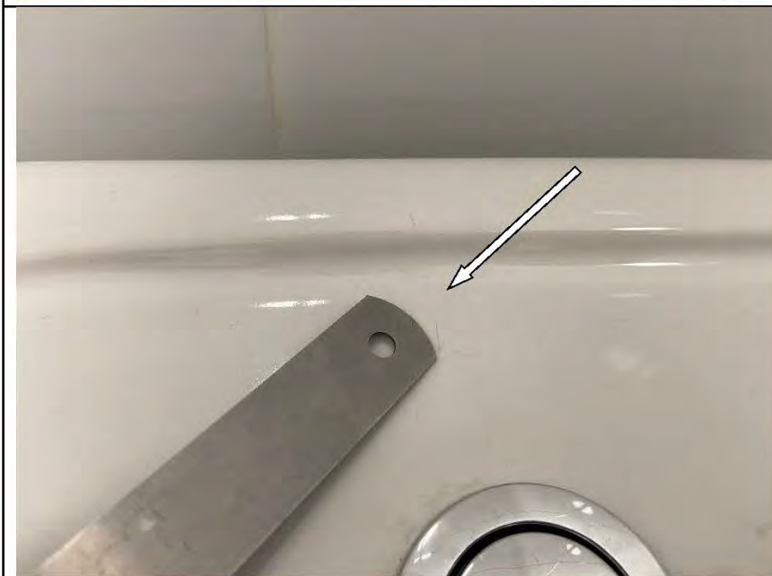
Фото №92. Загрязнения на раковине в санузле.
