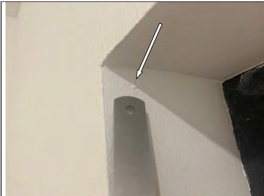
Фото №64. Неровности, выбоины, раковины на окрашенных откосах входного дверного блока в коридоре.
