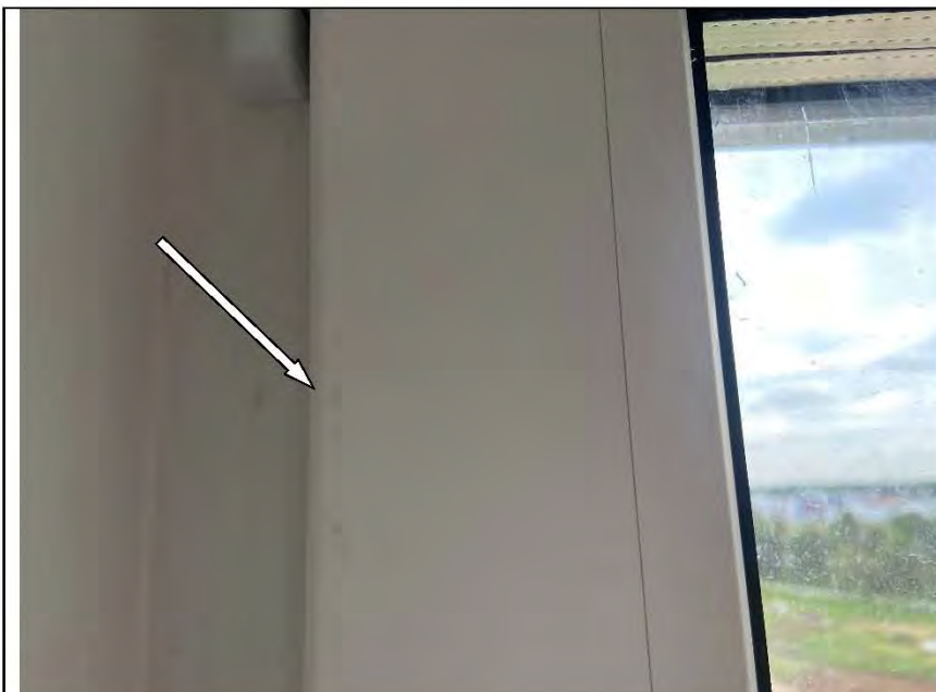
Фото №49. Загрязнения на профиле оконного блока ПВХ в кухне.
