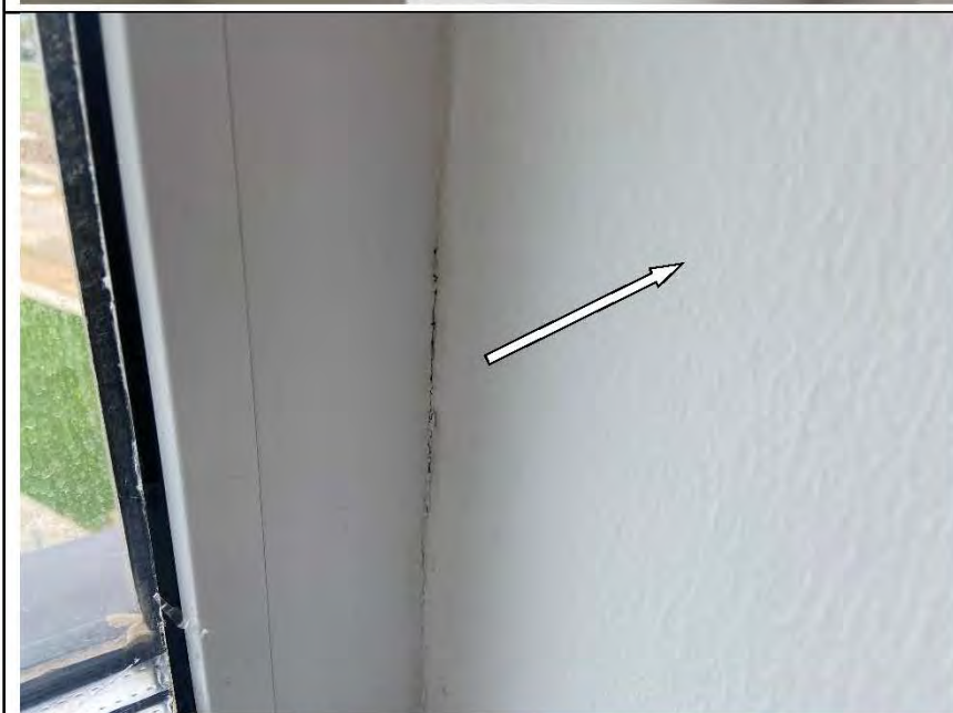
Фото №56. Неровности, выбоины, раковины на окрашенных откосах оконного блока ПВХ в спальне.
