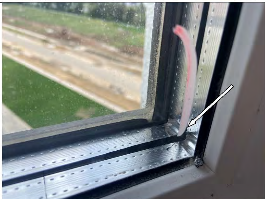
Фото №59. Дефект на уплотнительной ленте оконного блока ПВХ в кухне.
