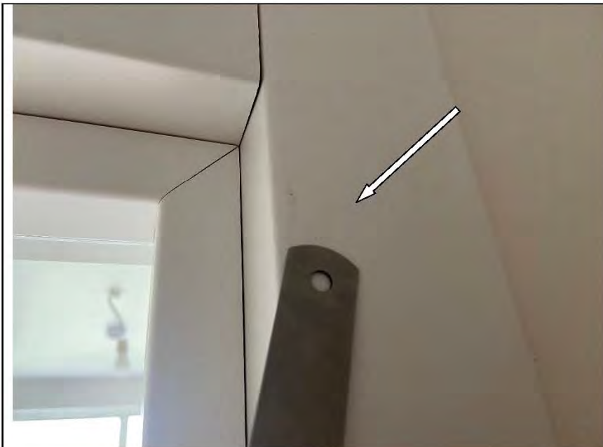
Фото №73. Дефекты на наличниках деревянного дверного блока в гардеробной.
