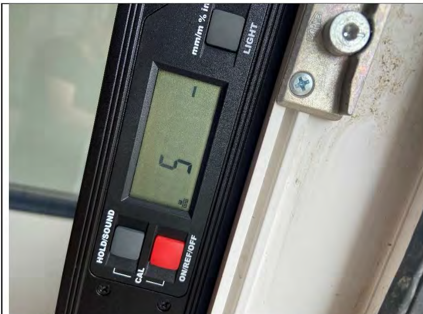
Фото №58. Отклонения от вертикали оконного блока ПВХ в спальне.
