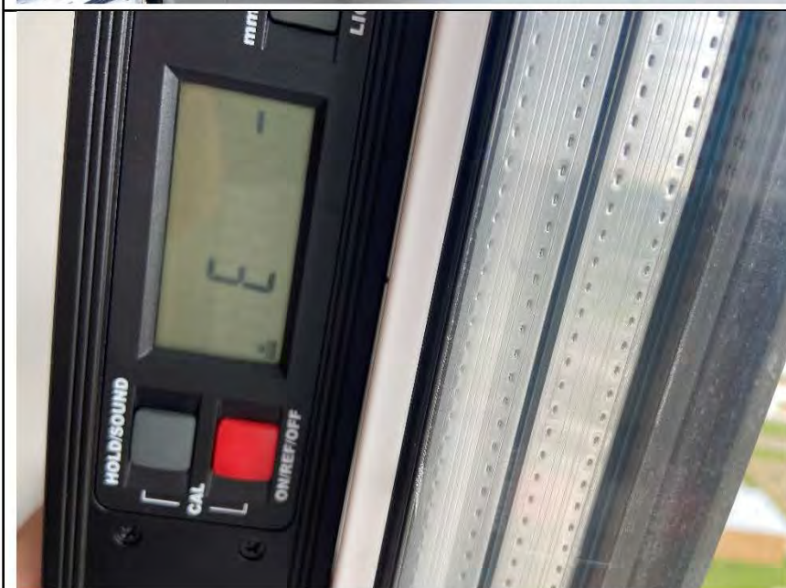
Фото №57. Отклонения от вертикали оконного блока ПВХ в кухне.
