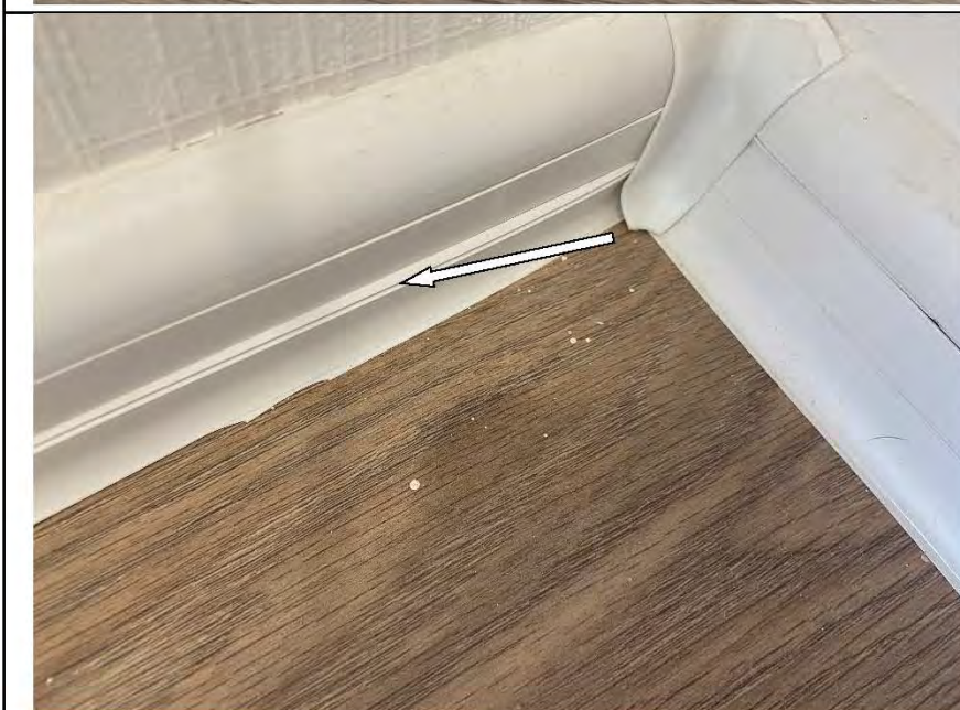
Фото №33. Дефект на напольном плинтусе ПВХ в гардеробной.
