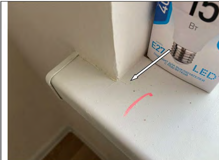
Фото №46. Царапина на лицевой стороне подоконной доски в кухне.
