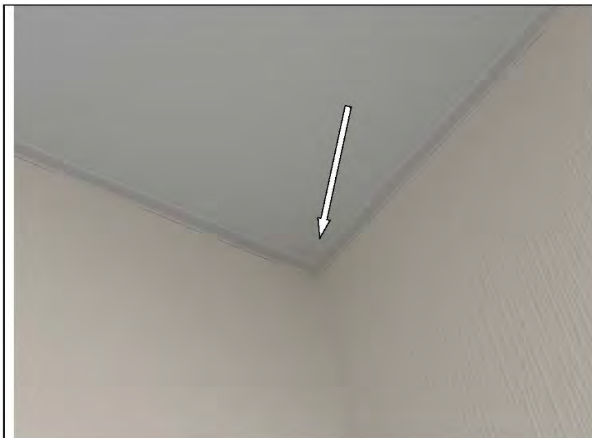
Фото №85. Дефект на поверхности натяжного потолка в гардеробной.
