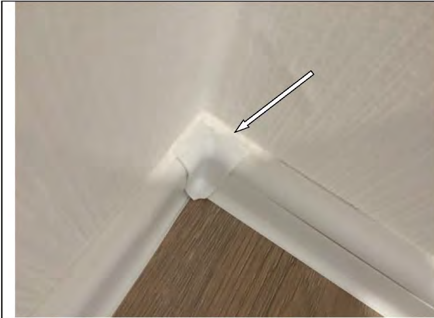
Фото №34. Дефект на напольном плинтусе ПВХ в спальне.
