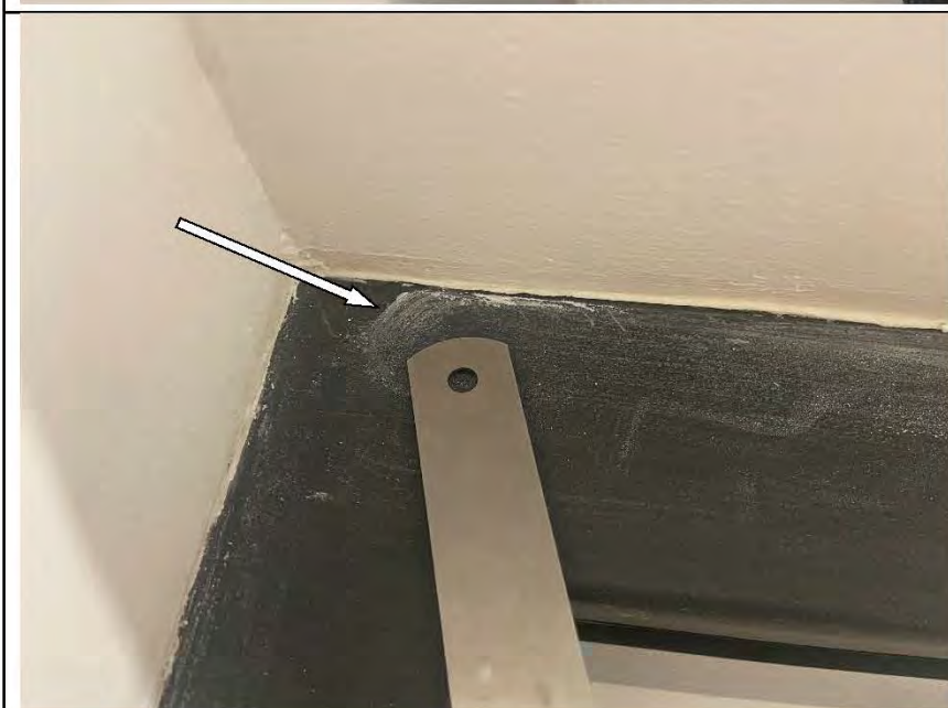
Фото №65. Дефекты на коробке входного дверного блока в коридоре.
