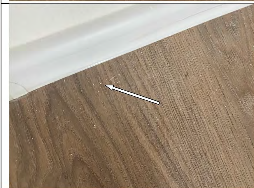
Фото №36. Дефект на поверхности напольного покрытия из ламината в кухне.
