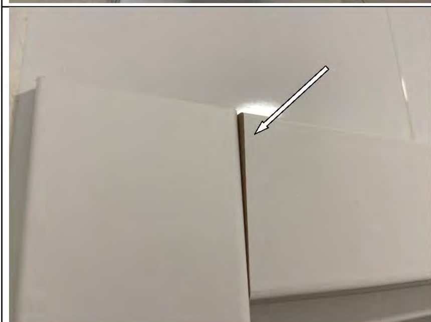
Фото №75. Дефекты на наличниках деревянного дверного блока в санузле.
