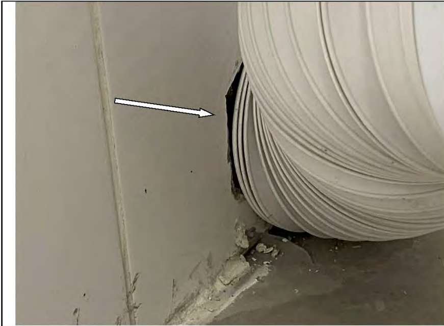
Фото №19. Сколы на настенной керамической плитке в санузле.
