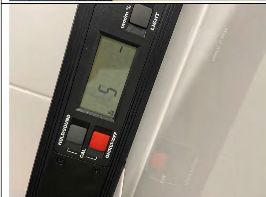
Фото №12. Отклонения поверхности стен от вертикали в ванной комнате.
