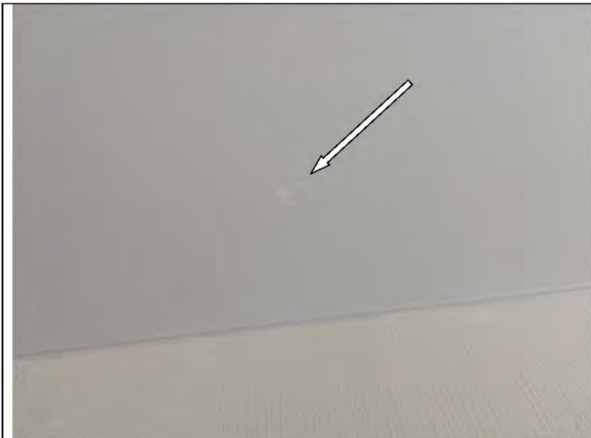
Фото №82. Дефект на поверхности натяжного потолка в кухне.
