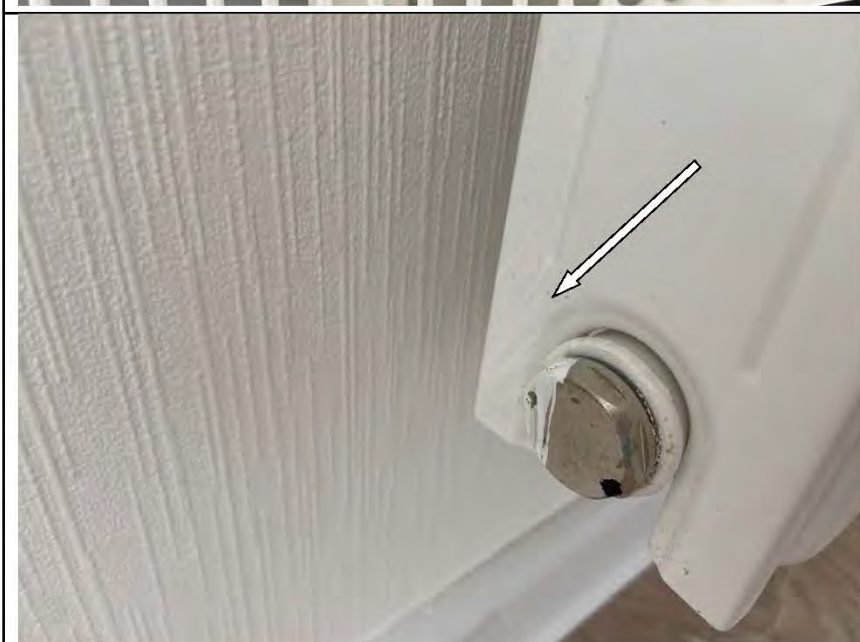
Фото №89. Дефект на поверхности металлического кожуха отопительного прибора в спальне.
