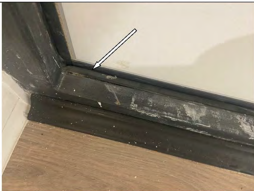
Фото №80. Дефект на уплотнительной ленте входного дверного блока в коридоре.
