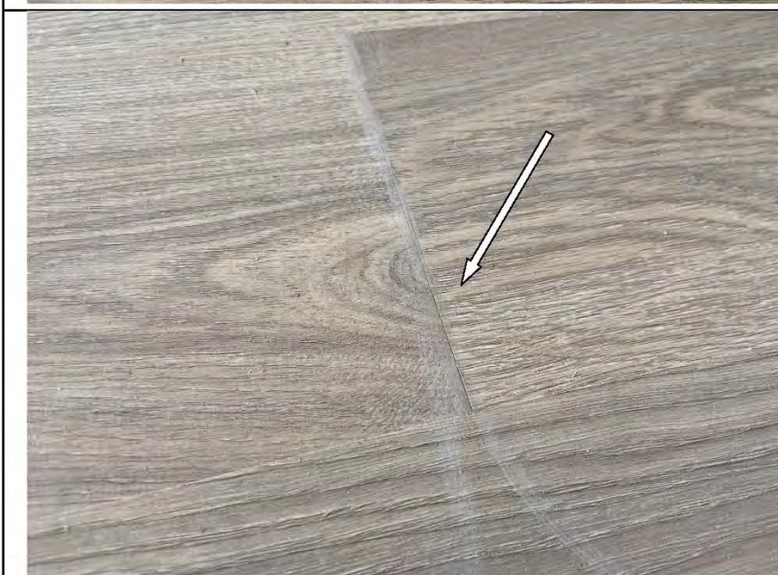
Фото №39. Дефект на поверхности напольного покрытия из ламината в спальне.
