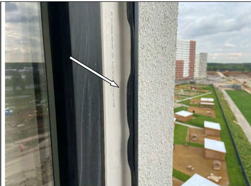
Фото №61. Дефект на уплотнительной ленте оконного блока ПВХ в спальне.
