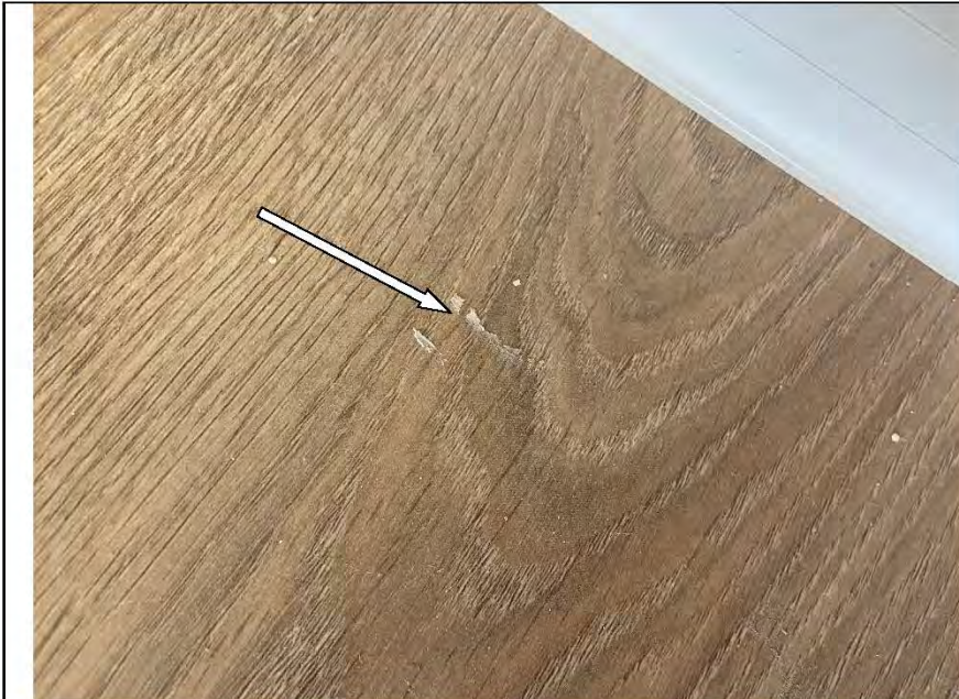
Фото №40. Дефект на поверхности напольного покрытия из ламината в гардеробной.
