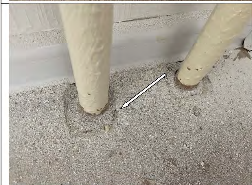
Фото №44. Дефект вставки труб отопления в напольное покрытие из ламината в спальне.
