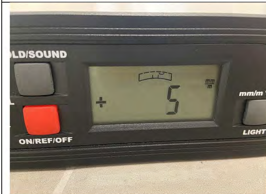
Фото №26. Отклонения поверхности напольного покрытия из керамической плитки в санузле.
