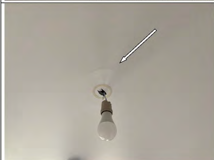
Фото №83. Дефект на поверхности натяжного потолка в кухне.
