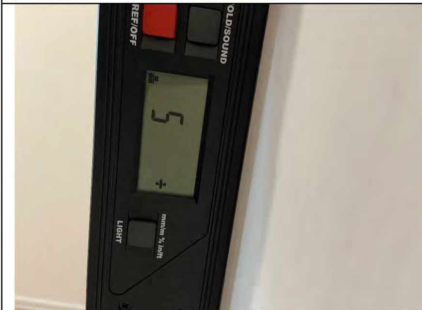
Фото №8. Отклонения поверхности стен от вертикали в коридоре.
