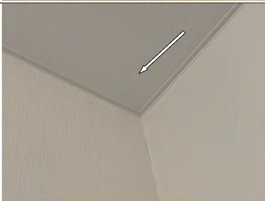
Фото №81. Дефект на поверхности натяжного потолка в коридоре.
