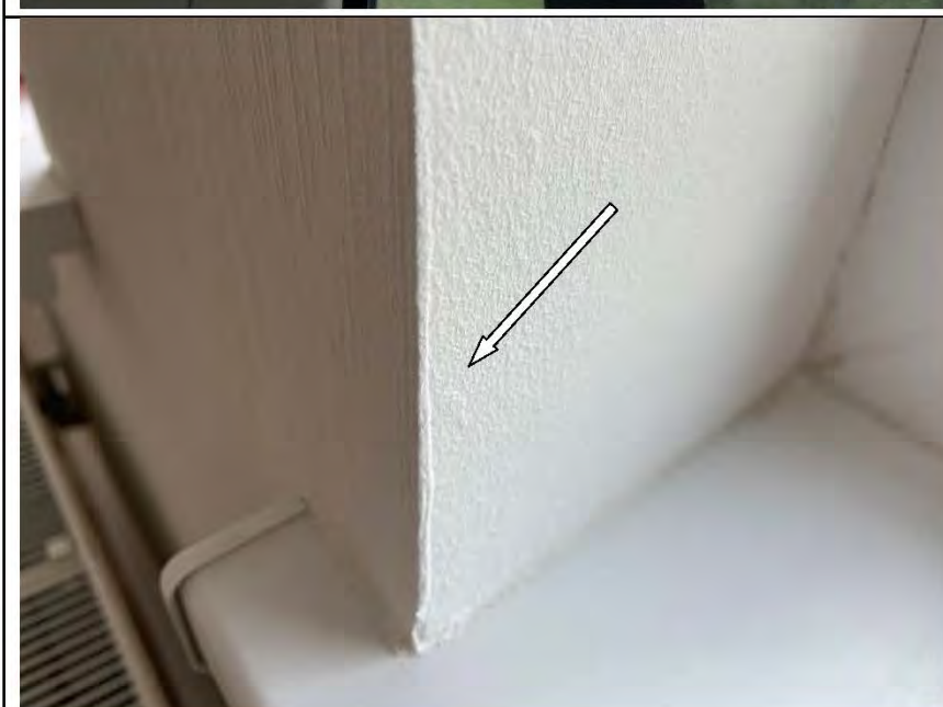
Фото №54. Неровности, выбоины, раковины на окрашенных откосах оконного блока ПВХ в кухне.
