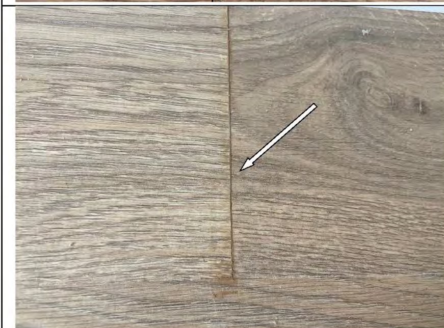
Фото №38. Дефект на поверхности напольного покрытия из ламината в спальне.
