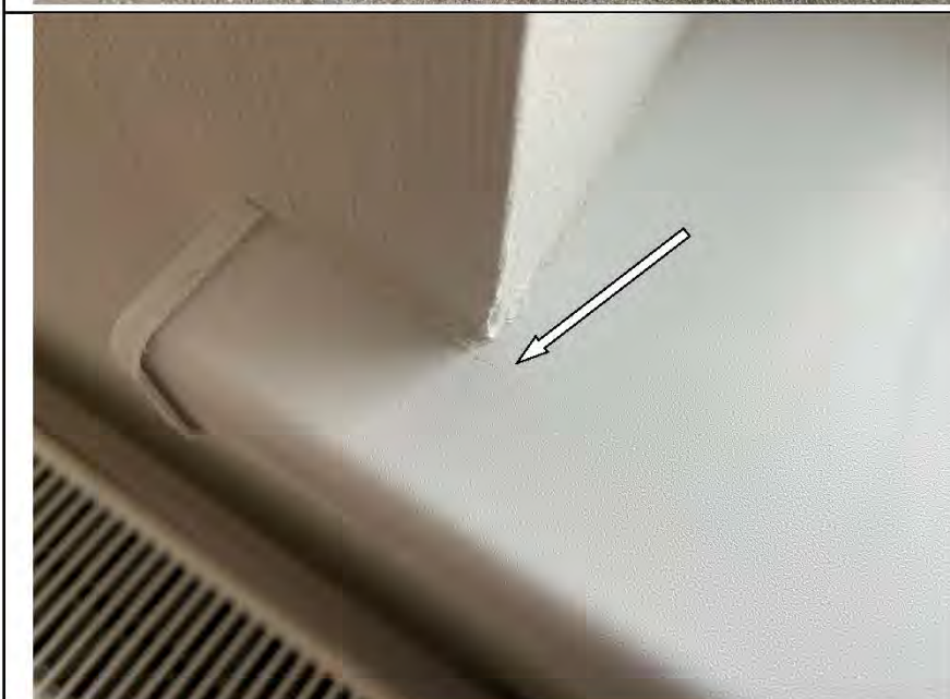
Фото №45. Царапина на лицевой стороне подоконной доски в кухне.
