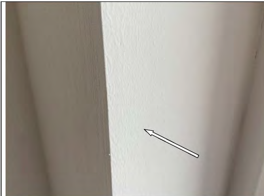
Фото №55. Неровности, выбоины, раковины на окрашенных откосах оконного блока ПВХ в кухне.
