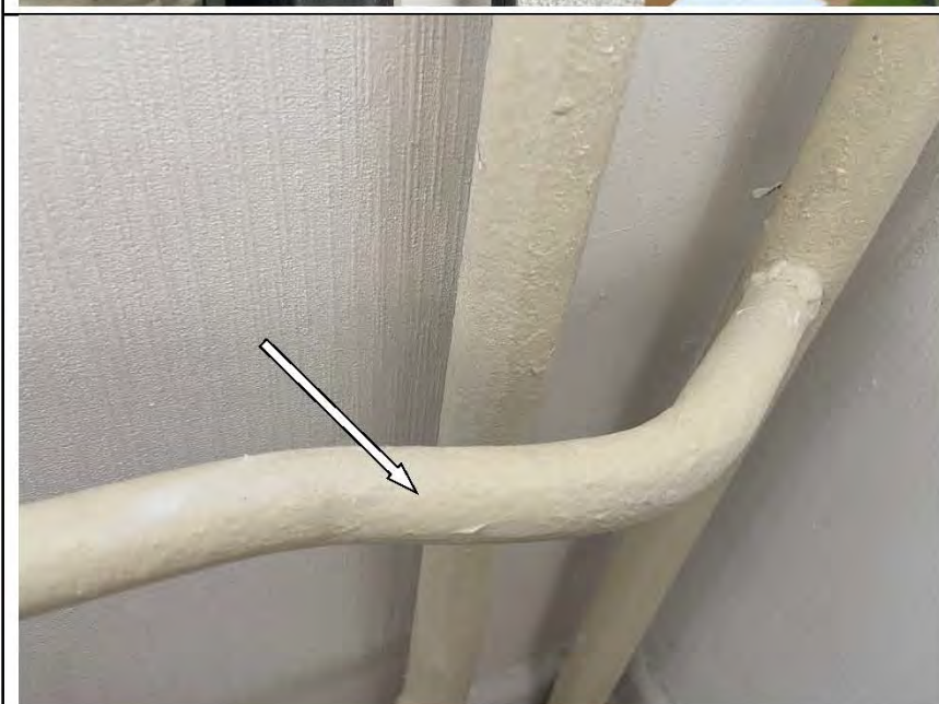
Фото №62. Неровности, подтеки на окрашенных трубах отопления в кухне.
