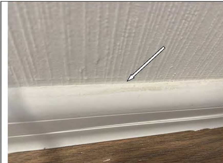
Фото №31. Дефект на напольном плинтусе ПВХ в коридоре.
