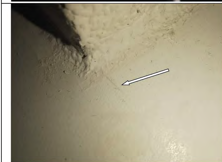
Фото №45. Царапины на лицевой поверхности подоконной доски в кухне.
