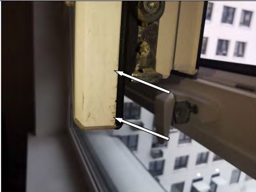
Фото №40. Царапины и потертости на профиле ПВХ оконного блока на кухне.
