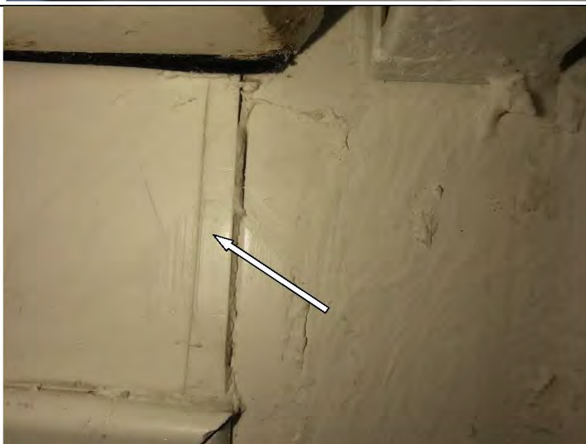
Фото №38. Царапины и загрязнение на профиле ПВХ оконного блока в спальне.
