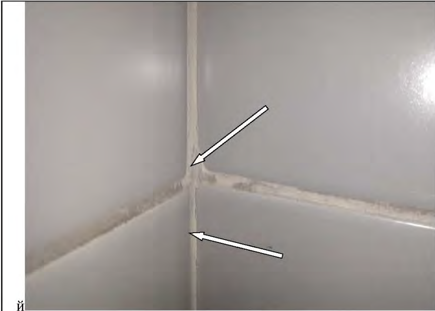
Фото №19. Затирка настенной плитки в ванной комнате выполнена с нарушениями.
