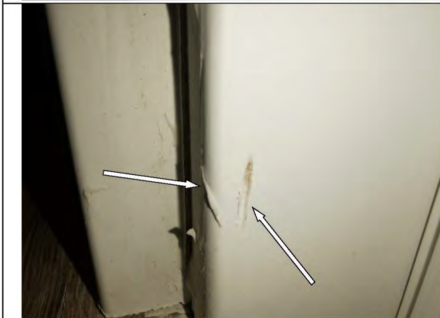
Фото №47. Царапины и загрязнения на коробе деревянного дверного блока в ванной комнате.
