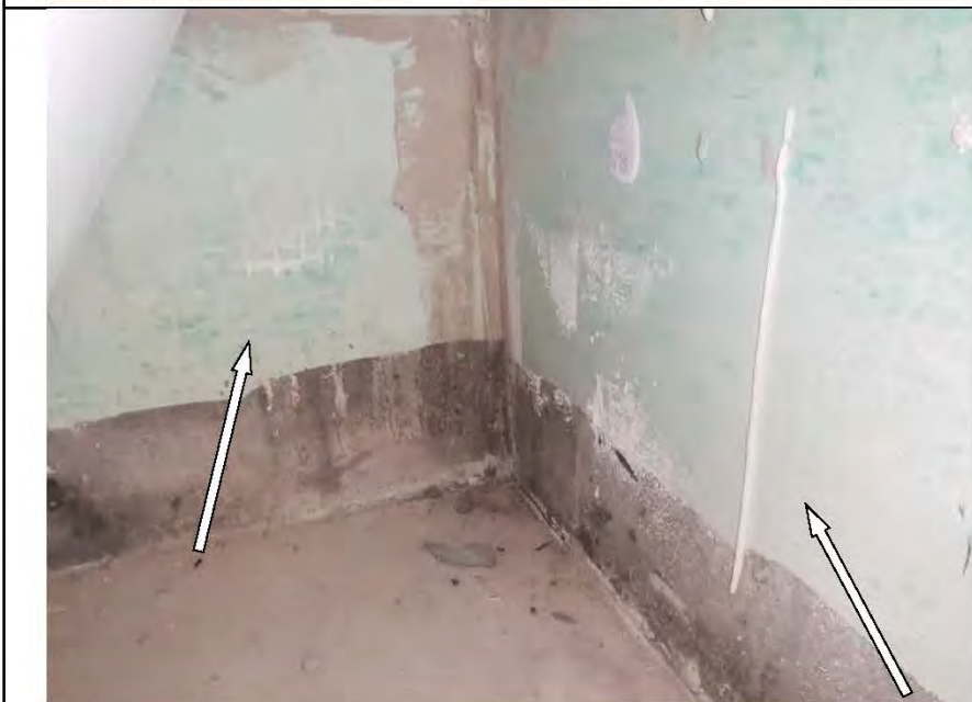
Фото №17. Частично отсутствует настенная керамическая плитка за ванной.
