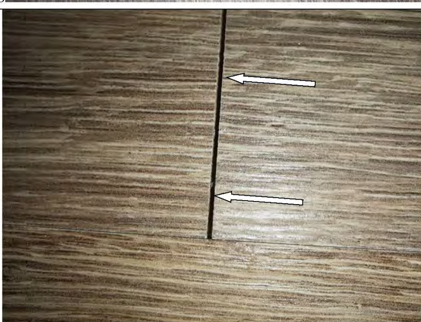
Фото №27. Зазор между соседними досками ламината в кухне.
