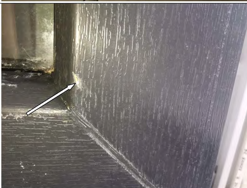
Фото №39. Потертости на профиле ПВХ оконного блока в спальне.
