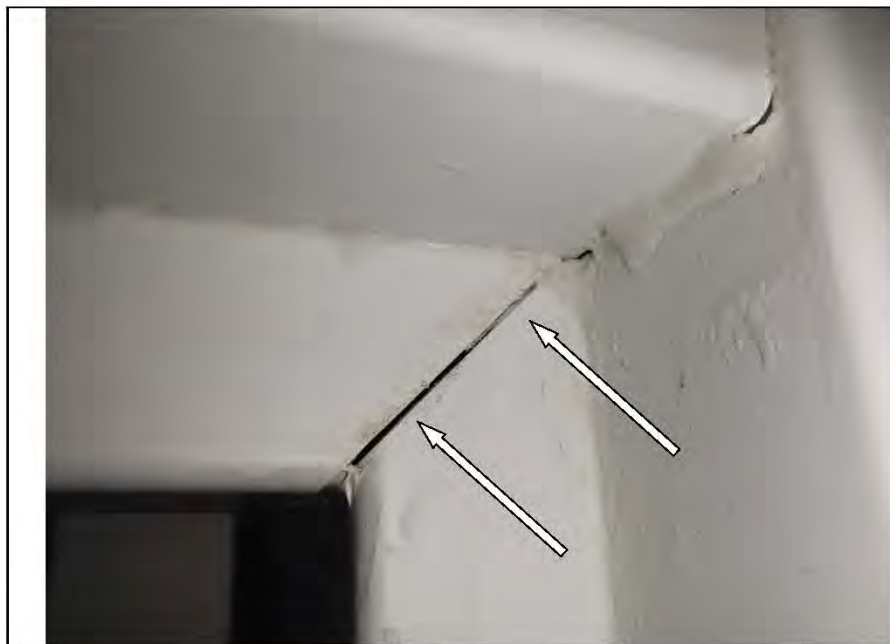
Фото №52. Элементы дверного блока (коробка) соединены не надежно в ванной комнате
