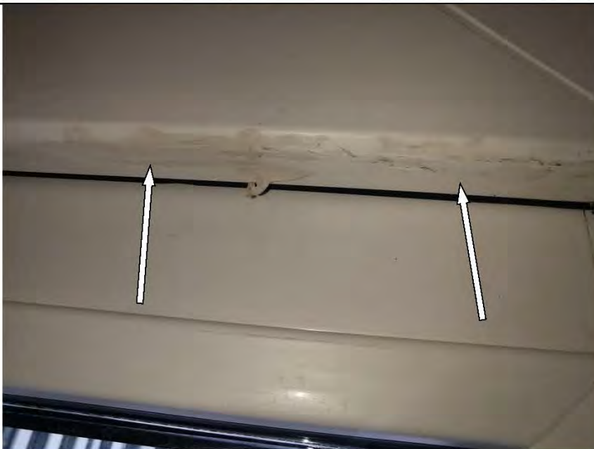
Фото №41. Загрязнение профиля ПВХ оконного блока на кухне.
