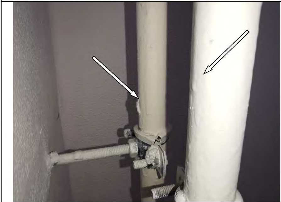
Фото №59. Окрашивание труб отопления выполнено с дефектами в кухне
