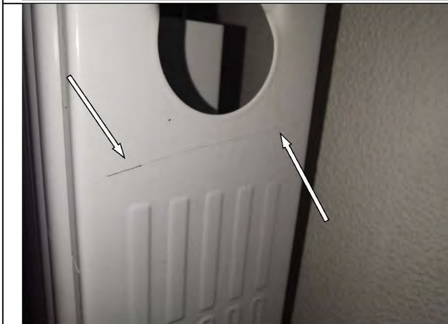
Фото №62. Царапины на радиаторе в спальне
