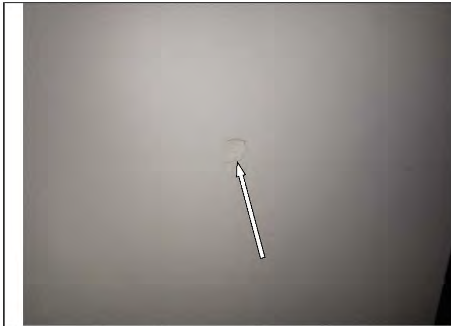
Фото №49. Повреждение ламинации полотна деревянного дверного блока в ванной комнате.
