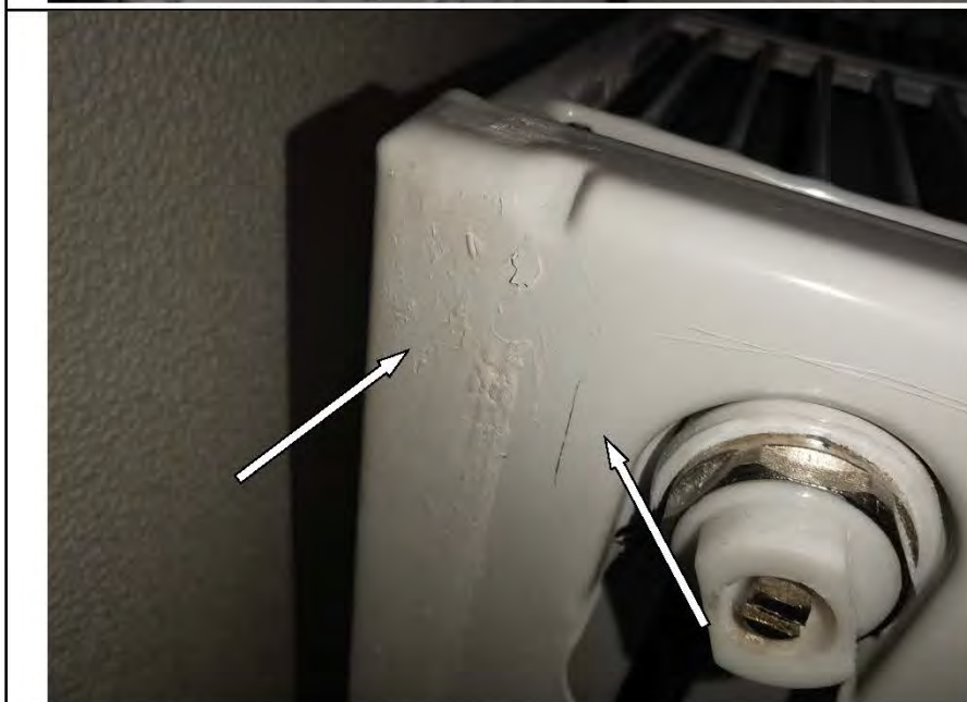
Фото №63. Загрязнения и царапины на радиаторе на кухне.
