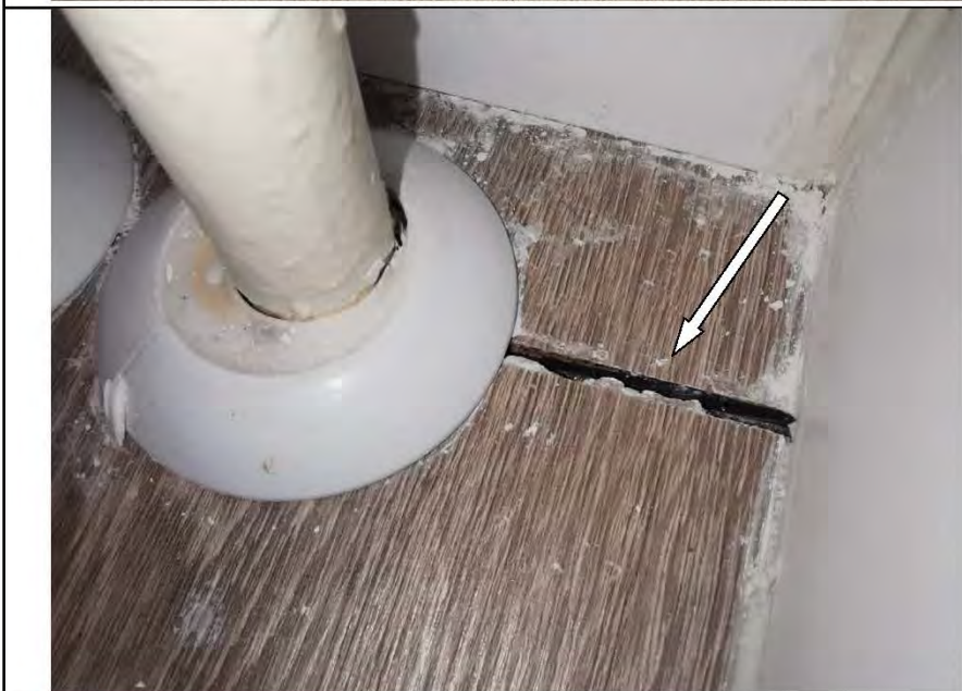
Фото №29. Некачественно выполнена затирка швов напольной керамической плитки в коридоре.
