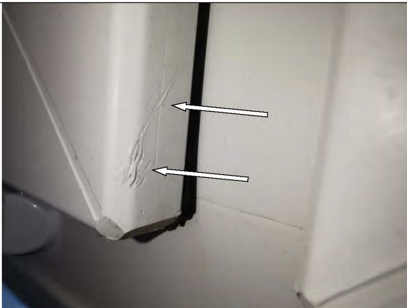
Фото №37. Царапины и потертости на профиле ПВХ оконного блока в спальне.
