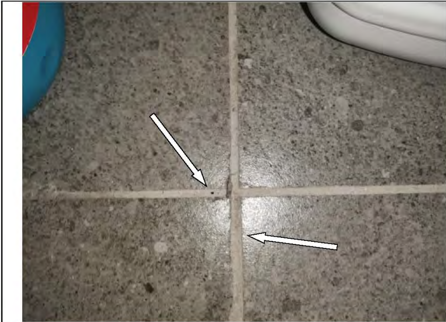
Фото №31. Некачественно выполнена затирка швов напольной керамической плитки в ванной комнате.
