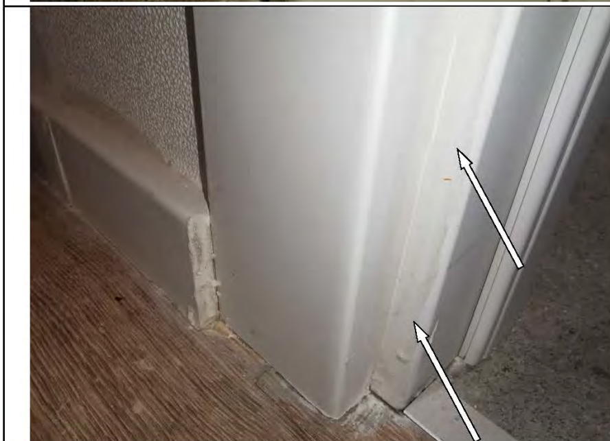
Фото №48. Загрязнение короба деревянного дверного блока в ванной комнате.
