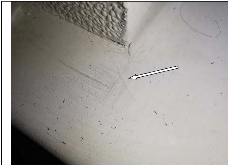
Фото №46. Царапины на лицевой поверхности подоконной доски в спальне.
