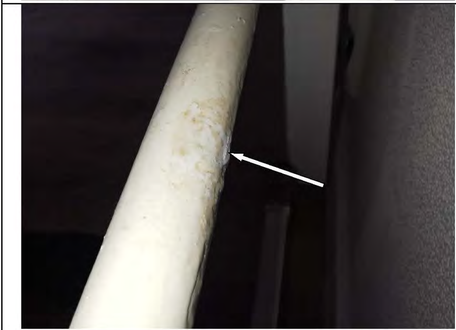
Фото №60. Окрашивание труб отопления выполнено с дефектами в спальне.
