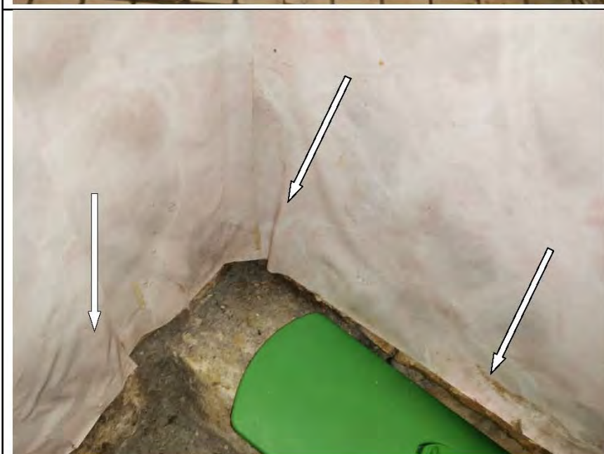
Фото №62. Стены, оклеенные самоклящейся пленкой, в санузле имеют дефекты характерные последствиям залива (вздутия, отслоения).
