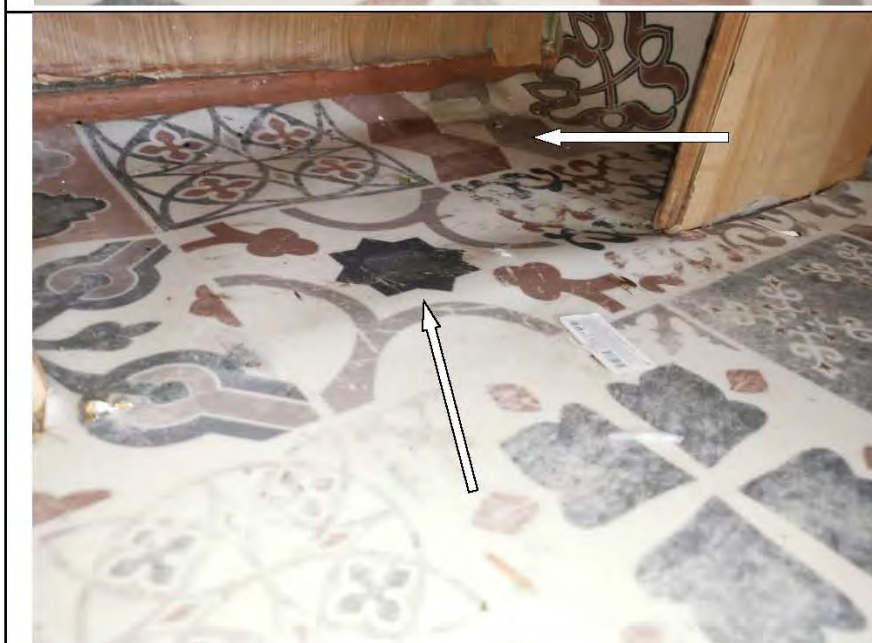
Фото №32. Следы залития на линолеуме в коридоре (вздутия, отслоения).
