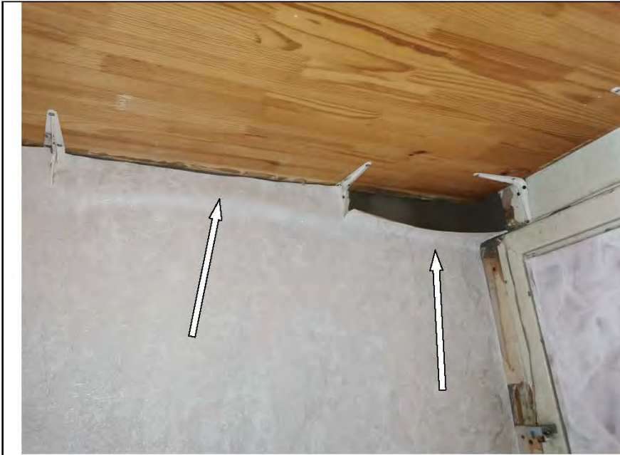
Фото №12. Следы залития обойного полотна в коридоре (вздутия, отслоения).
