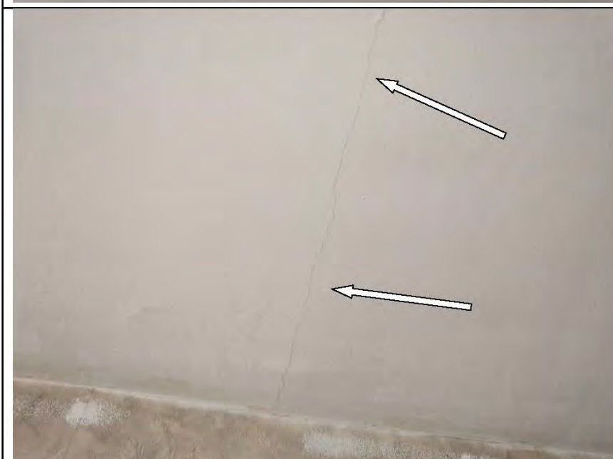
Фото №55. Следы заливания на потолке в спальне (трещины).
