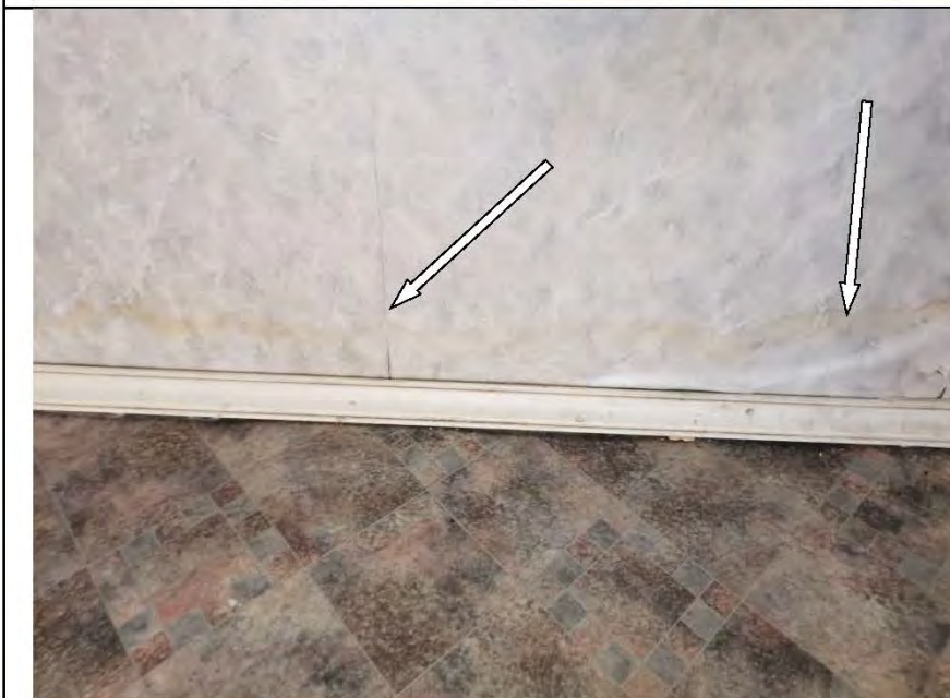
Фото №28. Следы залития обоевого полотна в спальне (вздутия, отслоения, поражение грибком).
