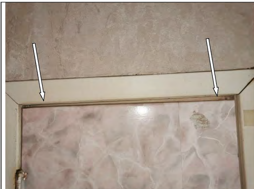
Фото №60. Полотно деревянного дверного блока деформировано в санузле.
