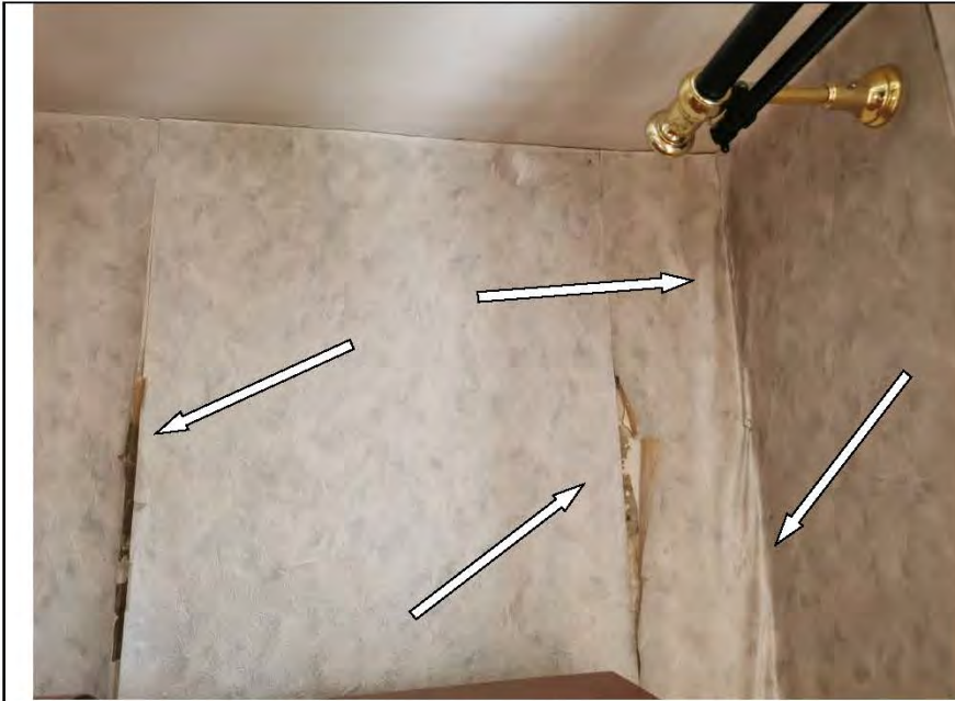
Фото №24. Следы заливания обоевого полотна в спальне (вздутия, отслоения).
