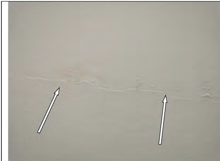
Фото №48. Следы залития на потолке в кухне (отслоения, трещины).
