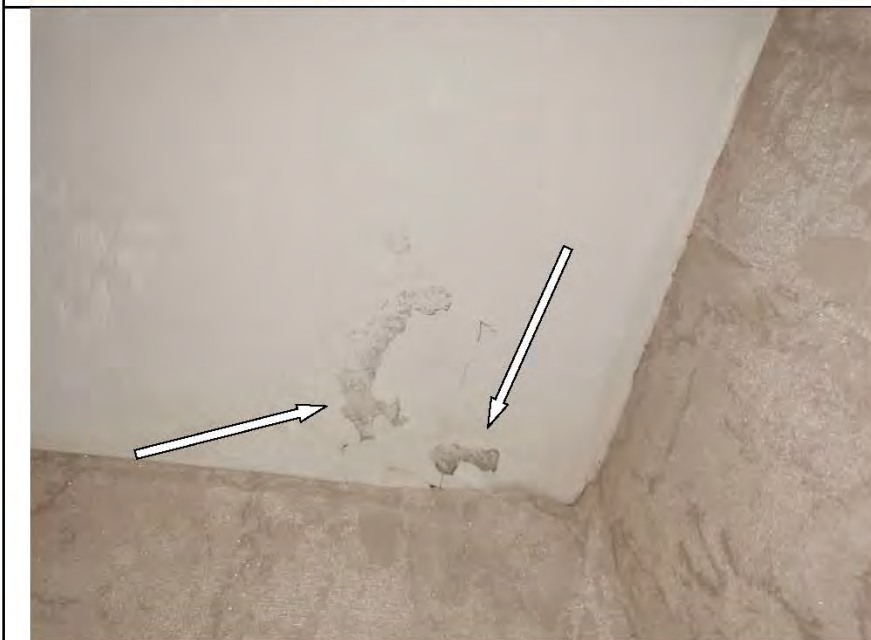
Фото №43. Следы залития на потолке в коридоре (отслоения, разрушение штукатурного слоя, поражение грибком).
