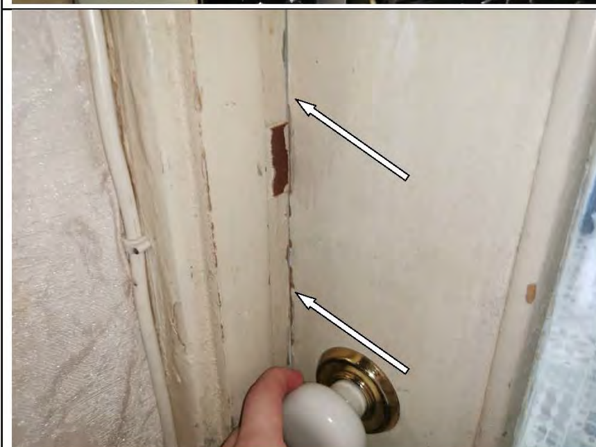
Фото №58. Полотно деревянного дверного блока деформировано в кухне.
