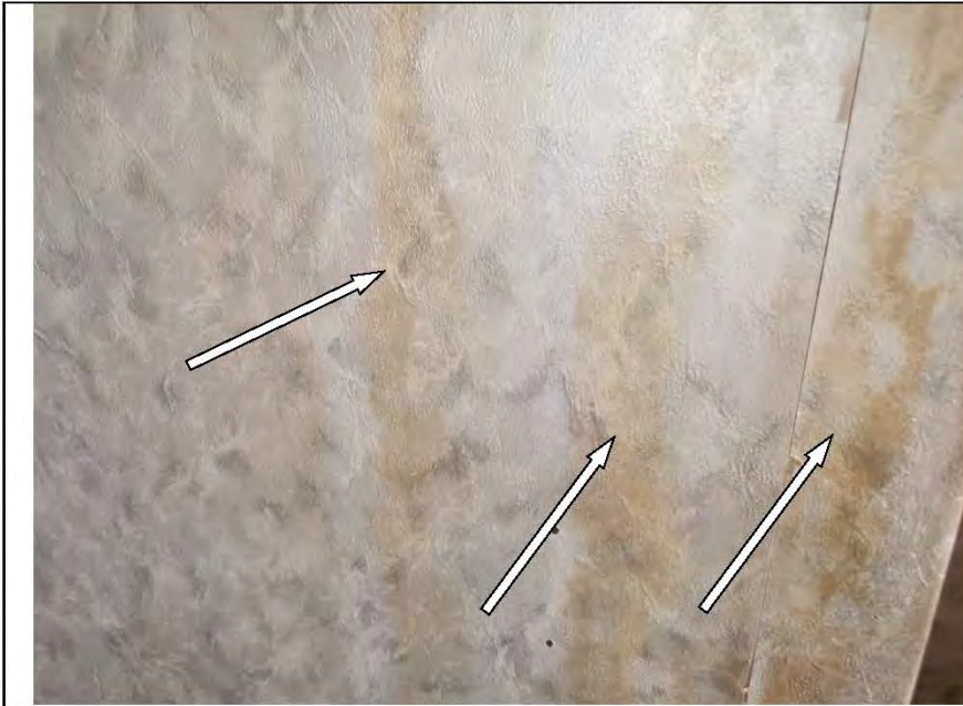
Фото №27. Следы залития обоевого полотна в спальне (вздутия, отслоения, поражение грибком).
