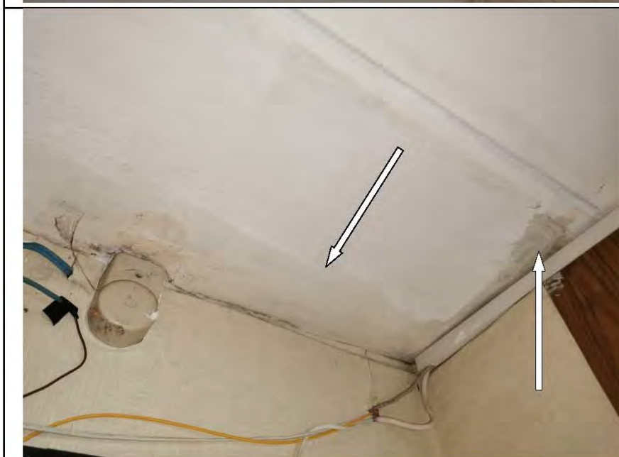
Фото №46. Следы залития на потолке в коридоре (отслоения, разрушение штукатурного слоя, поражение грибком).
