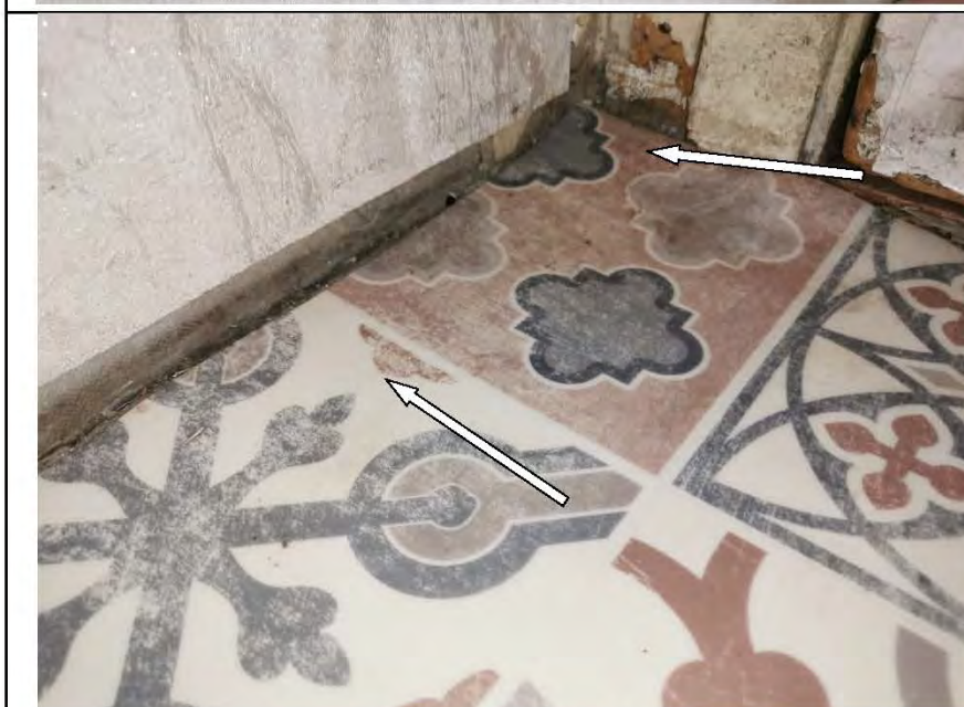
Фото №31. Следы залития на линолеуме в коридоре (вздутия, отслоения).
