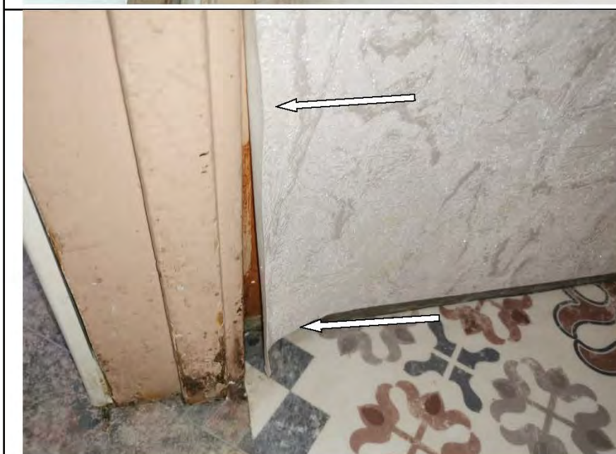
Фото №11. Следы залипания обоевого полотна в коридоре (вздутия, отслоения).
