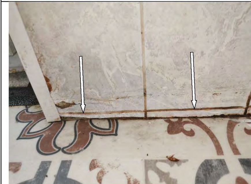
Фото №19. Следы заливания обоечного полотна в кухне (вздутия, отслоения).
