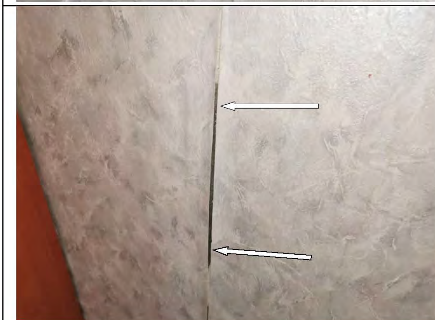
Фото №22. Следы залипания обоевого полотна в спальне (вздутия, отслоения).
