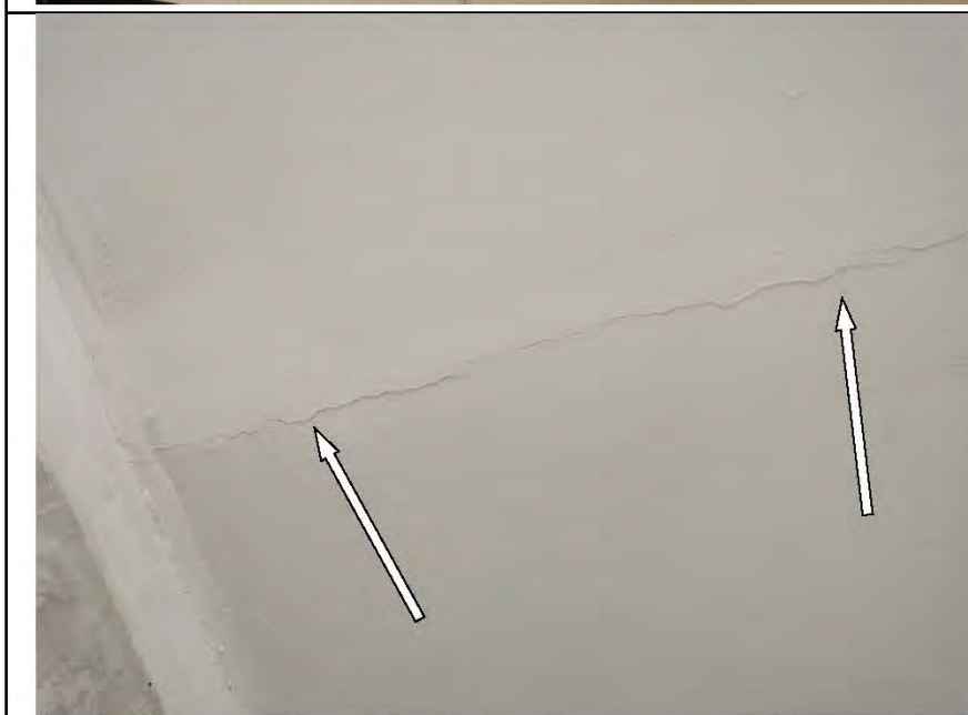
Фото №47. Следы залития на потолке в кухне (отслоения, трещины).
