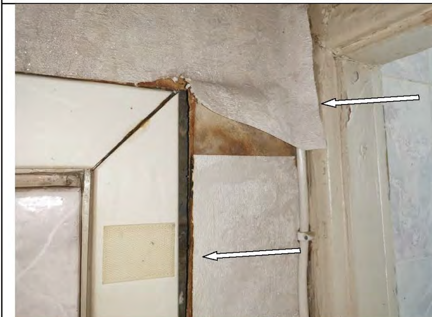
Фото №13. Следы залития обойного полотна в коридоре (вздутия, отслоения).
