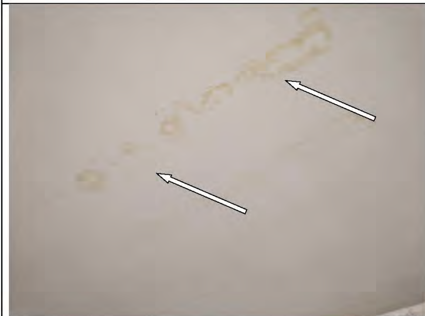
Фото №52. Следы залития на потолке в спальне (поражение грибком).
