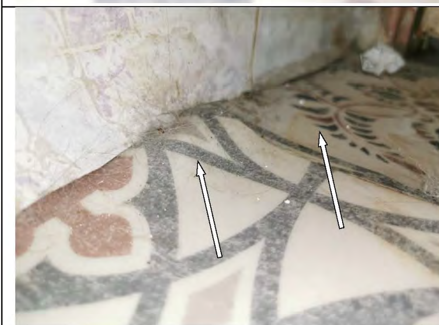
Фото №38. Следы залития на линолеуме в кухне (вздутя, отслоения).
