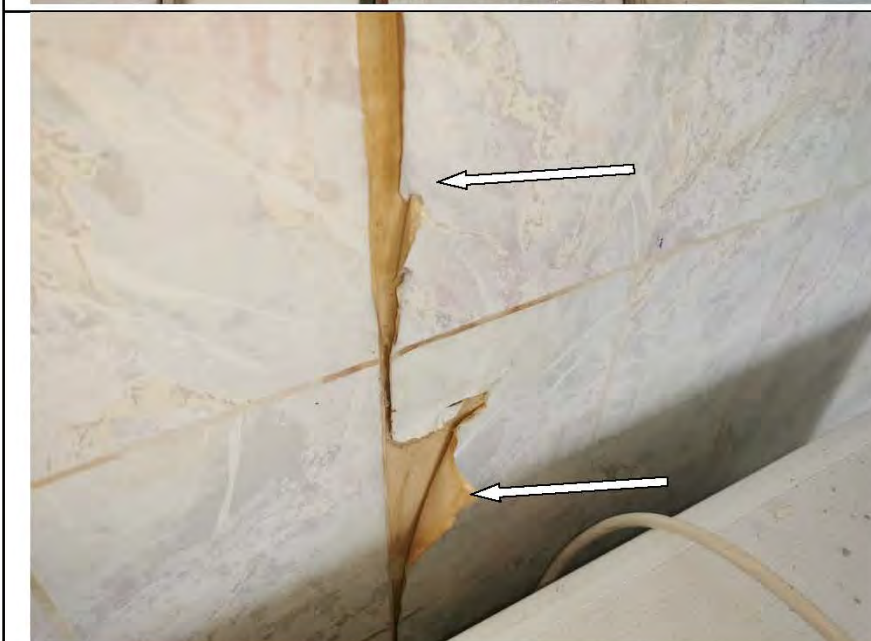
Фото №14. Следы залития обойного полотна в кухне (вздутия, отслоения).
