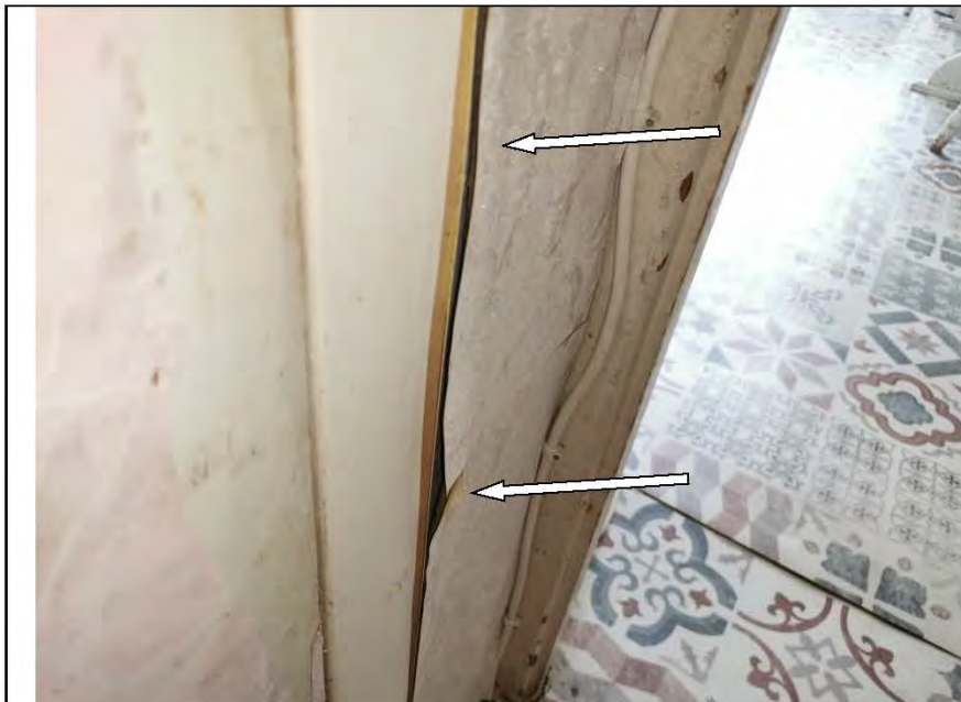
Фото №9. Следы залипания обоевого полотна в коридоре (вздутия, отслоения).
