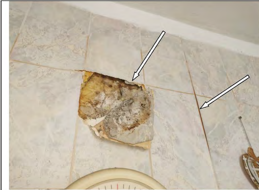
Фото №15. Следы заливания обойного полотна в кухне (вздутия, отслоения).
