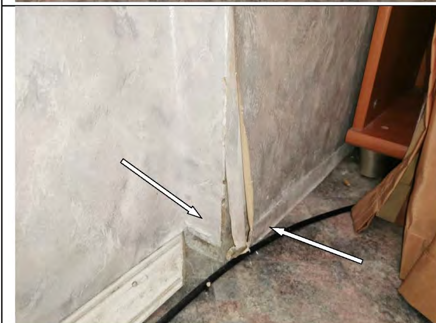
Фото №29. Следы залития обоевого полотна в спальне (вздутия, отслоения).
