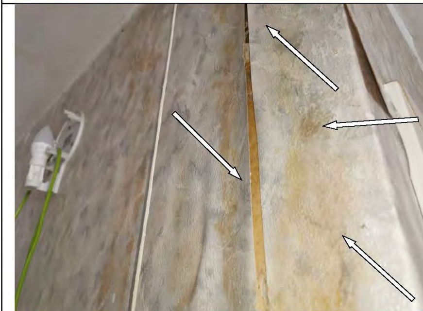
Фото №25. Следы заливания обоевого полотна в спальне (вздутия, отслоения, поражение грибком).
