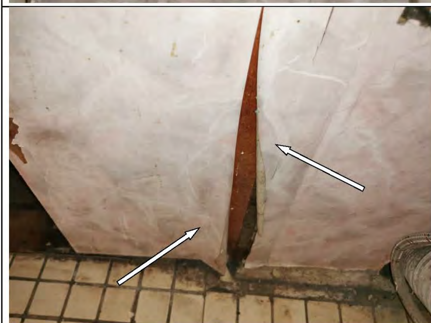
Фото №61. Стены, оклеенные самоклящейся пленкой, в санузле имеют дефекты характерные последствиям залива (вздутия, отслоения).
