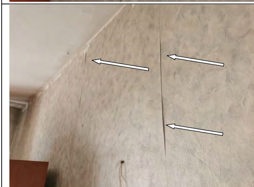
Фото №23. Следы залипания обоевого полотна в спальне (вздутия, отслоения).
