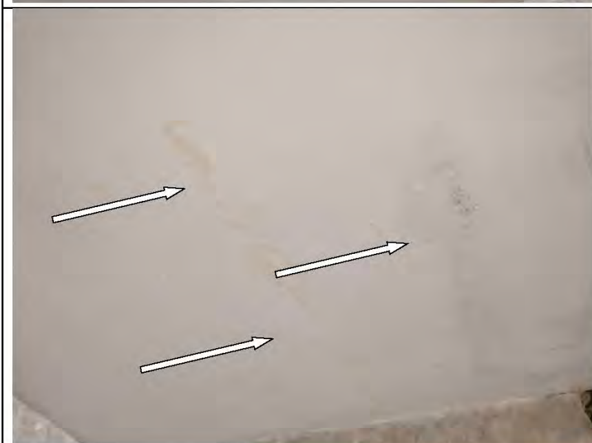
Фото №53. Следы залития на потолке в спальне (поражение грибком).
