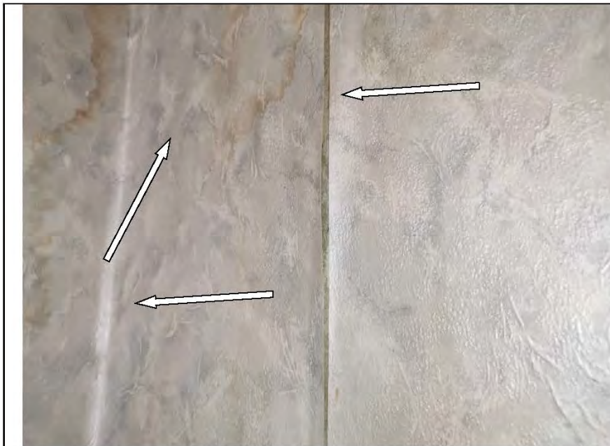
Фото №21. Следы залипания обоевого полотна в спальне (вздутия, отслоения).
