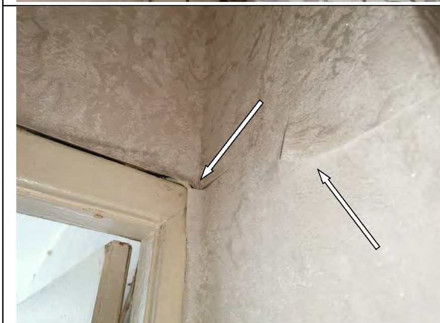
Фото №10. Следы залипания обоевого полотна в коридоре (вздутия, отслоения).
