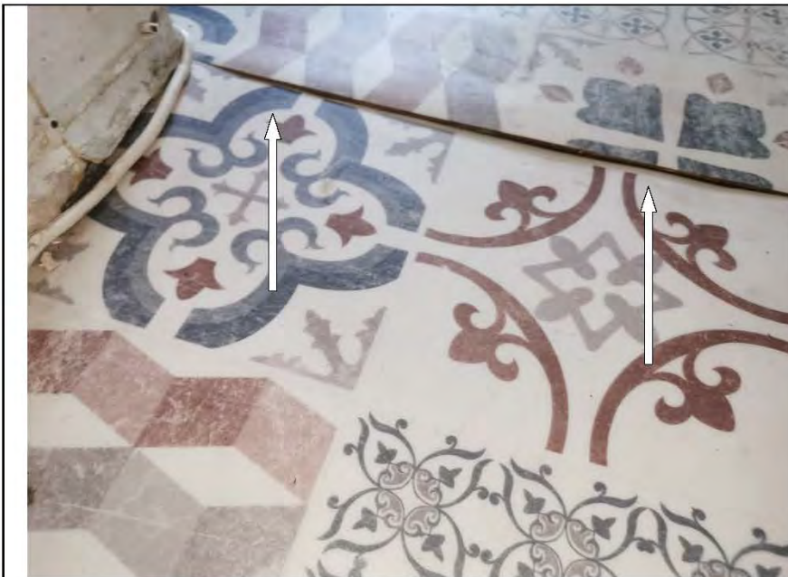
Фото №33. Следы залития на линолеуме в коридоре (вздутия, отслоения).
