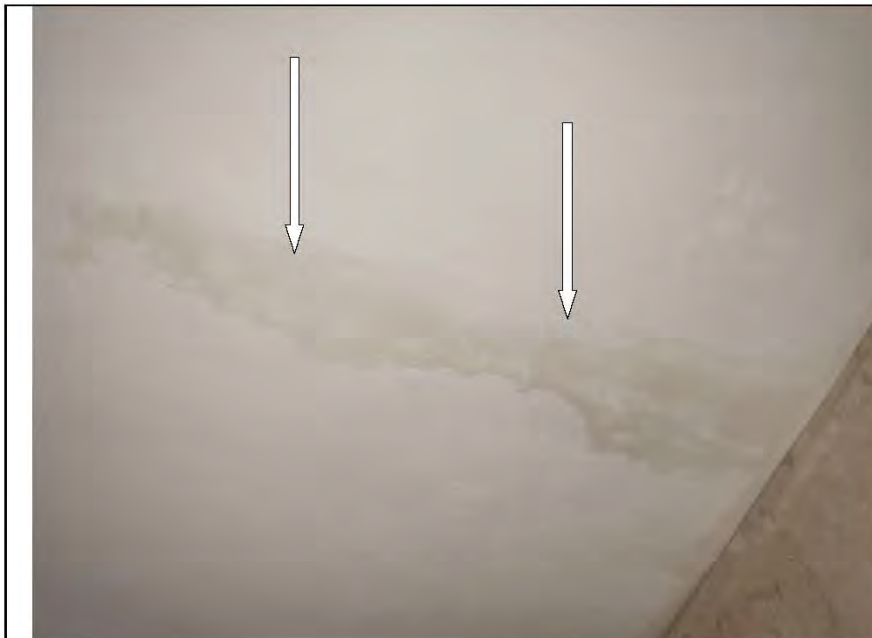
Фото №45. Следы залития на потолке в коридоре (поражение грибком).
