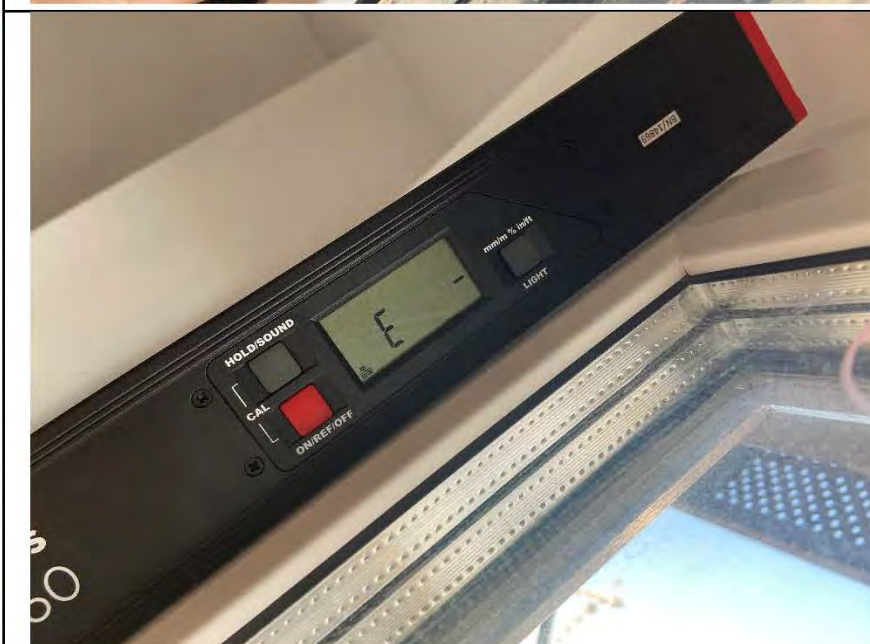
Фото №47. Отклонения по вертикали оконного блока ПВХ в спальне.
