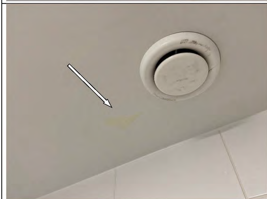
Фото №65. Загрязнения на подвесном потолке в ванной комнате.
