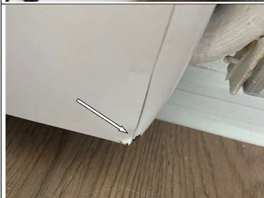
Фото №71. Дефект на металлическом кожухе отопительного прибора в спальне.
