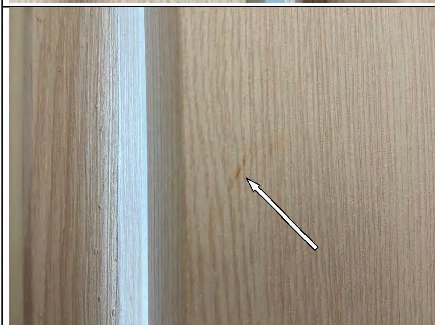
Фото №53. Загрязнения на полотне деревянного дверного блока в кабинете.
