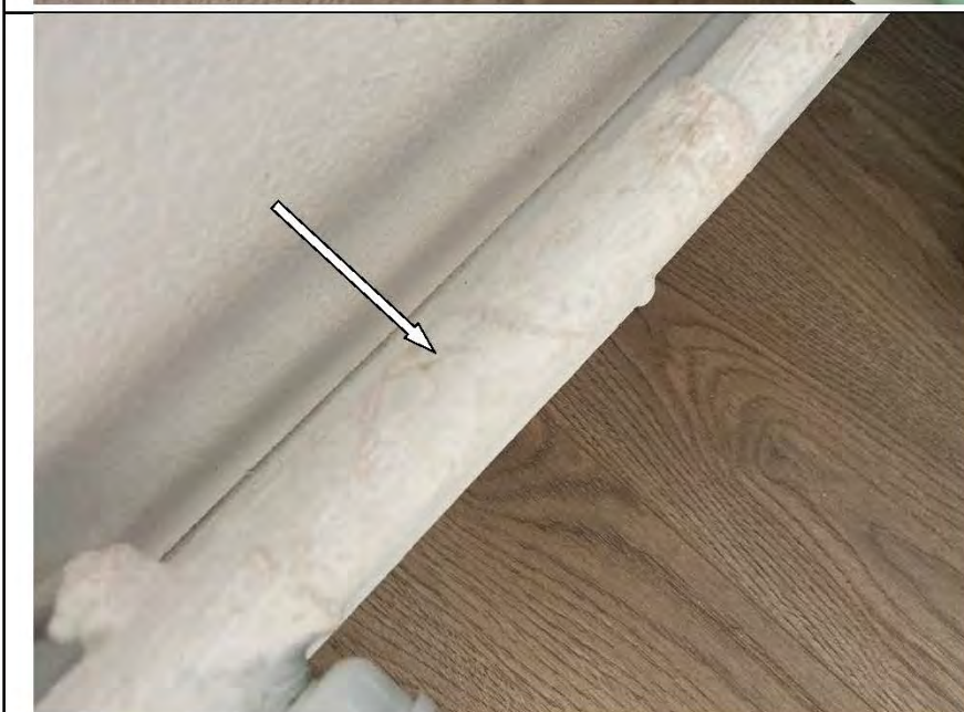
Фото №45. Неровности, подтеки на окрашенных трубах отопления в кабинете.
