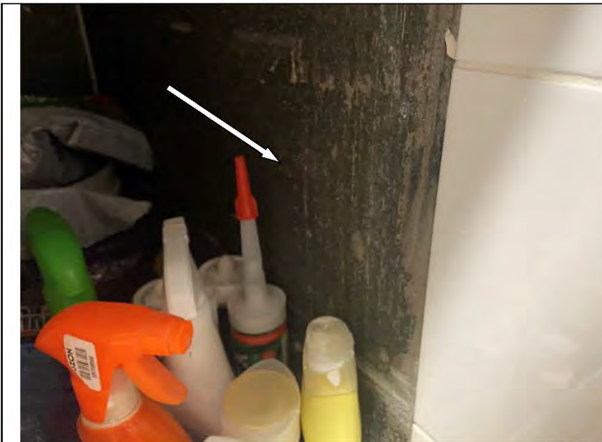
Фото №16. Частично отсутствует настенная керамическая плитка в ванной комнате.
