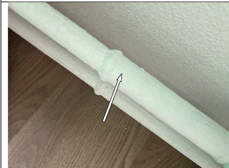
Фото №44. Неровности, подтеки на окрашенных трубах отопления в спальне.
