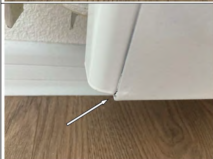
Фото №72. Дефект на металлическом кожухе отопительного прибора в кабинете.
