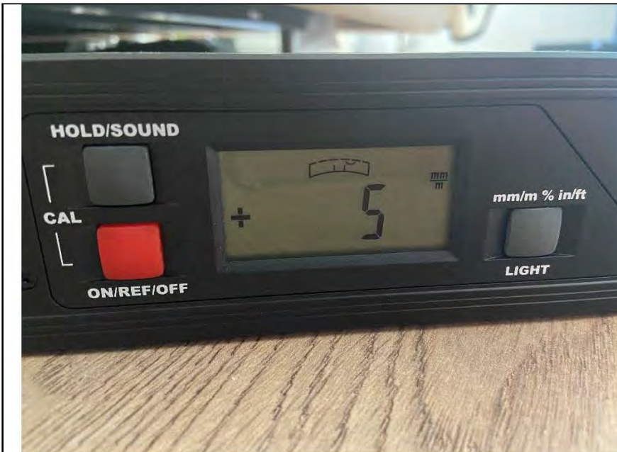
Фото №19. Отклонение напольного покрытия из ламината в спальне.
