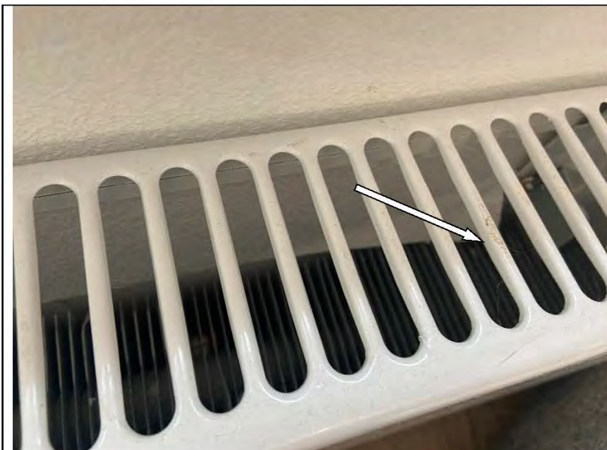
Фото №70. Дефект на металлическом кожухе отопительного прибора в кухне.
