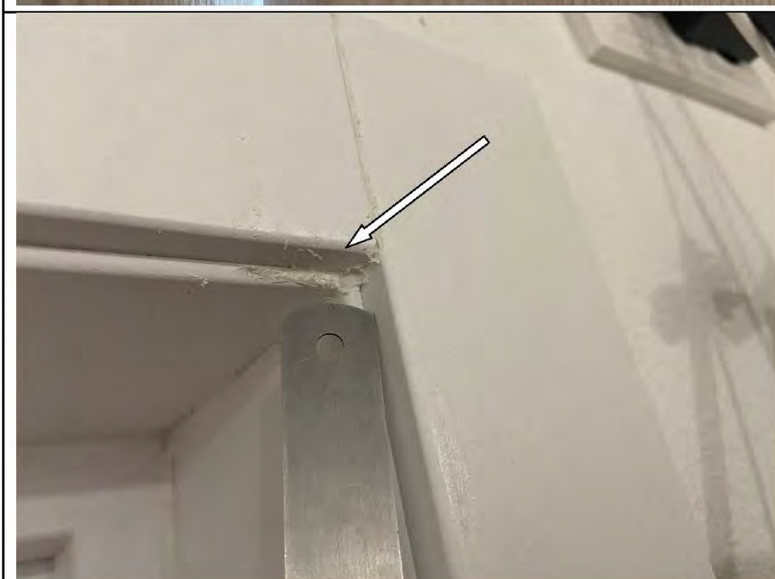
Фото №54. Царапина на наличниках входного дверного блока в коридоре.
