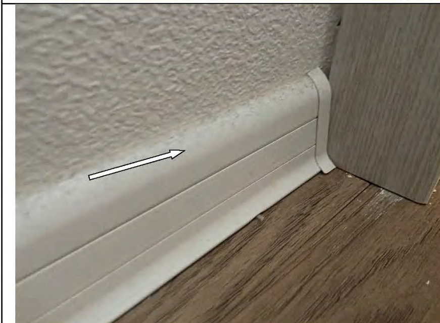
Фото №26. Дефект на напольном плинтусе ПВХ в спальне.
