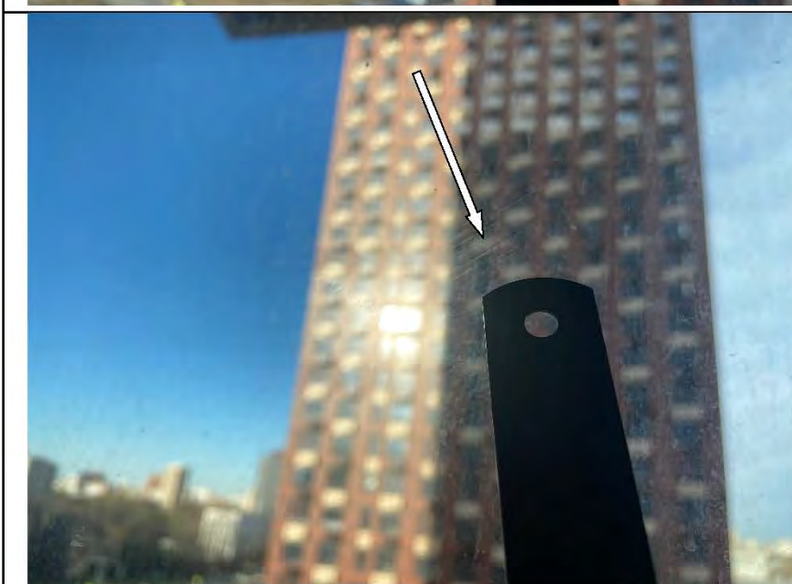
Фото №42. Царапина на стеклопакете оконного блока ПВХ в кабинете.
