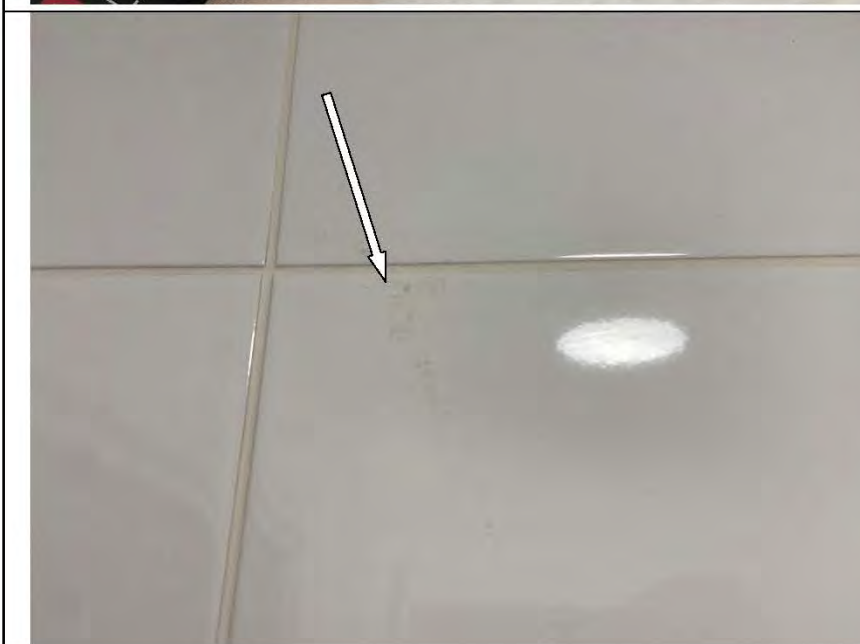
Фото №12. Загрязнения на настенной керамической плитке в санузле.
