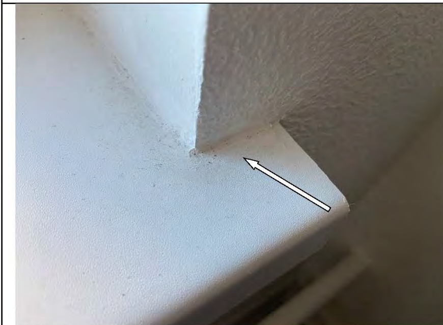
Фото №36. Царапина на лицевой стороне подоконной доски в кабинете.
