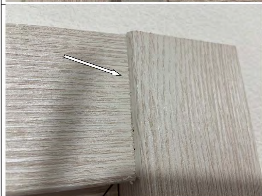
Фото №57. Загрязнения на наличниках деревянного дверного блока в спальне.
