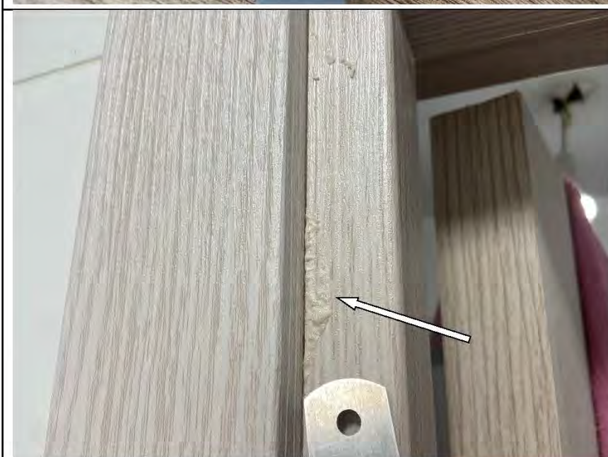
Фото №60. Загрязнения на коробке деревянного дверного блока в санузле.
