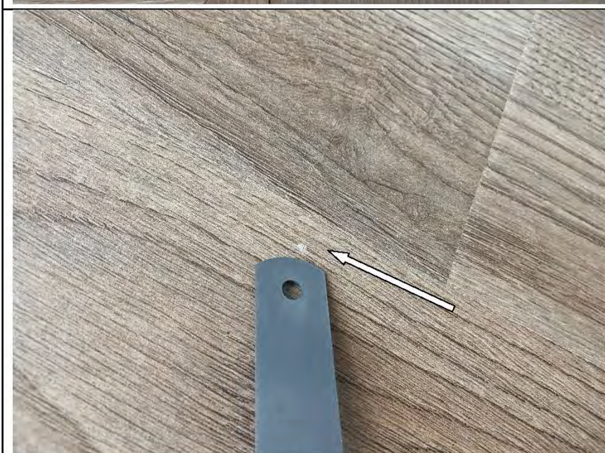
Фото №59. Дефект на напольном покрытии из ламината в кухне.
