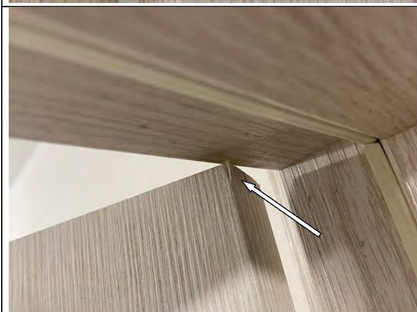
Фото №51. Скол на полотне деревянного дверного блока в ванной комнате.
