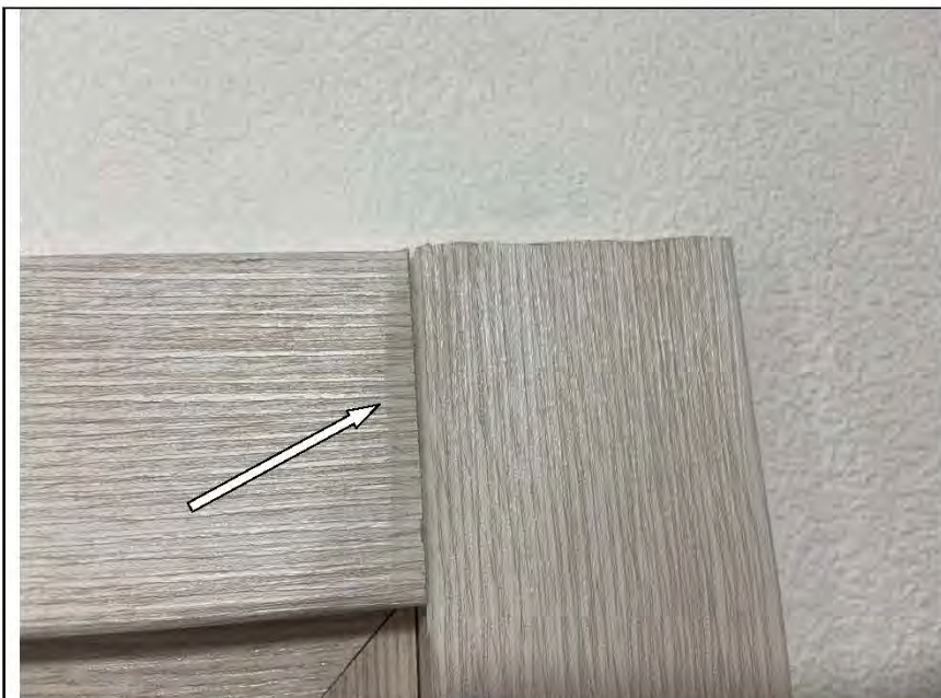
Фото №58. Загрязнения на наличниках деревянного дверного блока в кабинете.
