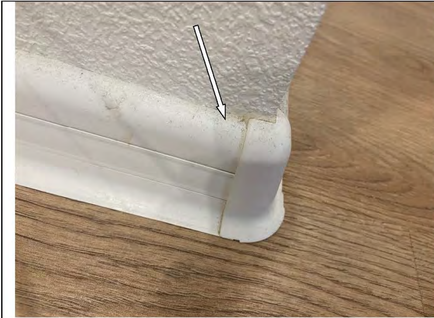
Фото №25. Дефект на напольном плинтусе ПВХ в кухне.
