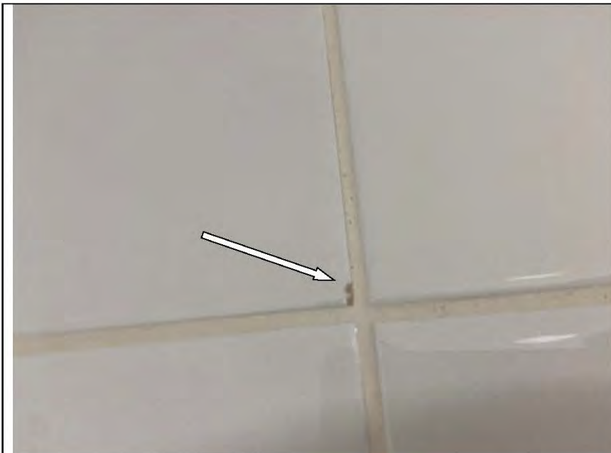
Фото №76. Скол на настенной керамической плитке в санузле.
