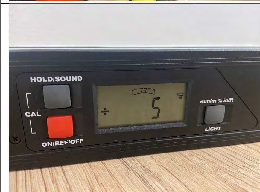
Фото №17. Отклонения напольного покрытия из ламината в коридоре.
