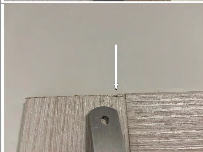
Фото №56. Скол на наличниках деревянного дверного блока в ванной комнате.
