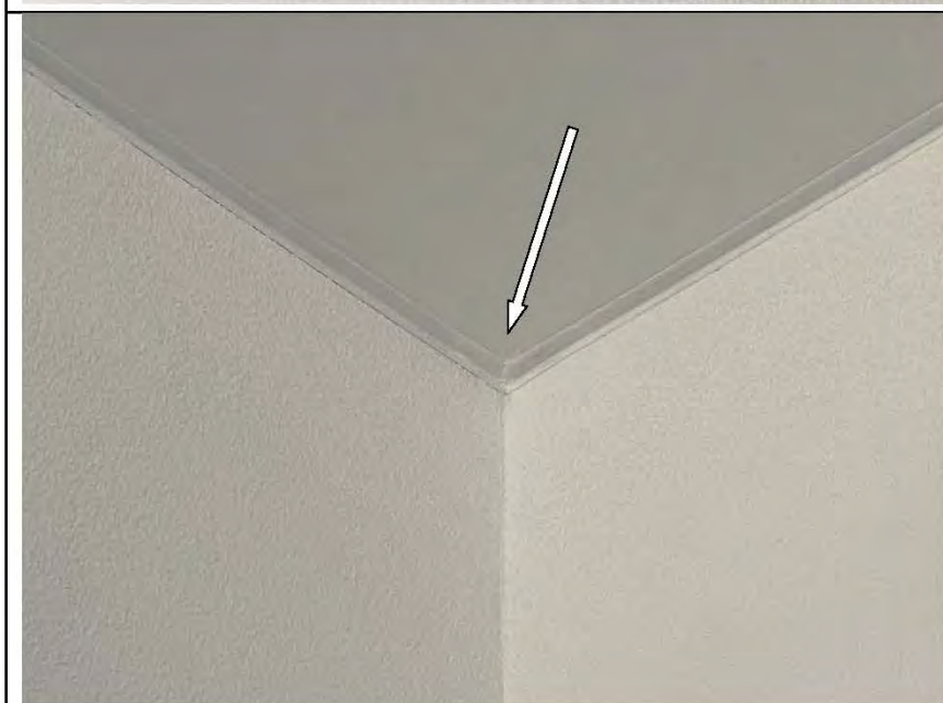
Фото №68. Загрязнения на полотне натяжного потолка в спальне.
