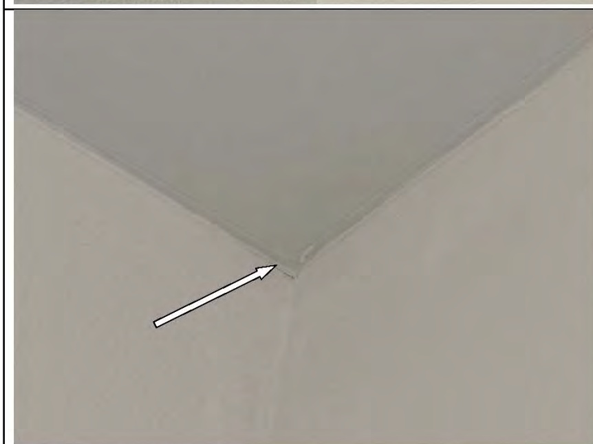
Фото №69. Загрязнения на полотне натяжного потолка в кабинете.
