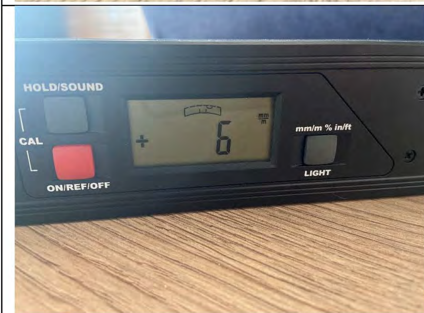
Фото №20. Отклонение напольного покрытия из ламината в кабинете.
