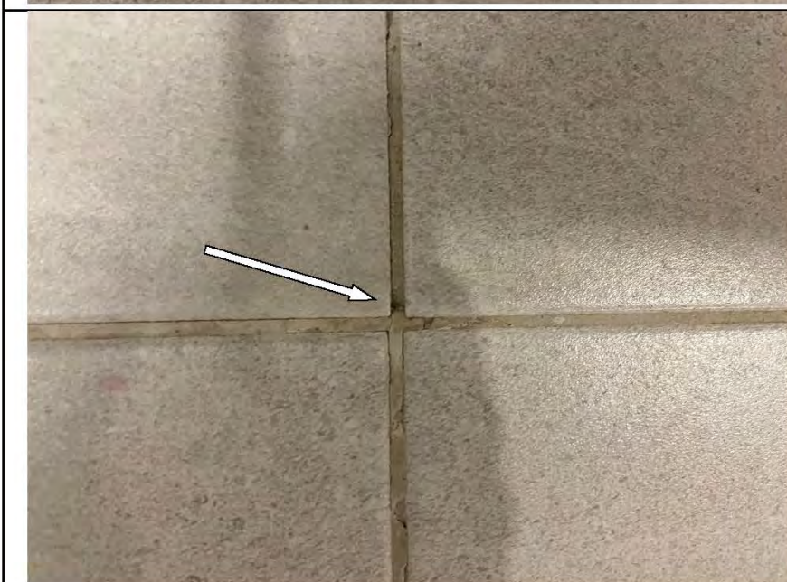
Фото №24. Неровные швы напольной керамической плитки в ванной комнате.
