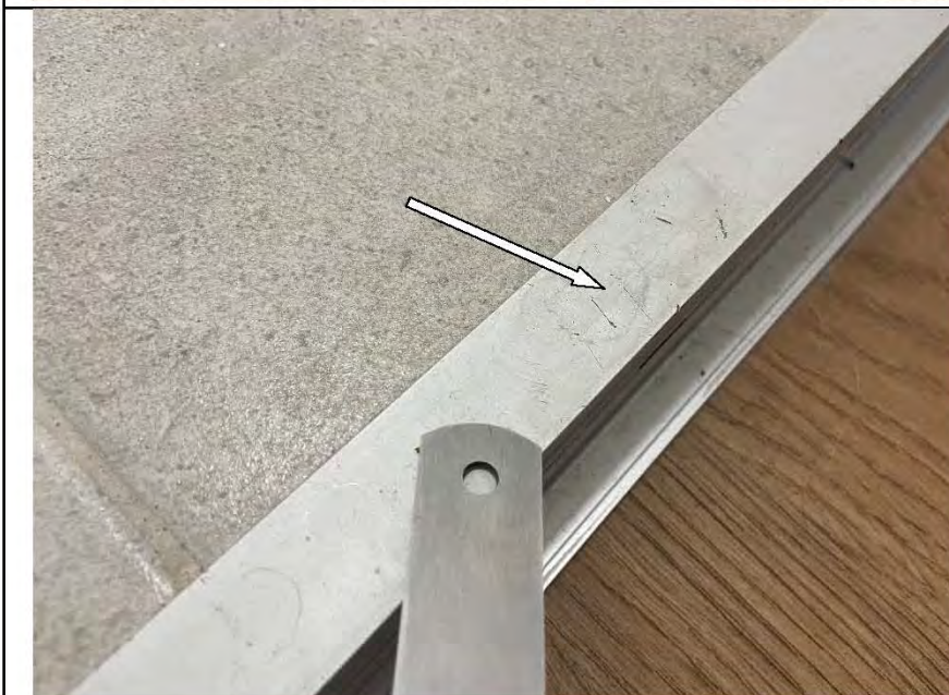
Фото №32. Дефект на напольном металлическом плинтусе в санузле.
