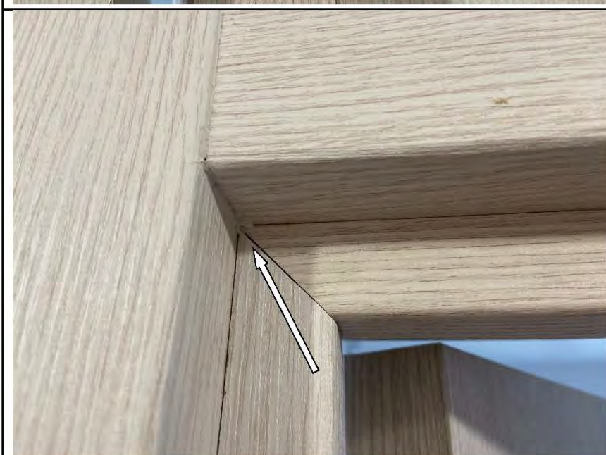
Фото №63. Загрязнения на коробке деревянного дверного блока в кабинете.
