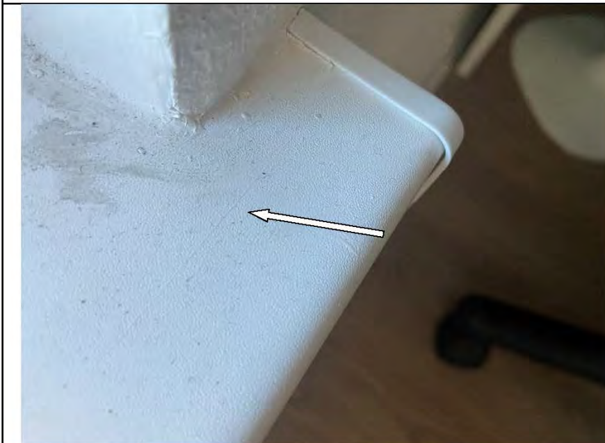
Фото №35. Царапина на лицевой стороне подоконной доски в спальне.
