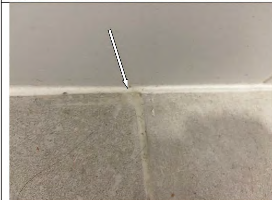
Фото №23. Неровные швы напольной керамической плитки в санузле.
