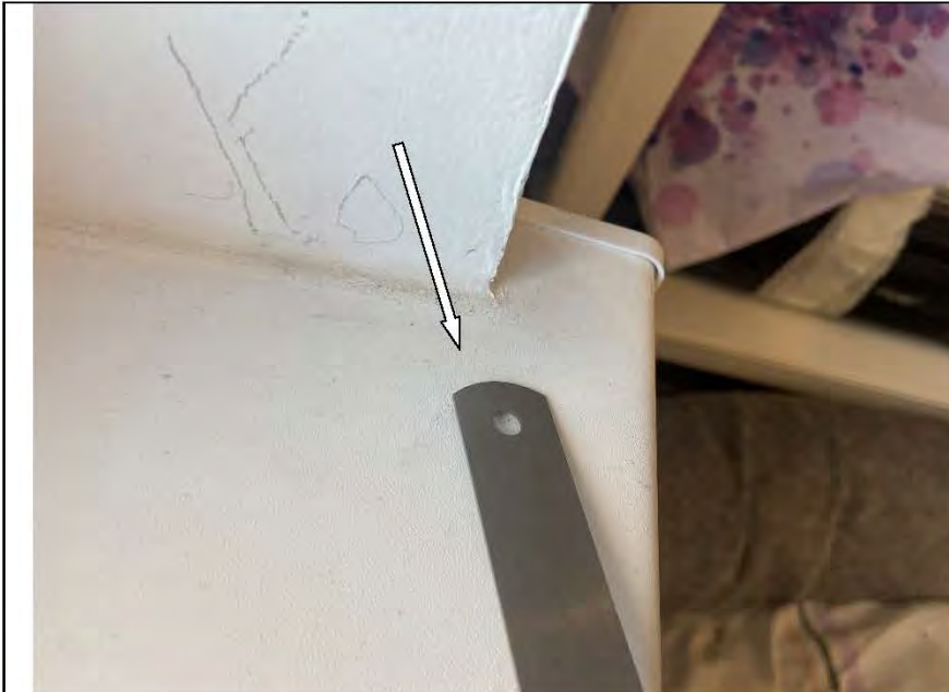
Фото №34. Царапина на лицевой стороне подоконной доски в кухне.
