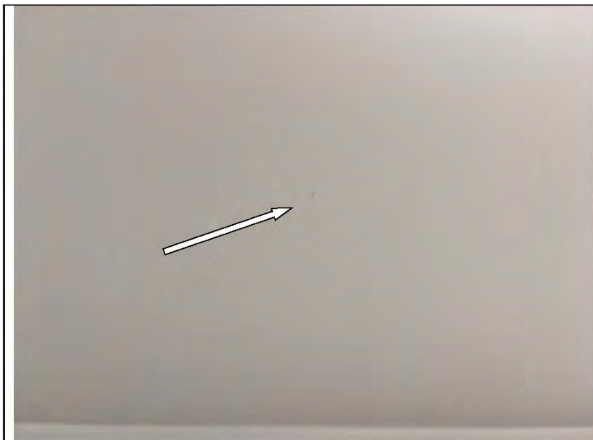
Фото №64. Загрязнения на подвесном потолке в санузле.
