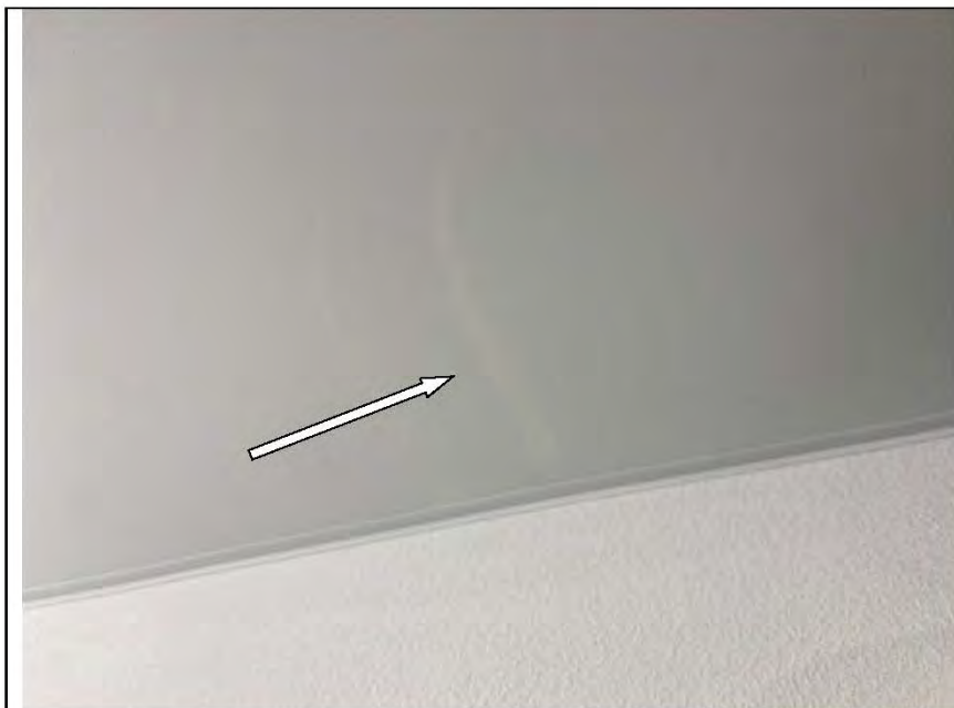
Фото №67. Загрязнения на полотне натяжного потолка в кухне.
