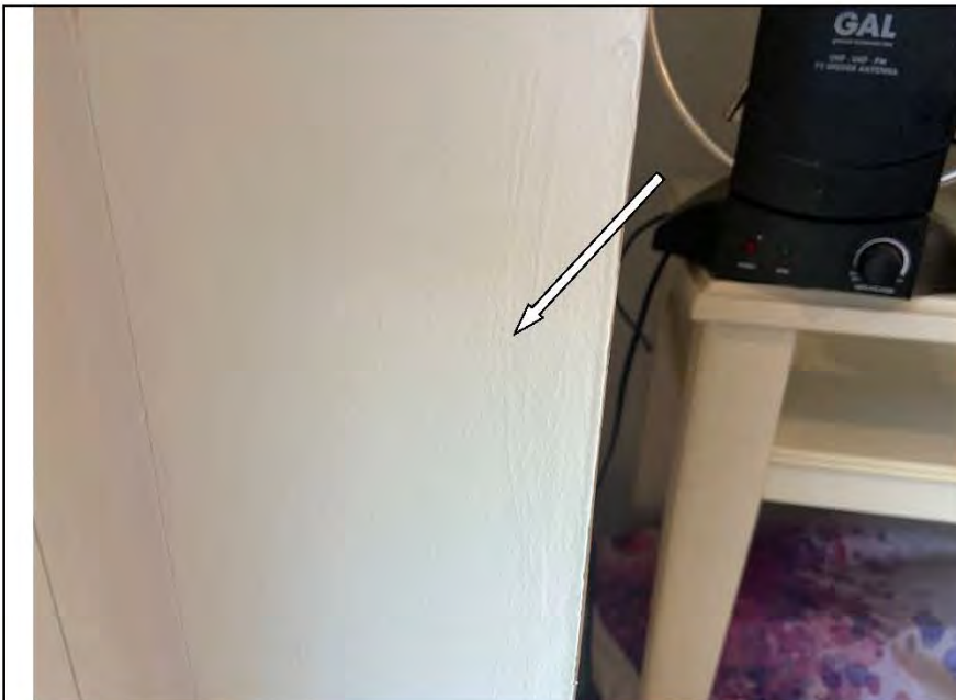
Фото №37. Неровности, выбоины, подтеки на окрашенных откосах оконного блока ПВХ в кухне.
