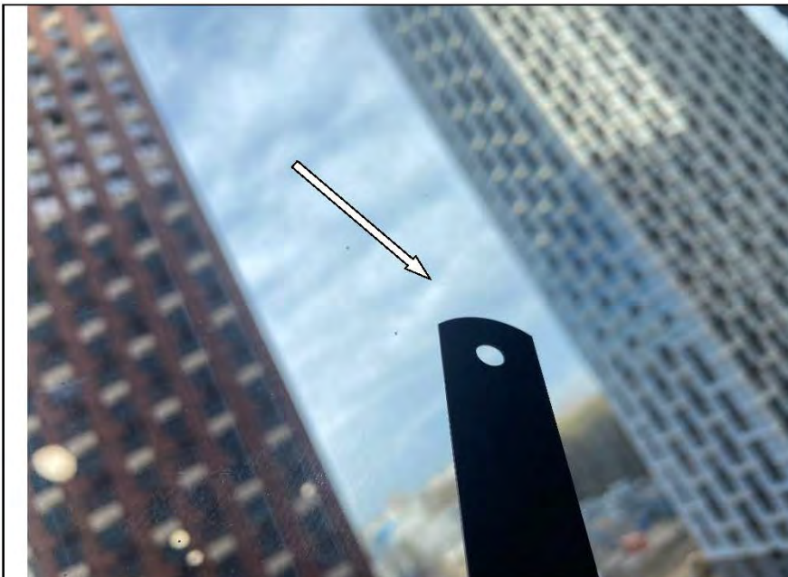
Фото №40. Царапина на стеклопакете оконного блока ПВХ в кухне.
