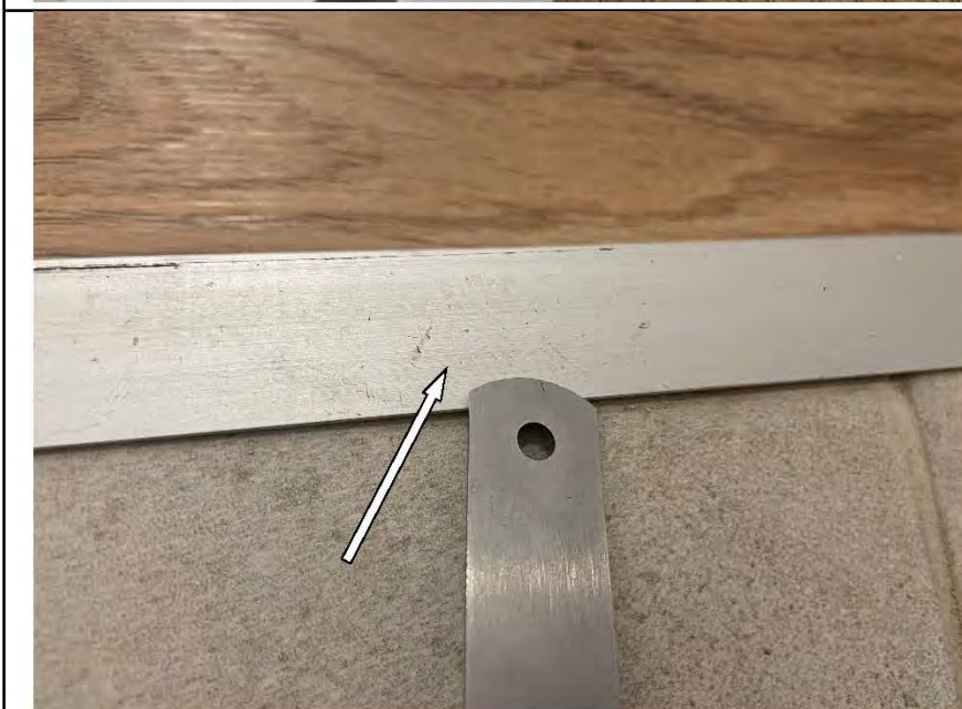
Фото №33. Дефект на напольном металлическом плинтусе в ванной комнате.
