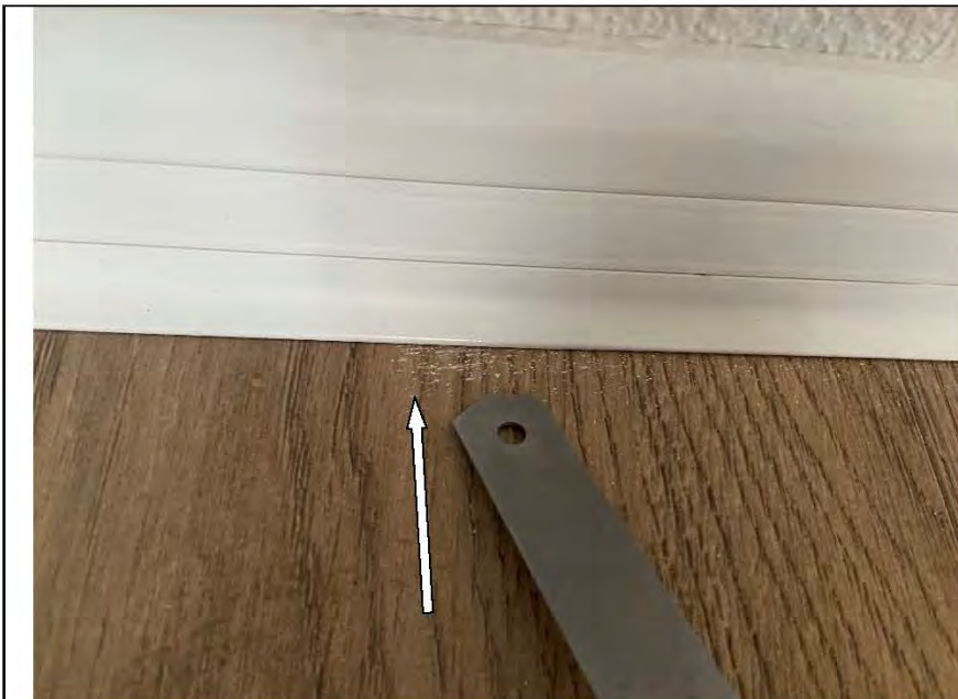
Фото №31. Дефект на напольном покрытии из ламината в кабинете.
