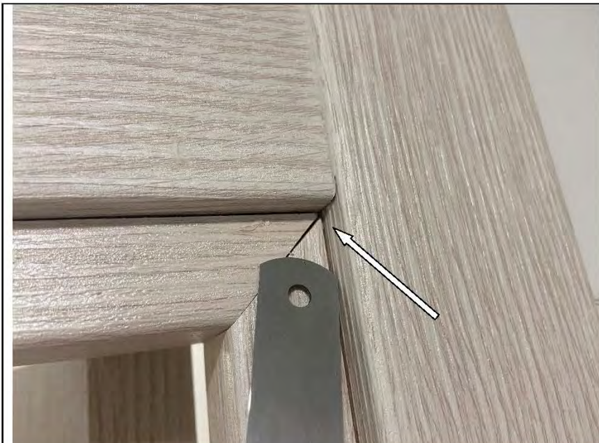
Фото №61. Скол на коробке деревянного дверного блока в ванной комнате.
