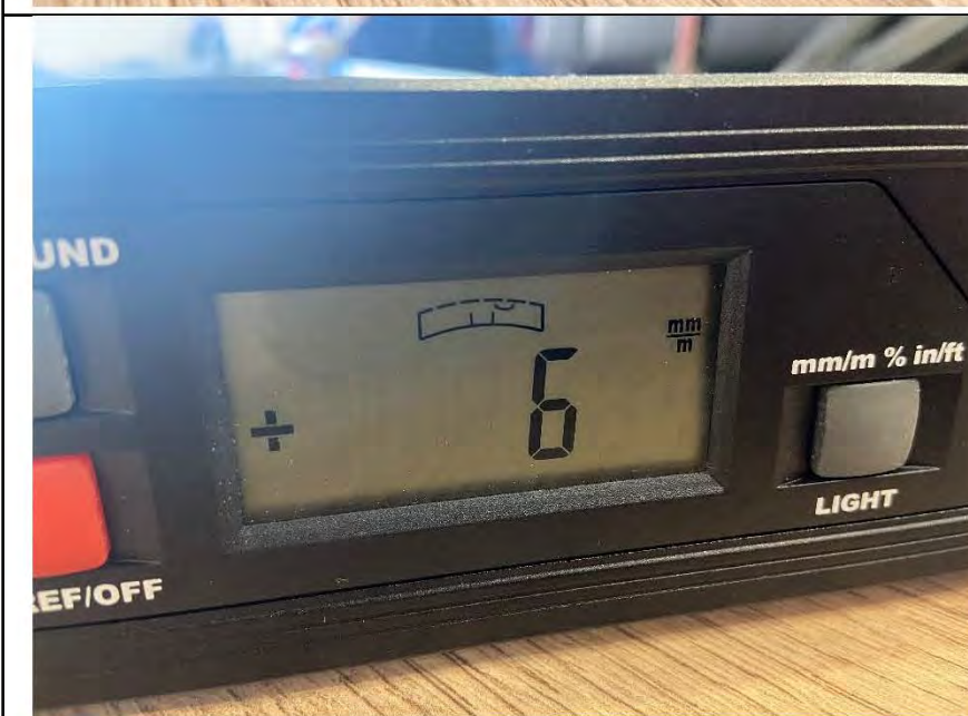
Фото №18. Отклонения напольного покрытия из ламината в кухне.
