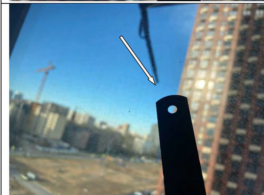
Фото №41. Царапина на стеклопакете оконного блока ПВХ в спальне.
