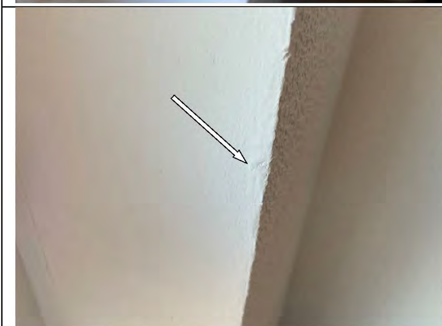
Фото №39. Неровности, выбоины, подтеки на окрашенных откосах оконного блока ПВХ в кабинете.
