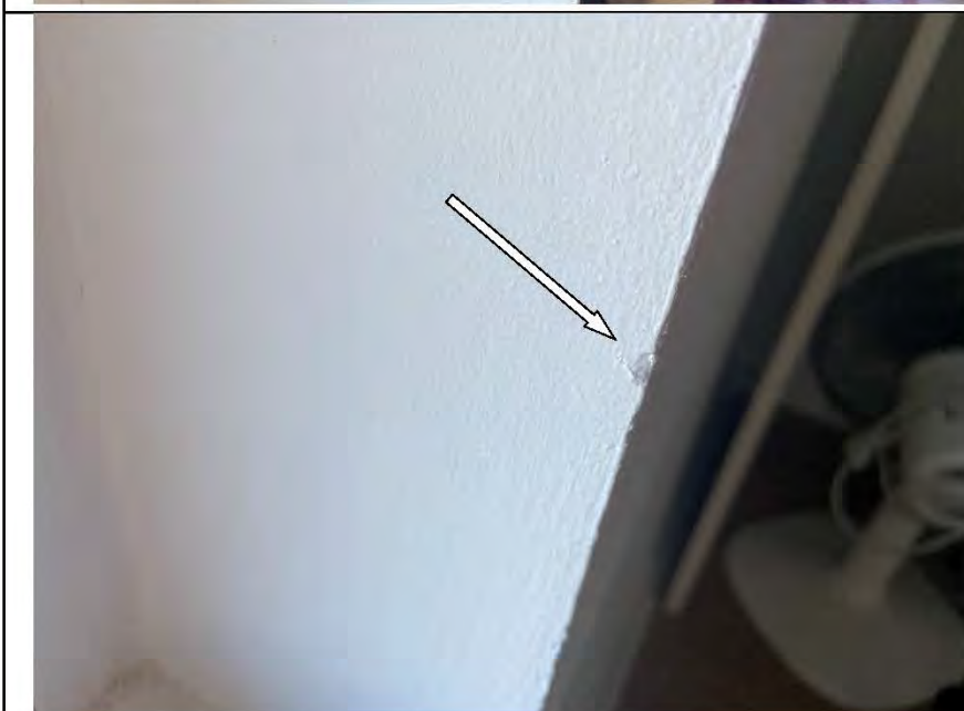
Фото №38. Неровности, выбоины, подтеки на окрашенных откосах оконного блока ПВХ в спальне.
