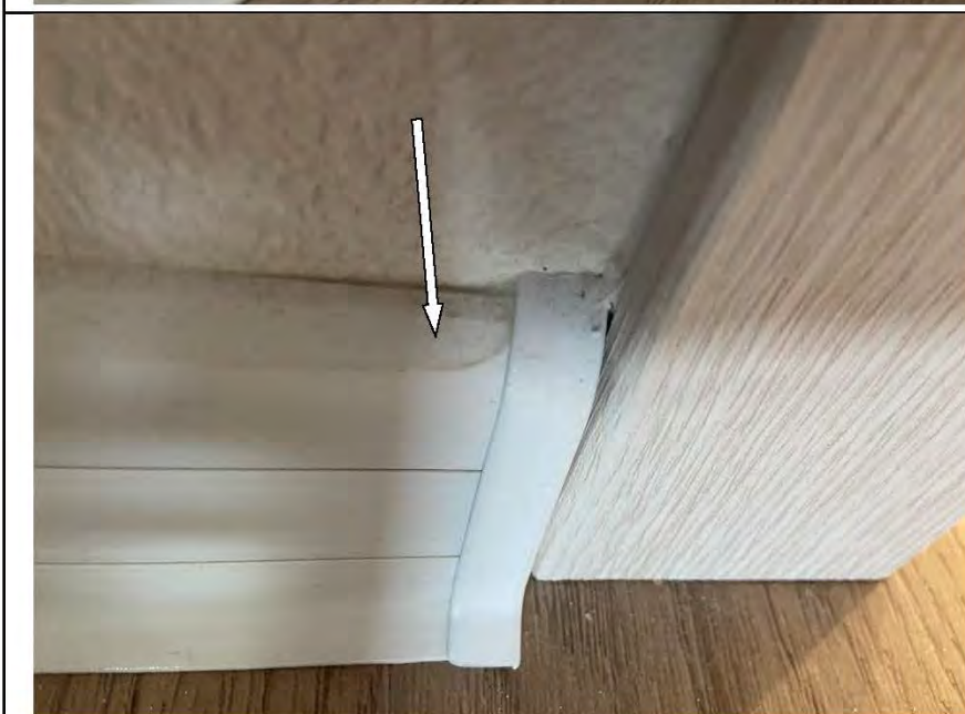
Фото №27. Дефект на напольном плинтусе ПВХ в кабинете.
