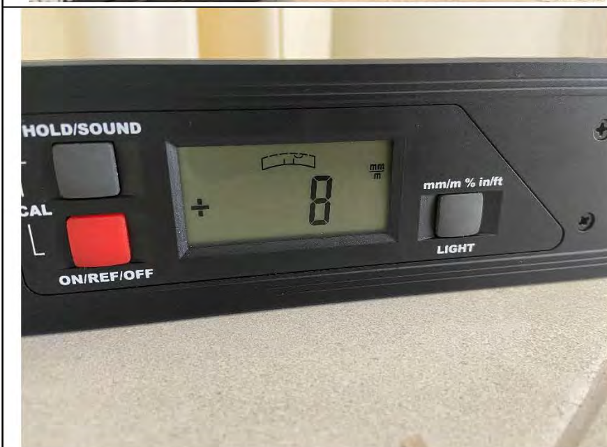
Фото №11. Отклонения на напольном покрытии из керамической плитки в ванной комнате.
