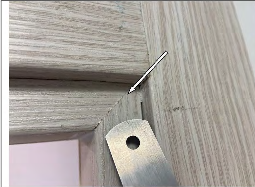
Фото №37. Дефект на коробке деревянного дверного блока в ванной комнате.
