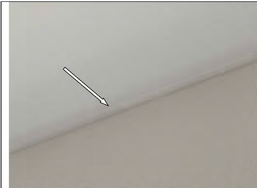
Фото №40. Загрязнения на полотне натяжного потолка в комнате.
