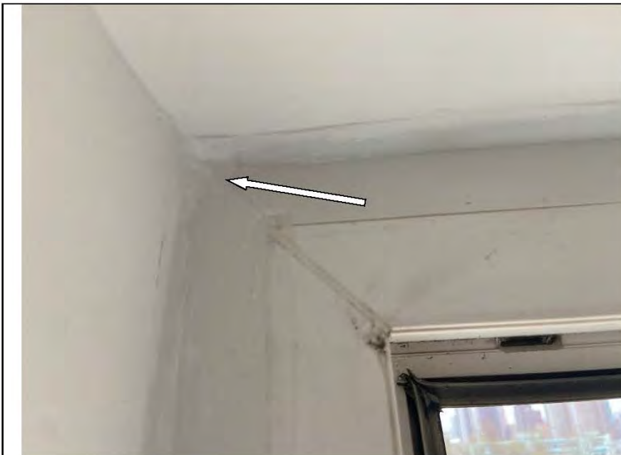
Фото №25. Загрязнения на профиле оконного блока ПВХ в комнате.
