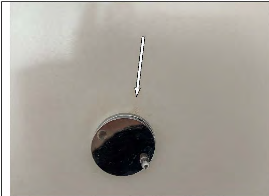
Фото №31. Загрязнения на полотне входного дверного блока ПВХ в коридоре.
