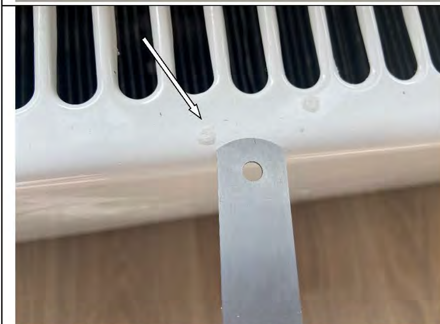
Фото №41. Загрязнения на металлическом кожухе отопительного прибора в комнате.
