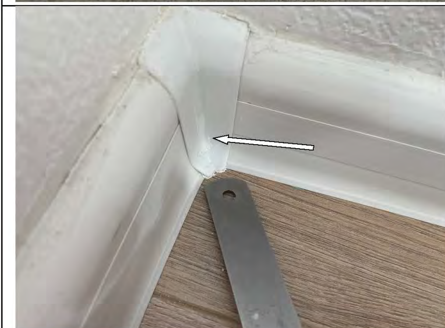
Фото №17. Загрязнения на напольном плинтусе ПВХ в комнате.
