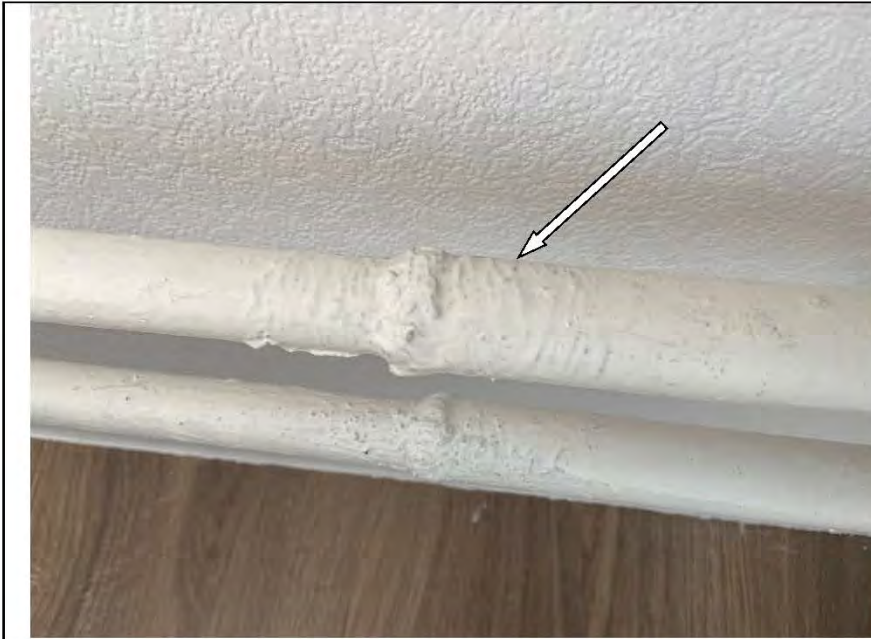
Фото №28. Неровности, подтеки на окрашенных трубах отопления в комнате.
