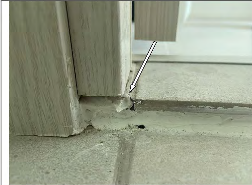
Фото №13. Загрязнение напольного покрытия из керамической плитки в ванной комнате.
