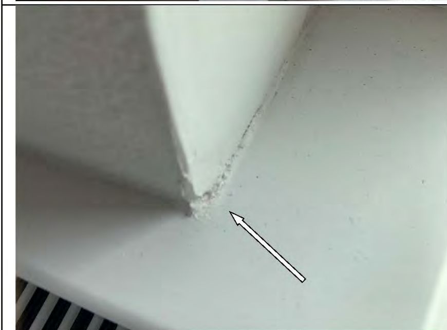
Фото №21. Царапина на лицевой стороне подоконной доски в комнате.
