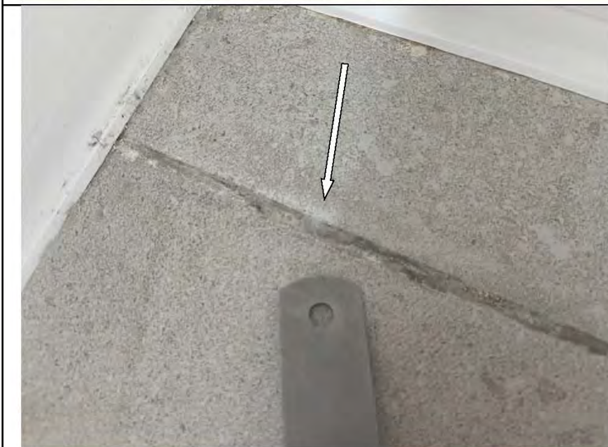
Фото №14. Неровные швы напольной керамической плитки в коридоре.
