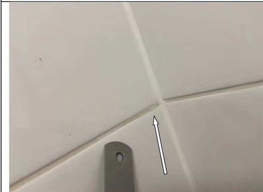
Фото №8. Неровные швы настенной керамической плитки в ванной комнате.
