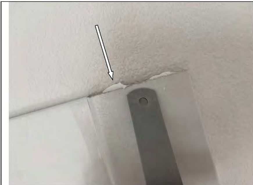
Фото №34. Загрязнения на наличниках входного дверного блока в коридоре.
