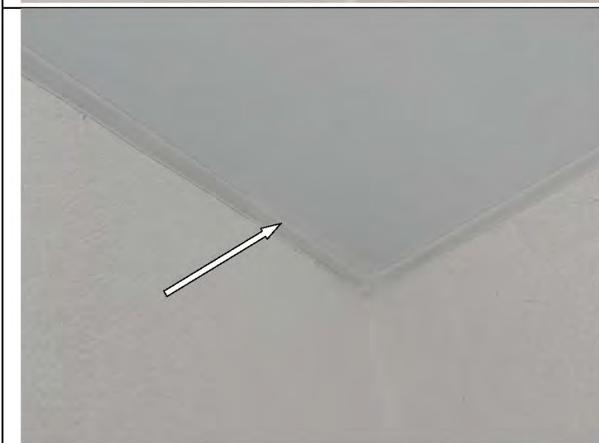
Фото №39. Загрязнения на полотне натяжного потолка в коридоре.
