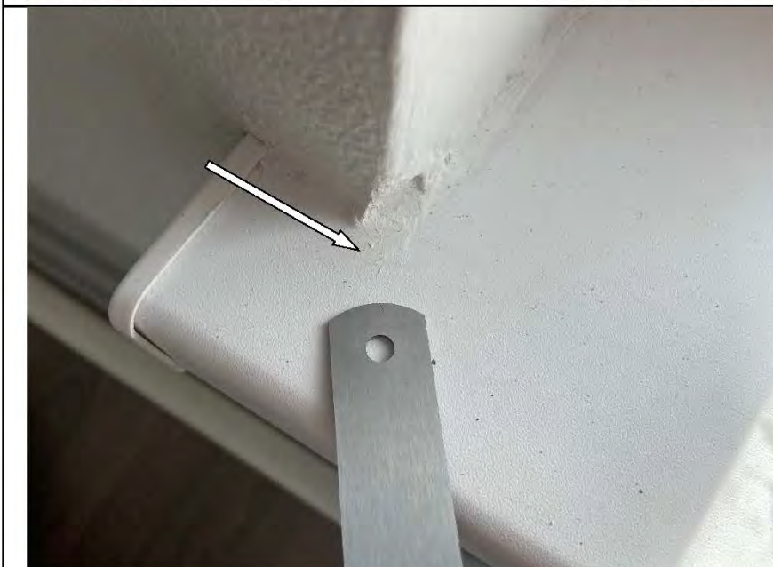
Фото №20. Царапина на лицевой стороне подоконной доски в комнате.
