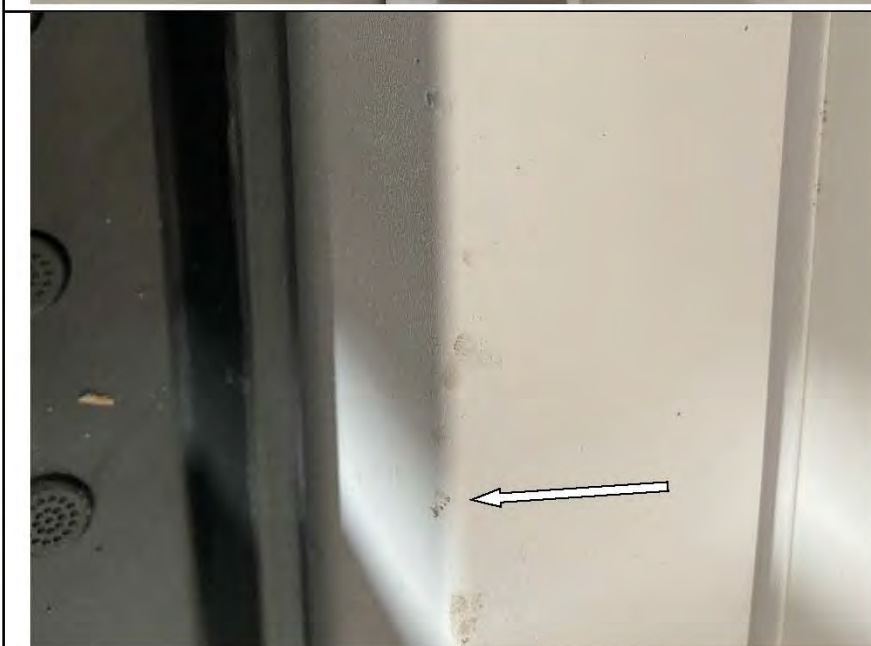
Фото №30. Сколы на коробке входного дверного блока в коридоре.
