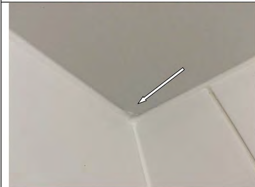
Фото №38. Загрязнения на подвесном потолке в ванной комнате.
