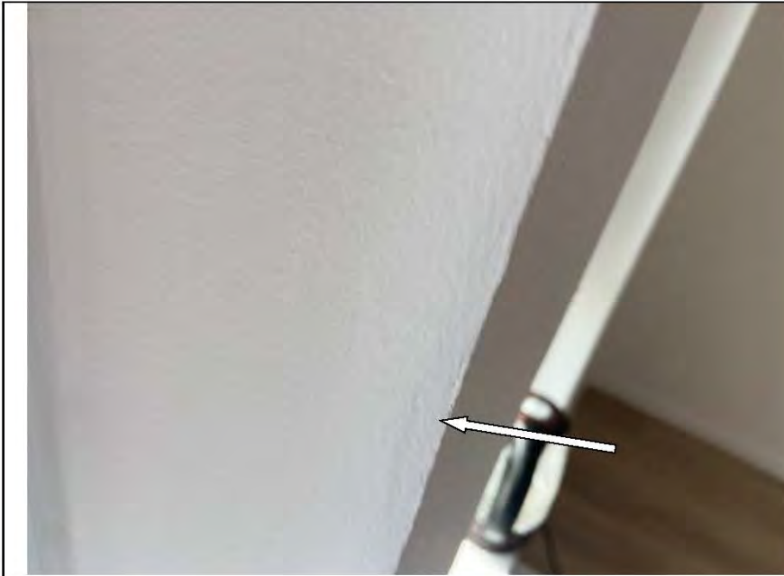
Фото №22. Неровности, выбоины, сколы на окрашенных откосах оконного блока ПВХ в комнате.
