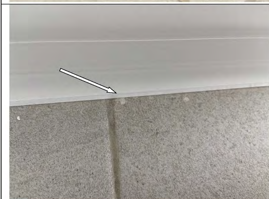
Фото №12. Загрязнение напольного покрытия из керамической плитки в коридоре.
