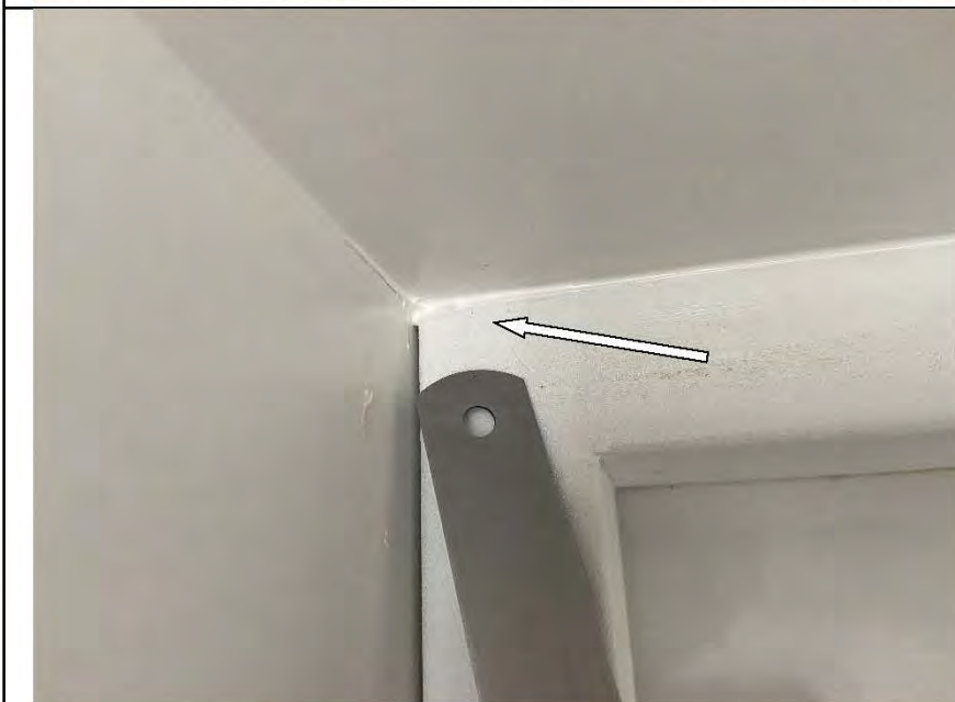
Фото №29. Загрязнения на коробке входного дверного блока в коридоре.
