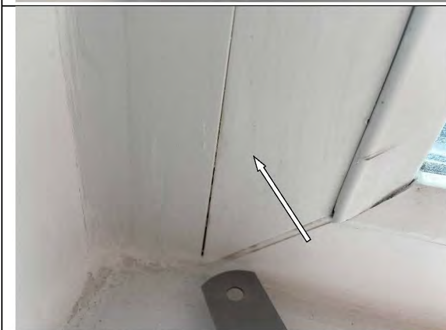
Фото №24. Загрязнения на профиле оконного блока ПВХ в комнате.
