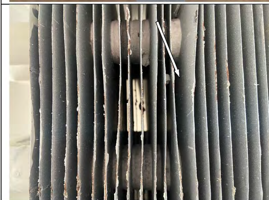
Фото №42. Загибы на радиаторе в комнате.
