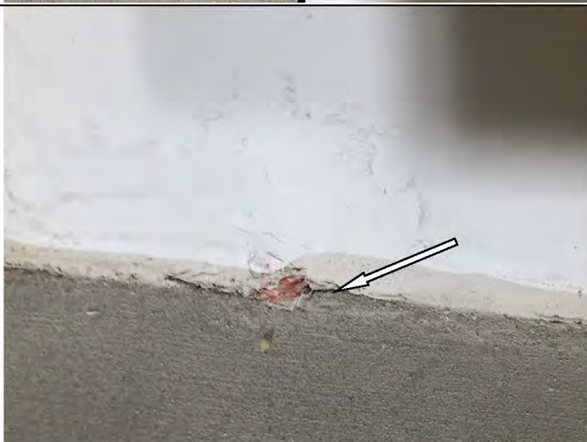
Фото №26. Не выполнен изолирующий шов в местах примыкания стен прихожей и стяжки пола.
