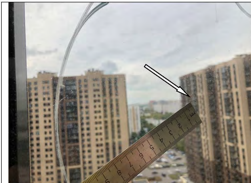
Фото №40. На стеклопакете оконного блока ПВХ на балконе имеется дефект (наличие воздушного пузыря).
