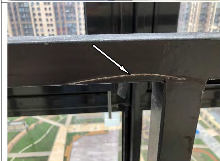
Фото №30. Царапины металлического профиля ограждающей конструкции на балконе.
