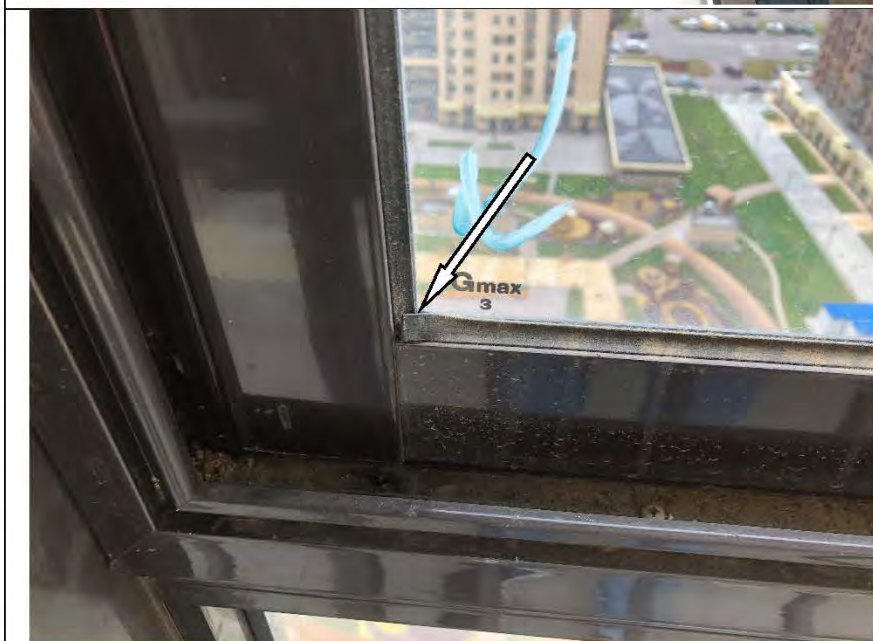
Фото №33. Дефект уплотняющей прокладки оконного блока ПВХ.
