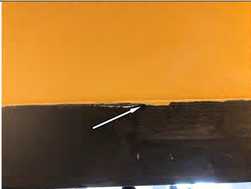
Фото №47. Наличник дверного блока входной двери выполнен с дефектами (разводы и брызги малярных составов).
