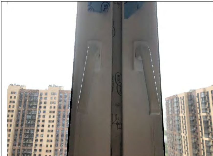
Фото №34. Не отрегулирована фурнитура оконного блока ПВХ в спальне.
