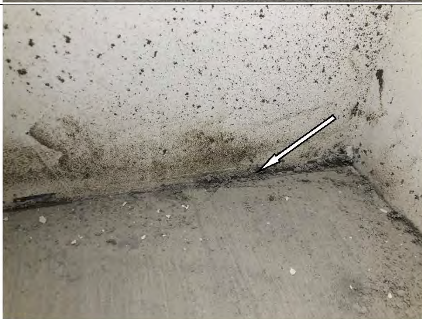
Фото №27. Не выполнен изолирующий шов в местах примыкания стен гардеробной и стяжки пола.
