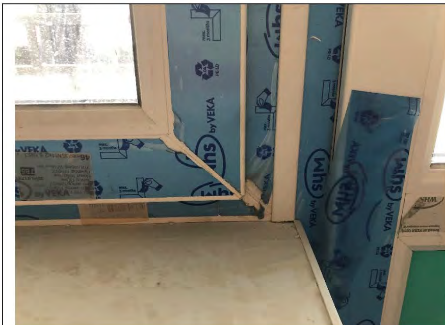
Фото №31. Не удалена защитная пленка с лицевой поверхности профилей оконного и дверного блока на кухне.
