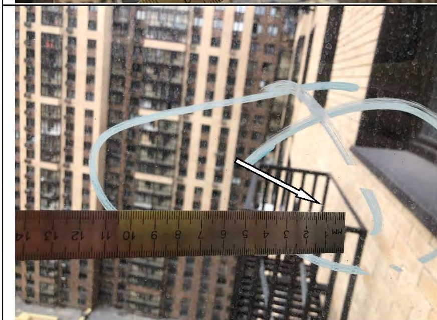
Фото №41. На стеклопакете оконного блока ПВХ на балконе имеется дефект (царапина).
