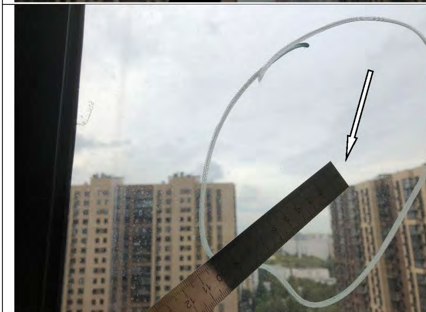
Фото №39. На стеклопакете оконного блока ПВХ на балконе имеется дефект (окалины).
