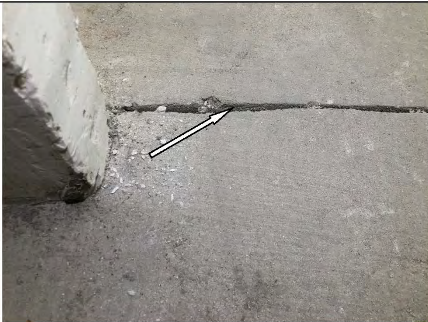
Фото №23. Швы готовой стяжки пола в гардеробной выполнены неверно.
