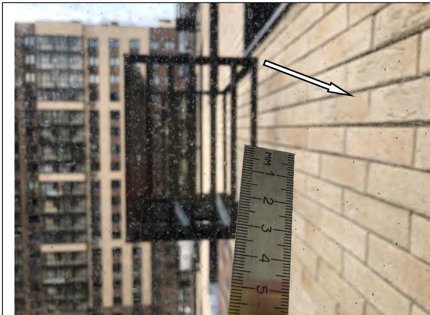
Фото №37. На стеклопакете оконного блока ПВХ на балконе имеется дефект (окалины).
