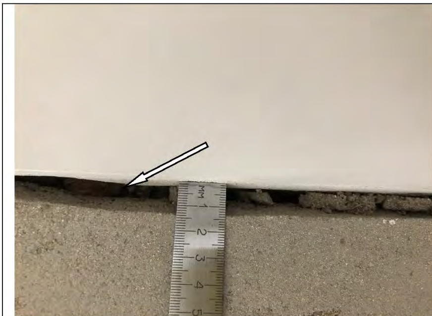
Фото №28. Отсутствие изолирующего материала в изолирующих швах в местах примыкания стен кухни и стяжки пола.
