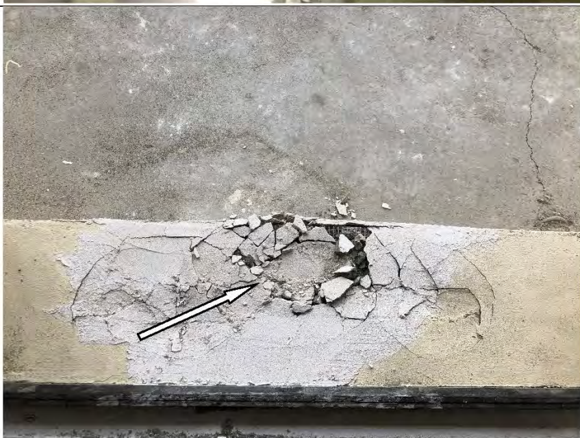
Фото №45. Сколы и трещины в конструкции порога пола балкона.
