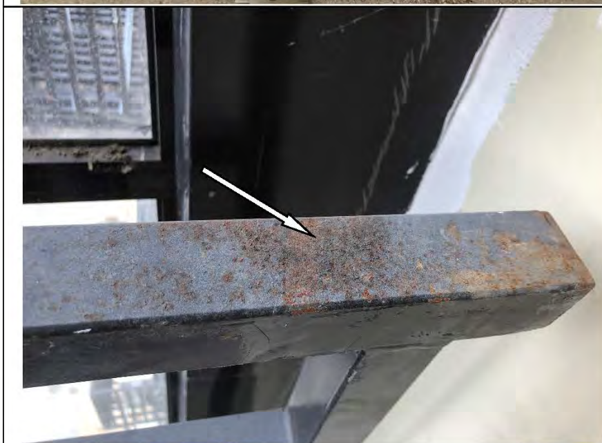
Фото №29. Поверхностная коррозия металлического профиля ограждающей конструкции на балконе.
