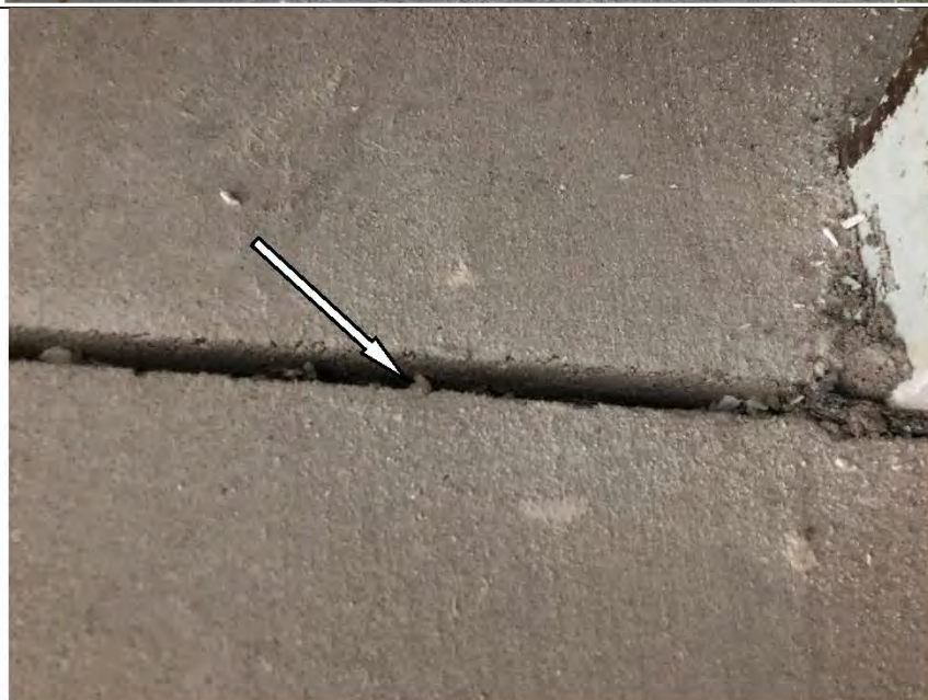
Фото №24. Швы готовой стяжки пола в санузле выполнены неверно.
