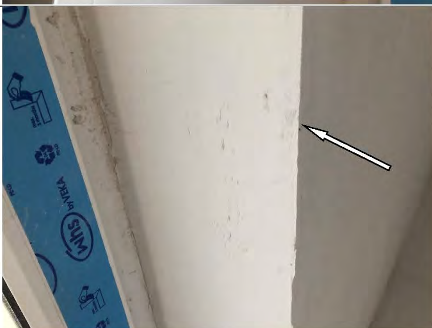
Фото №15. Неровность очертания шпаклеванных поверхностей оконных откосов в кухне.
