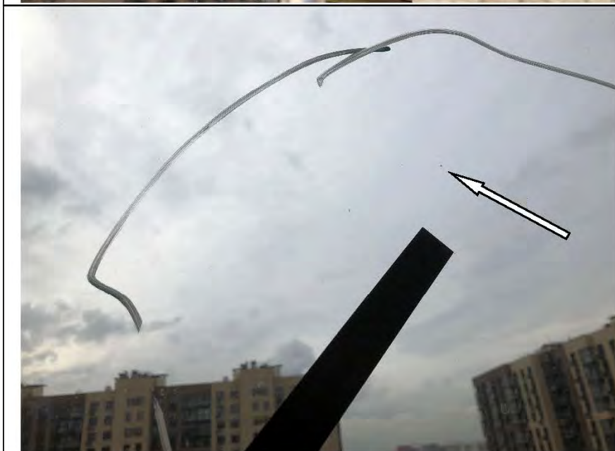
Фото №38. На стеклопакете оконного блока ПВХ на балконе имеется дефект (окалины).
