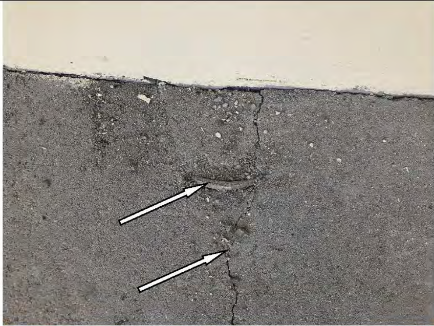
Фото №46. Трещины в стяжке пола балкона, не удалена строповочная петля железобетонной плиты на балконе.
