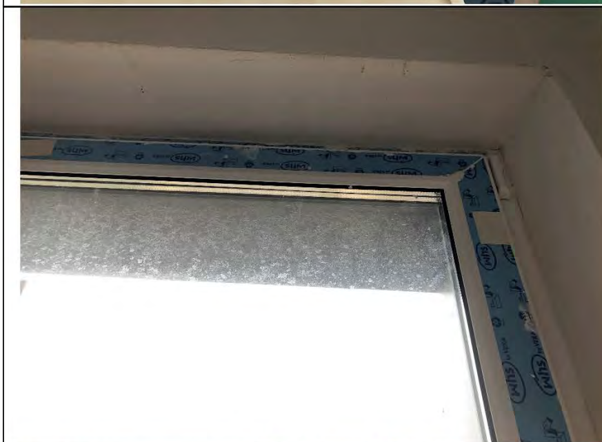
Фото №32. Не удалена защитная пленка с лицевой поверхности профилей оконного и дверного блока в спальне.
