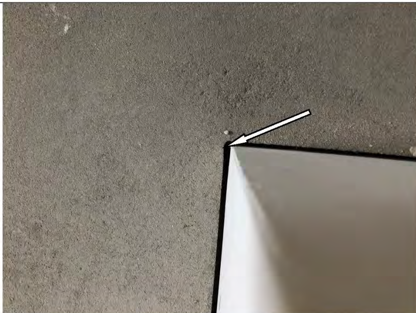
Фото №25. Отсутствие изолирующего материала в изолирующих швах в местах примыкания стен спальни и стяжки пола.
